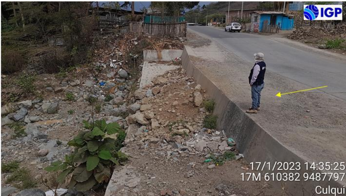
Figura 30.- Badén situado en la vía Paimas – Culqui que se encuentra colmatado por materiales antrópicos (desmonte)
