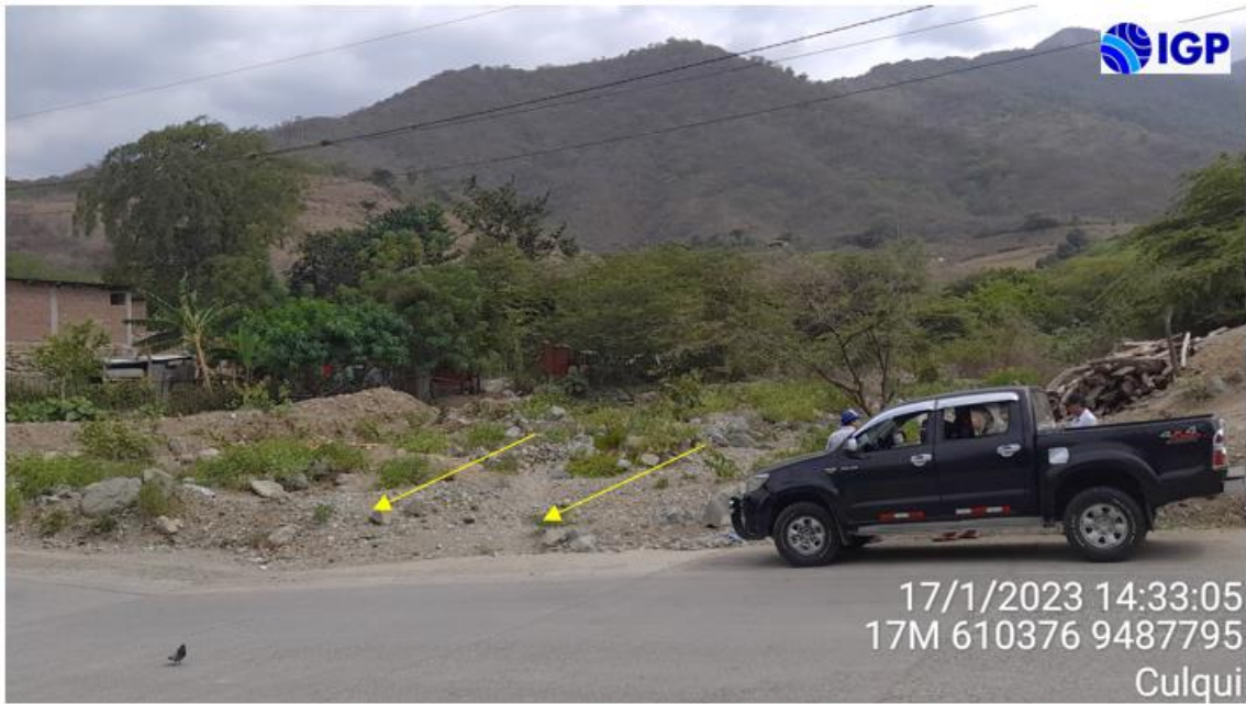
Figura 29.- Cauce de la quebrada Culqui (flechas amarillas) susceptible a la ocurrencia de flujos de detritos ante el incremento de las precipitaciones pluviales que podría afectar el badén de la vía Paimas – Culqui
