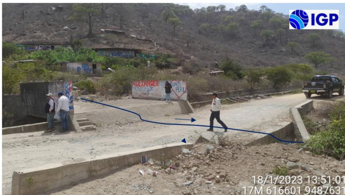
Figura 27.- Cauce de la quebrada Algodonal que discurre sobre el canal del río Quiroz, cuyos flujos podrían afectar vía de acceso situada en este lugar (400 m al noreste de Algodonal)
