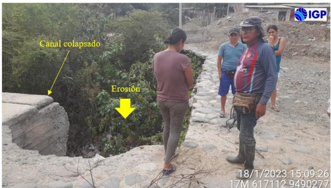
Figura 23.- La activación de la quebrada La Chorrera ha generado erosión en los suelos que conforman la base del canal de irrigación Jambur, generando su colapso parcial y afectación de terrenos de cultivo
