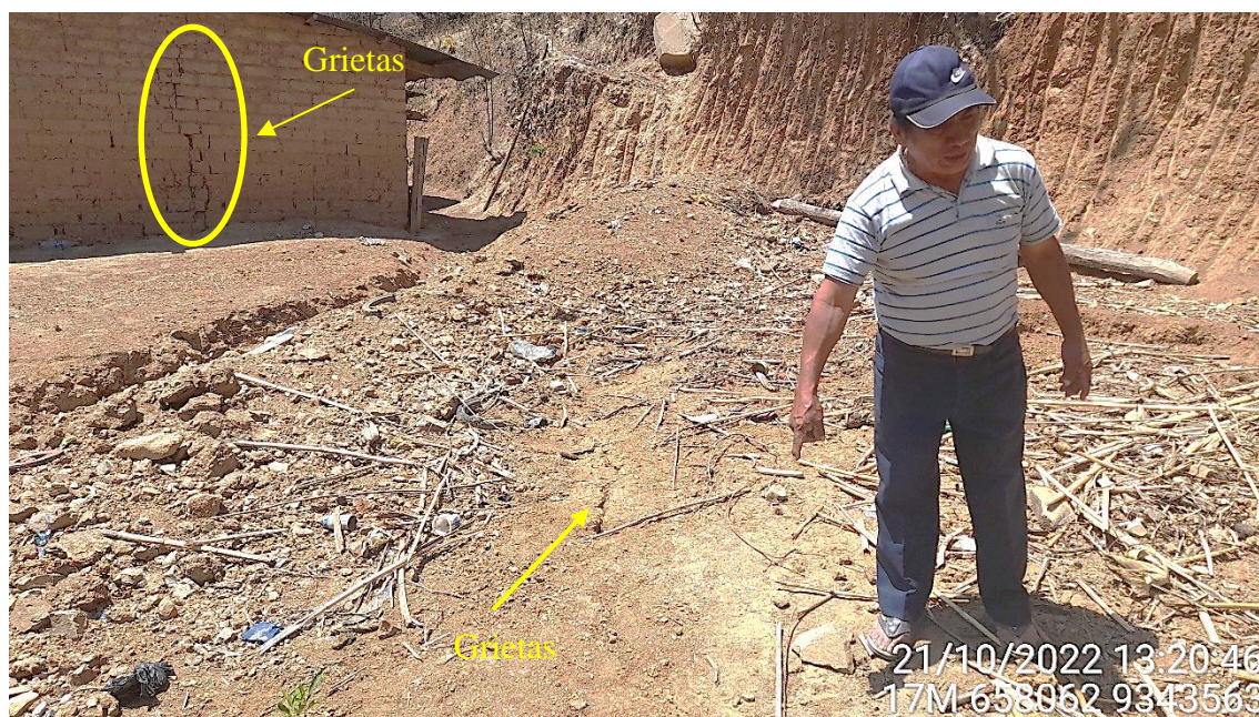
Figura 11.- Grietas generadas en el suelo y pared de vivienda conformada por adobe, ambas presentan anchos comprendidos entre 1 y 3 cm, de acuerdo con el testimonio de los pobladores ocurrieron posterior al sismo del 26 de setiembre
