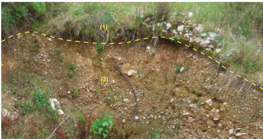
Figura 16. Se aprecia el suelo (1), conformado por restos orgánicos (raíces) en la parte superficial se aprecia fragmentos de gravas sueltas. El material proveniente del deslizamiento (2), esta conformados por bloques, gravas, gravilla y arcilla-limo.
