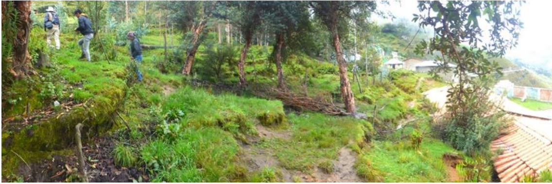
Fotografía 6. Se aprecia la parte colindante al centro educativo inicial, árboles inclinados, como también saltos en el terreno que muestra la inestabilidad del lugar.
