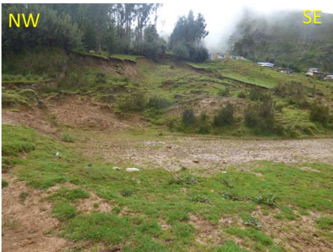
Figura 12. Se aprecia el deslizamiento que se formó por el corte de talud para la construcción de loza deportiva. (278280E, 8952673N).
