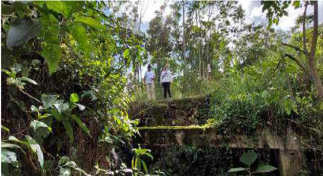
Foto 1. Se aprecia colmatación y vegetación densa en ambas margenes de la ribera (puente del sector Ramos)
