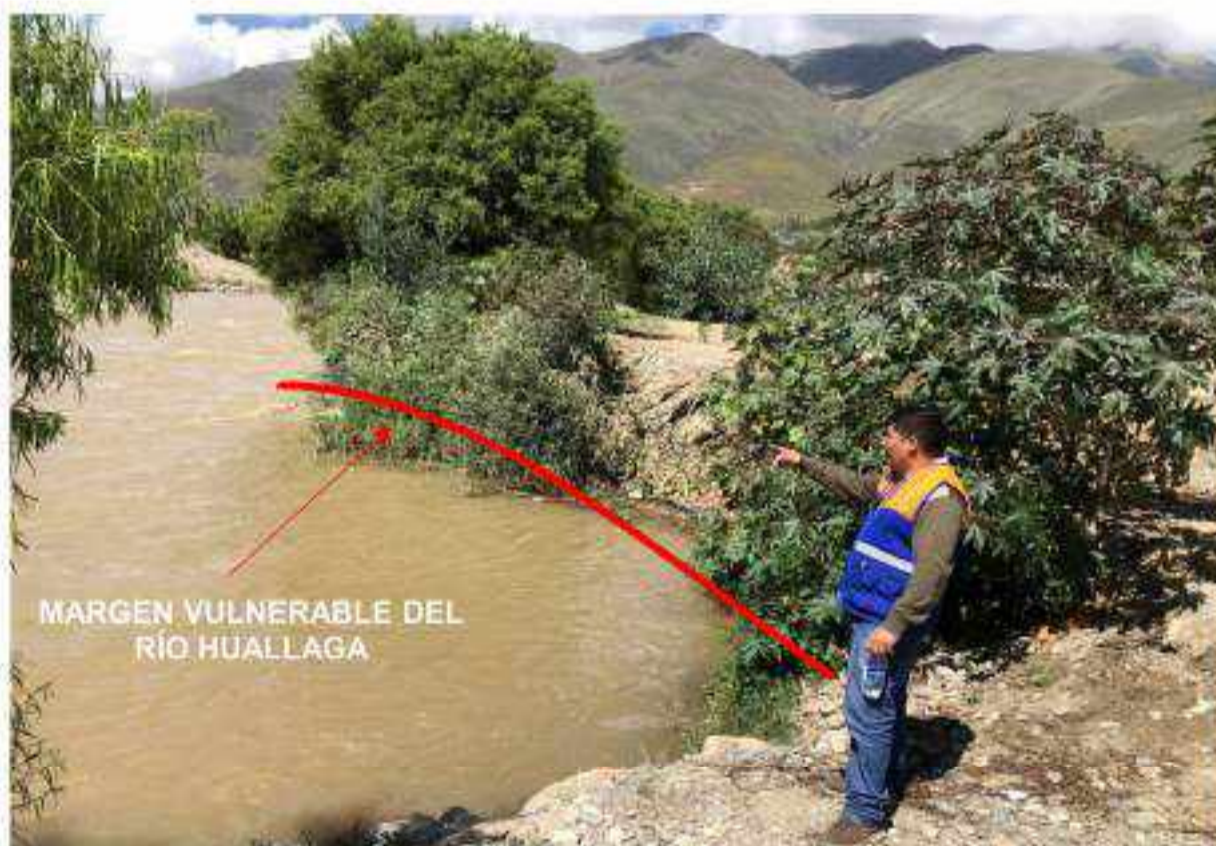
FIGURA N°01: TRAMO CRÍTICO EN EL RIO HUALLAGA, EN EL SECTOR PITUMAMA, DISTRITO DE PILLCO MARCA, PROVINCIA DE HUANUCO - HUANUCO
