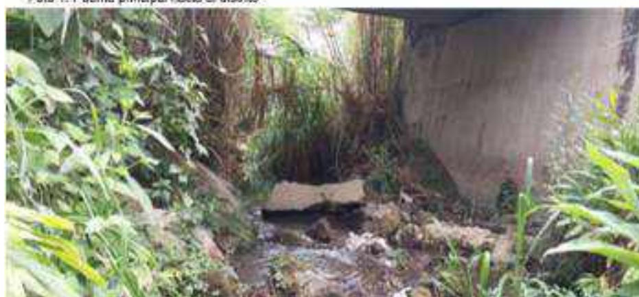
Foto 2. Parte inferior colmatada del puente principal.
