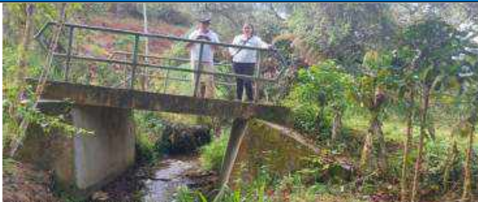
Foto 1. Se aprecia colmatación en ambos márgenes de la ribera.
