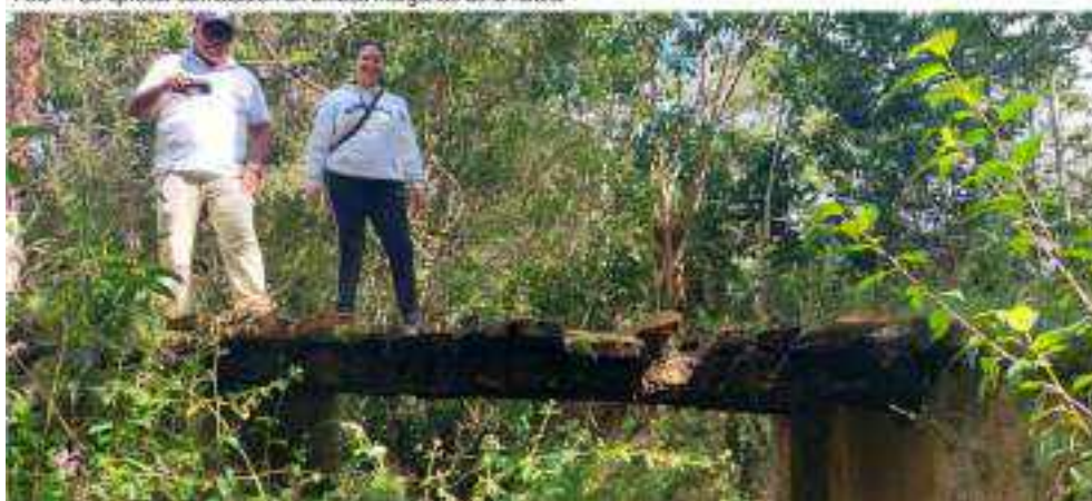
Foto 2. Puente peatonal en mal estado debido a que se encuentra colmatada la quebrada.
