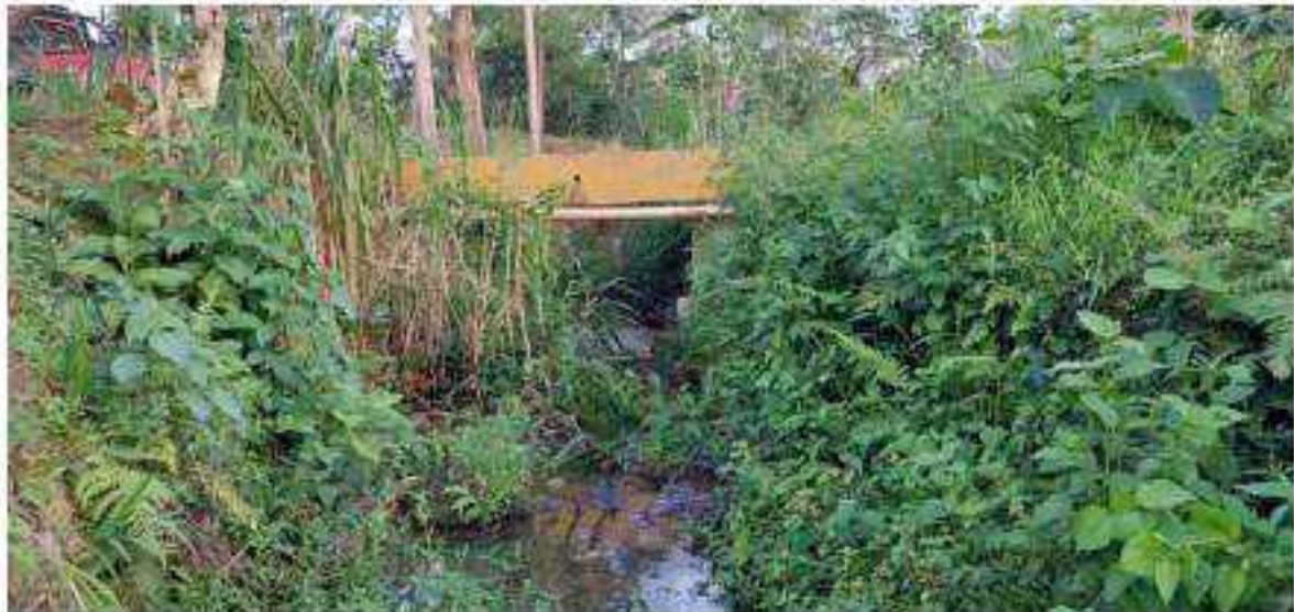
Foto 2. Parte inferior donde se aprecia colmatación de malezas.
