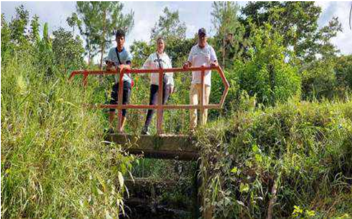
Foto 2. Se aprecia colmatación y vegetación densa en ambas margenes de la ribera (puente del sector Calzada)
