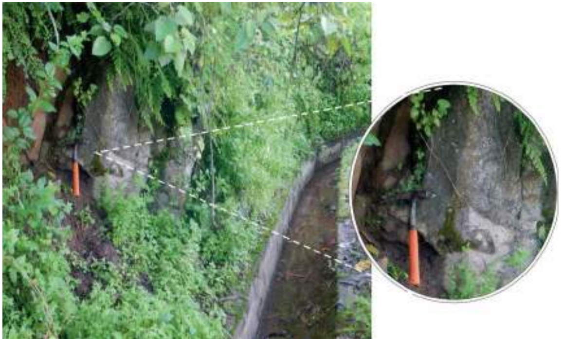
Figura 6. Vista de andesitas de color gris de la Formación Calipuy, ubicado a un costado del canal Callanca, ubicado entre las coordenadas UTM 8742804 N, 304280 E.
