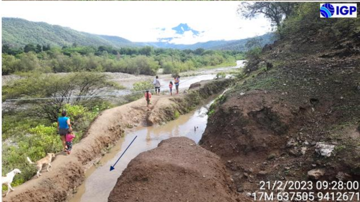
Figura 19.- Erosión fluvial en el margen izquierdo del río Bigote. En la imagen superior se evidencia la erosión del pie del talud situado en Manzanares debido a la dinámica del río Bigote, dicho talud presenta desnivel topográfico superior de 10 – 12 m respecto al cauce del río y en la imagen inferior se evidencia el canal sobre el talud expuesto a colapsos como consecuencia de la erosión fluvial.
