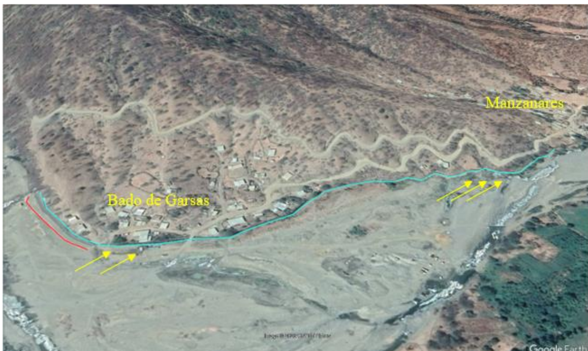
Figura 18.- Canal de irrigación Manzanares (línea celeste) ubicado entre los poblados Bado de Garsas y Manzanares asentado sobre una loma conformada por rocas del tipo filitas meteorizadas que presentan susceptibilidad alta a la ocurrencia de erosión fluvial (flechas amarillas principalmente) en su base (pie) y por tanto la infraestructura se encuentra expuesta a colapsos
