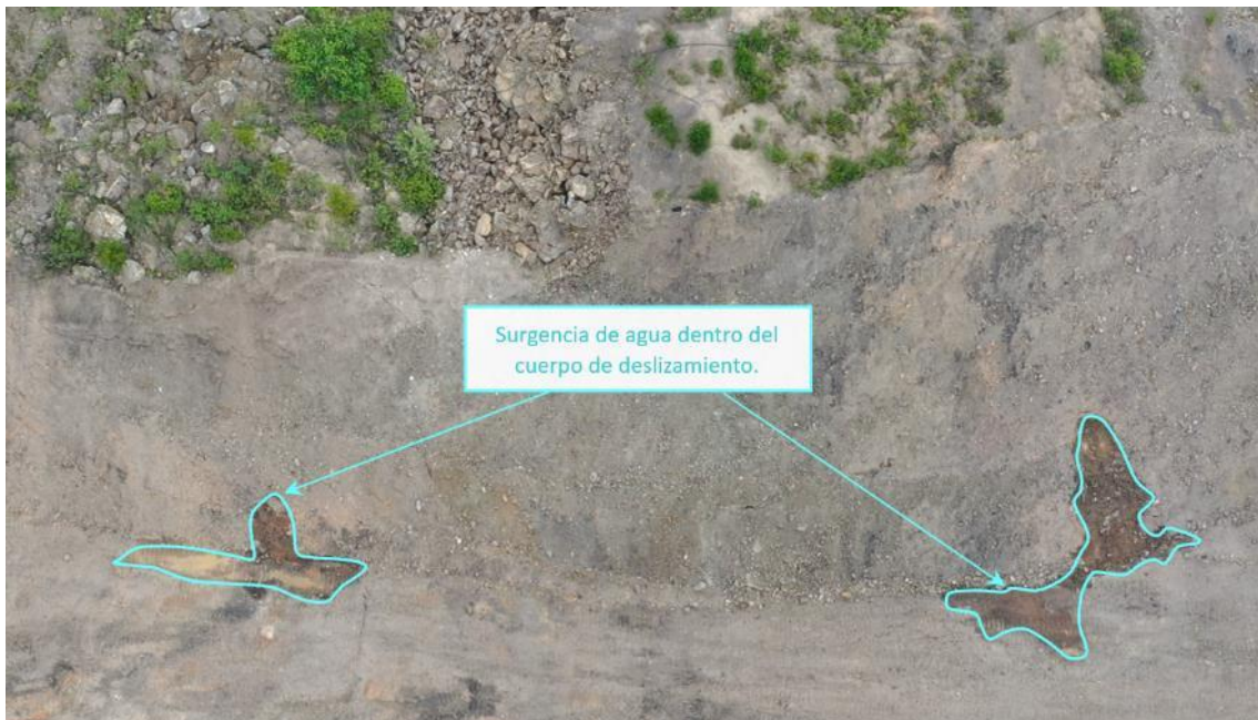
Figura 18. Surgencia de agua en la parte baja del cuerpo del deslizamiento. Coordenadas UTM WS-84 -17S, Norte: 9374132 – Este: 686467.
