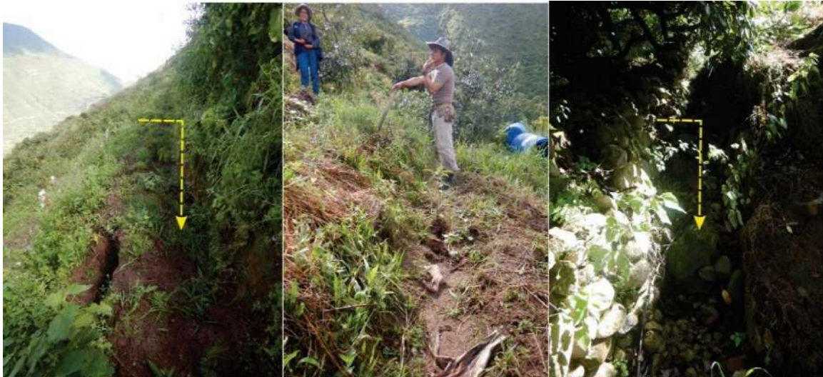
Figura 23. Canal de riego sin revestimiento, el cual está aportando con la saturación del suelo, en ambos márgenes de este canal se evidencio la presencia de grietas; las cuales pasan desapercibidas debido a la vegetación.
