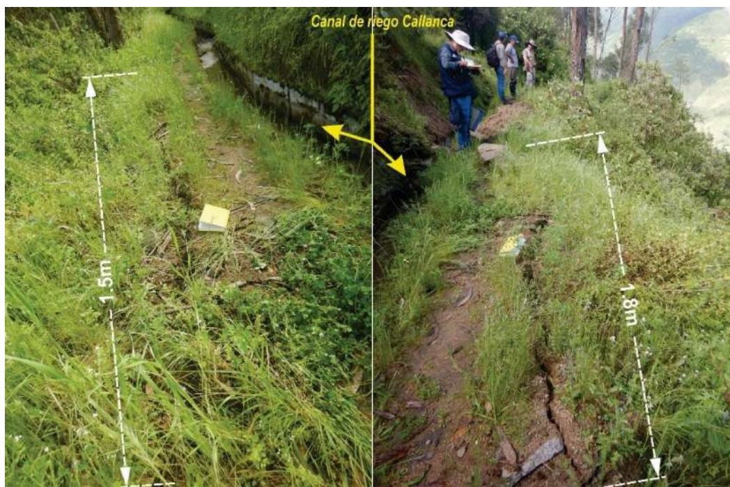
Figura 24. Vista de agrietamientos, próximos al canal Callanca, ubicado entre las coordenadas UTM 8742708 N, 304277 E.
