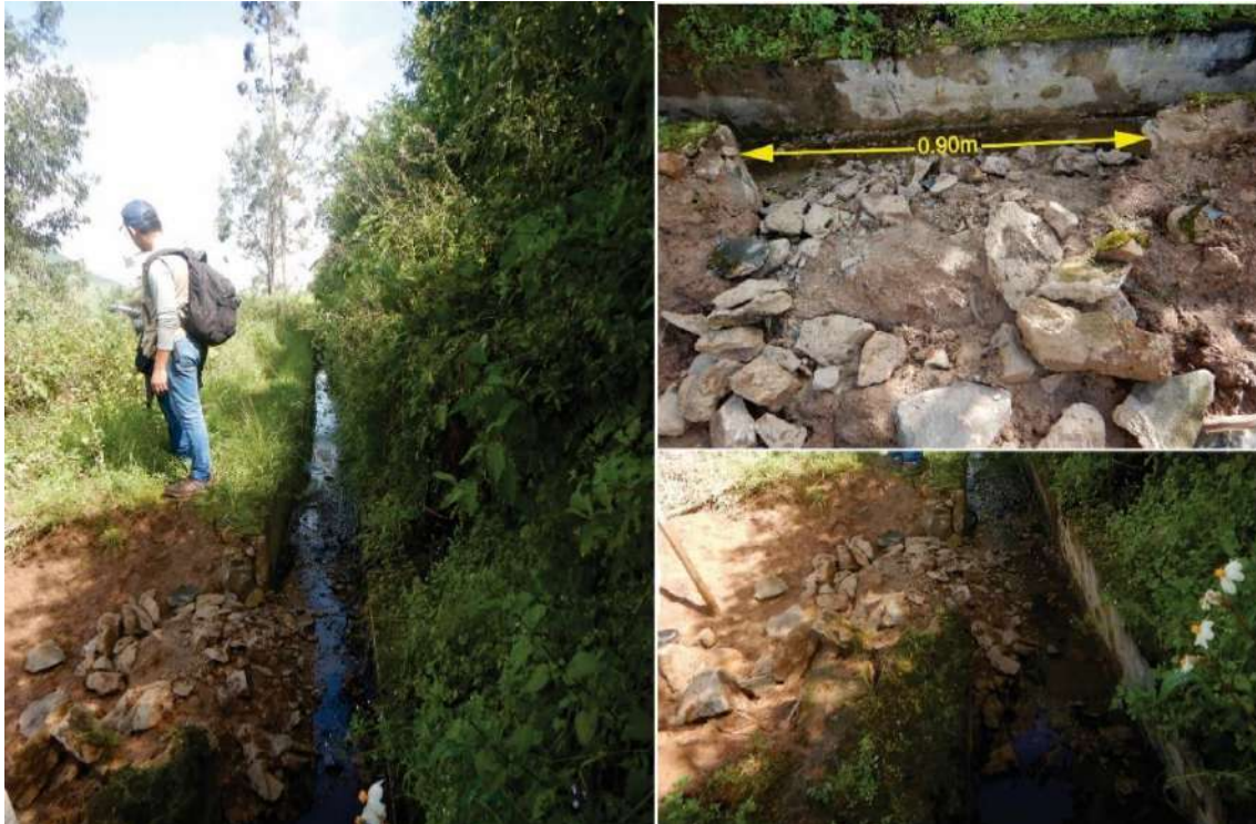
Figura 21. Canal de riego presenta deterioro en un tramo de 0.90 m lo cual permite que el agua discorra aguas abajo, ubicado entre las coordenadas UTM 8742860 N, 304013 E con una altitud de 2527 m s n.m.
