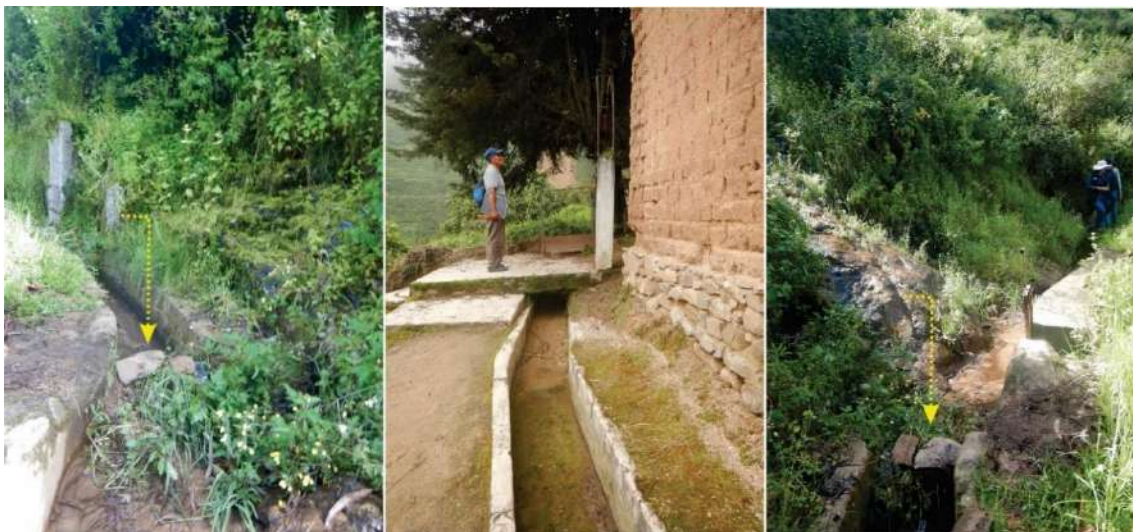
Figura 22. Vista de canales Callanca y Alta, se observa que están obstruidos, producto de la acumulación de material caído (vegetación y suelo), el cual en muchas oportunidades generan desborde de dicho canal, lo cual ayuda con la saturación de suelo.
