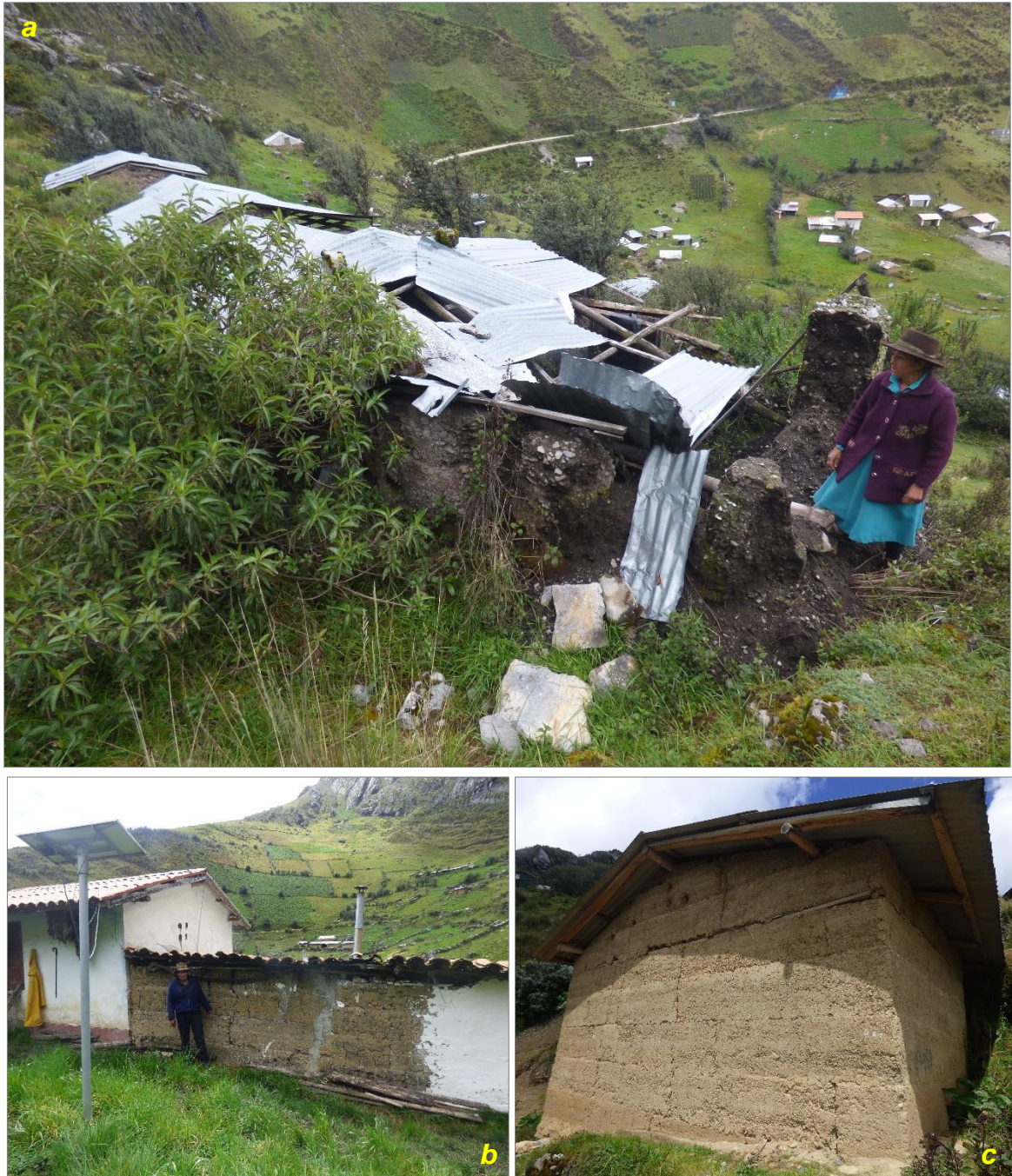
Figura 12. a) Vista de viviendas afectadas por caída de rocas de la ladera suroeste. b y c) Viviendas con paredes agrietadas del sector Chipta.
