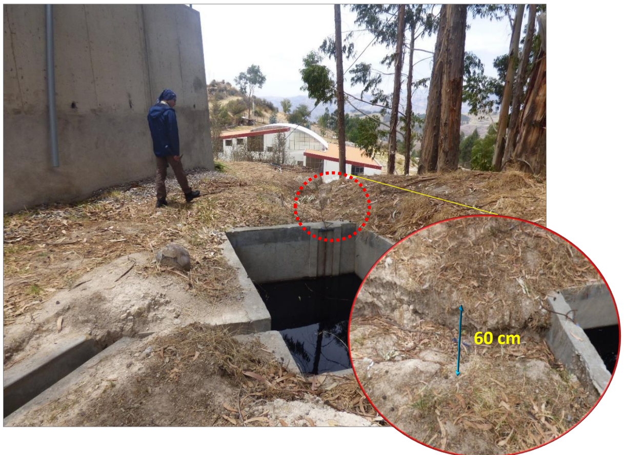
Figura 11. Formación de carcavamiento, a partir de la erosión que genera el agua de escorrentía pluvial.
