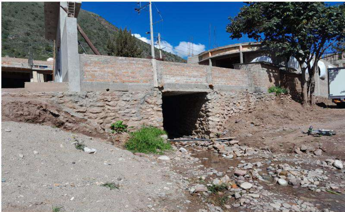
FIGURA N°02: EL C. P. MISKIBAMBA SE ENCUENTRA CON INVASION DE VIVIENDAS EL CAUCE DE LA QUEBRADA HUAMAN HUAYCCO
