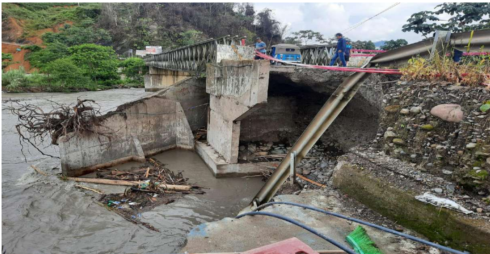
FIGURA N°01: VISTA DE AFECTACIÓN DE LA BASE DEL PUENTE TINCUY POR CRECIDA DEL RÍO TINCUY
