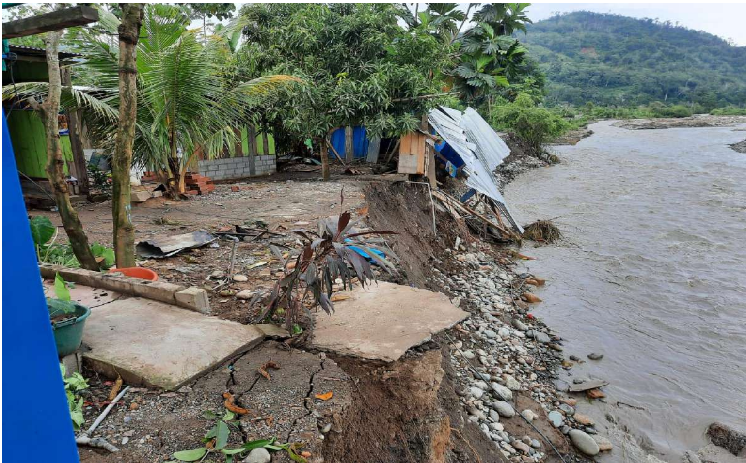
FIGURA N°02: VISTA DE TALUDES EN ORILLAS DEL RÍO TINCUY QUE FUERON AFECTADOS POR LA EROSIÓN DEL RÍO TINCUY. PRODCUTO DE ELLO SE AFECTARON VARIAS VIVIENDAS CERCANAS A LA RIBERA
