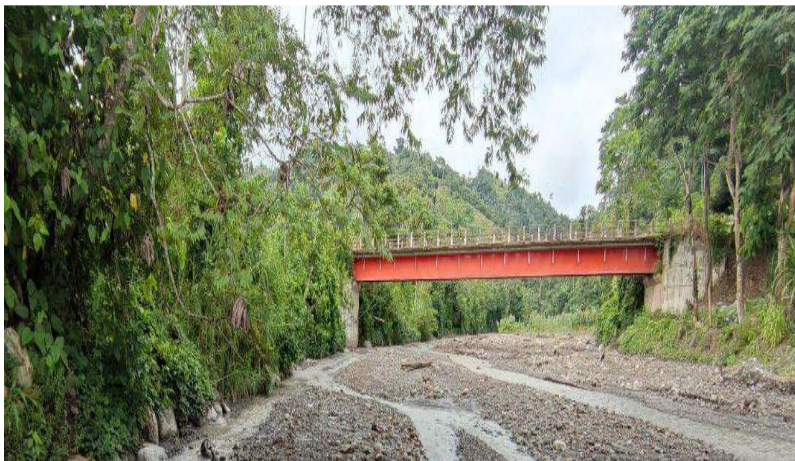
FIGURA N°03: VISTA DEL PUENTE SABOGATO, ANTECEDENTES DE AFECTACIÓN DE BASES EN LAS AVENIDAS DEL PERIODO 2022-2023
