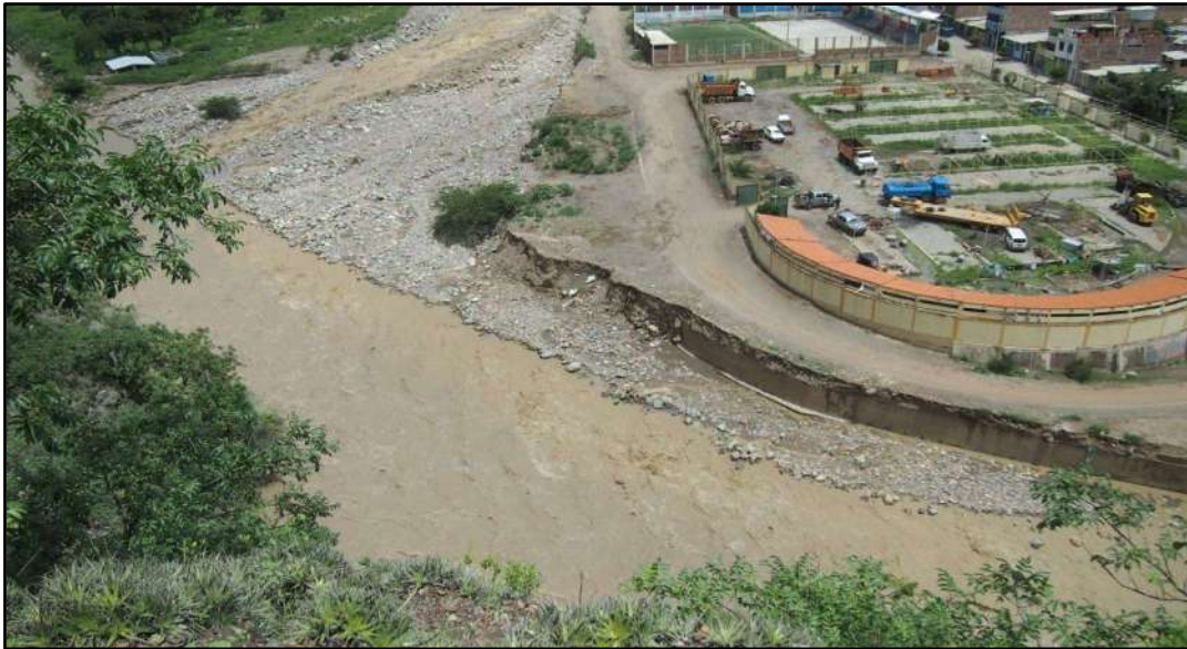
FIGURA N°03: CHILETE EN PELIGRO EN TEMPORADA DE MAXIMAS AVENIDAS, EL RÍO HUERTAS EN ESTE TRAMO DEL MERCADO INTERPROVINCIAL.
