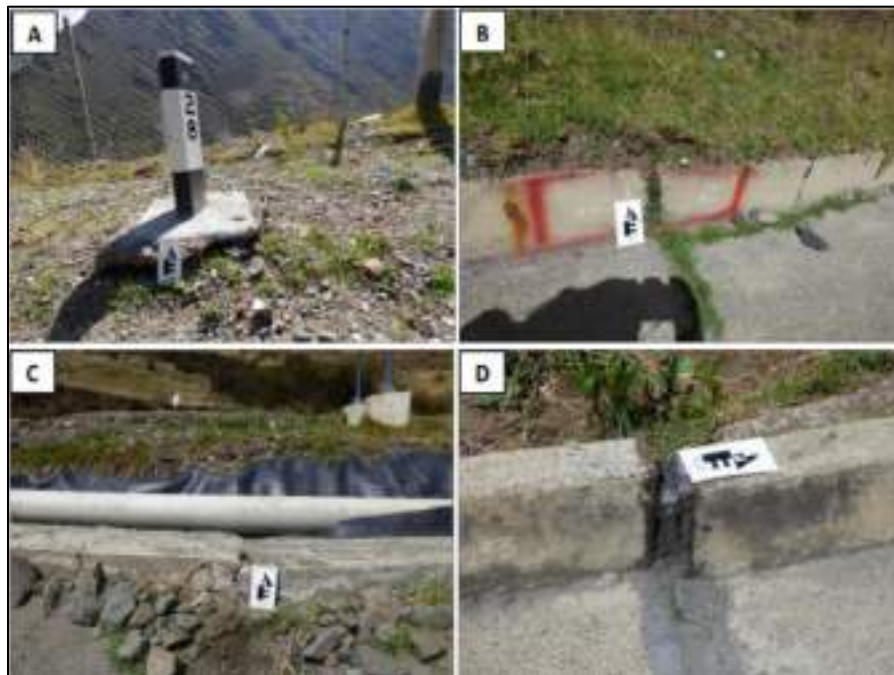
Ilustración 22. Evidencias de la reactivación del deslizamiento en el Km. 28+000.
