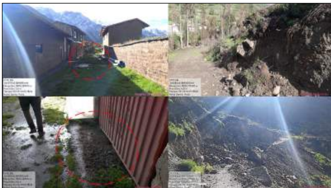
Ilustración 54. Áreas afectadas por las lluvias intensas (viviendas, calles, caminos de herradura).
