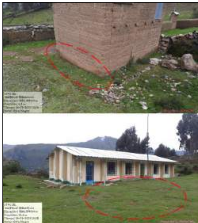
Ilustración 60. Viviendas afectadas por las lluvias intensas e institución educativa.
