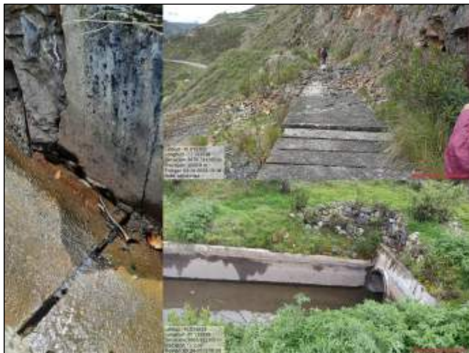
Ilustración 25. Agrietamiento y deterioro del canal de aducción de la hidroeléctrica Pacarenca.
