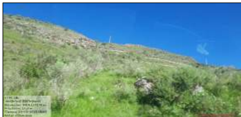
Ilustración 36. Zona de deslizamiento bajo el talud de la carretera Conococha – Dv. Mojón – Aquia.
