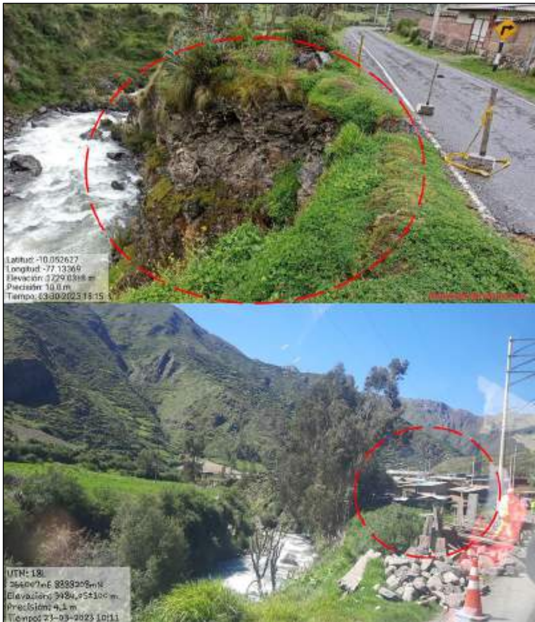
Ilustración 50. Debilitamiento del talud de la carretera y viviendas expuestas en el sector Pacarencia.
