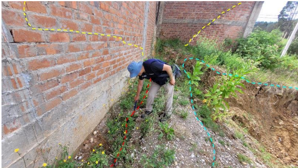
Figura 11. Agrietamiento de tracción en la parte posterior de la corona del deslizamiento DRA2 (en línea roja) que ha afectado una vivienda (fracturas estructurales en amarillo), además un sector de erosión demarcado en línea celeste. Coordenadas: E: 181979; N: 9309265; Z: 2293.
