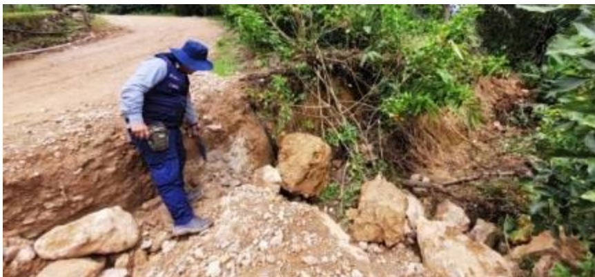
Figura 18. Salto vertical del escarpe del deslizamiento DRA4. Coordenadas: E: 182907; N: 9308843; Z: 2402.
