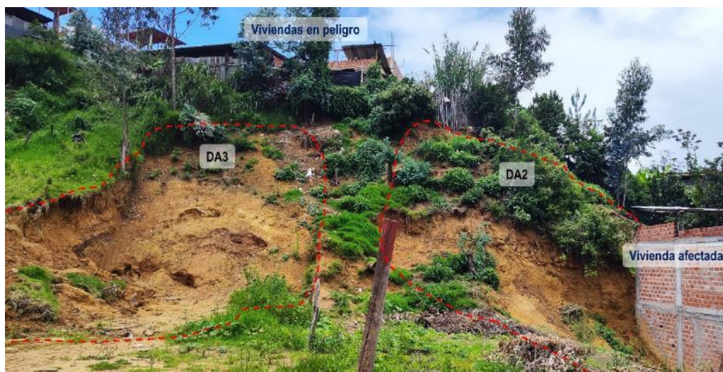
Figura 26. Vista de los derrumbes activos 2 y 3. Coordenadas: E: 182833; N: 9309977; Z: 2385.
