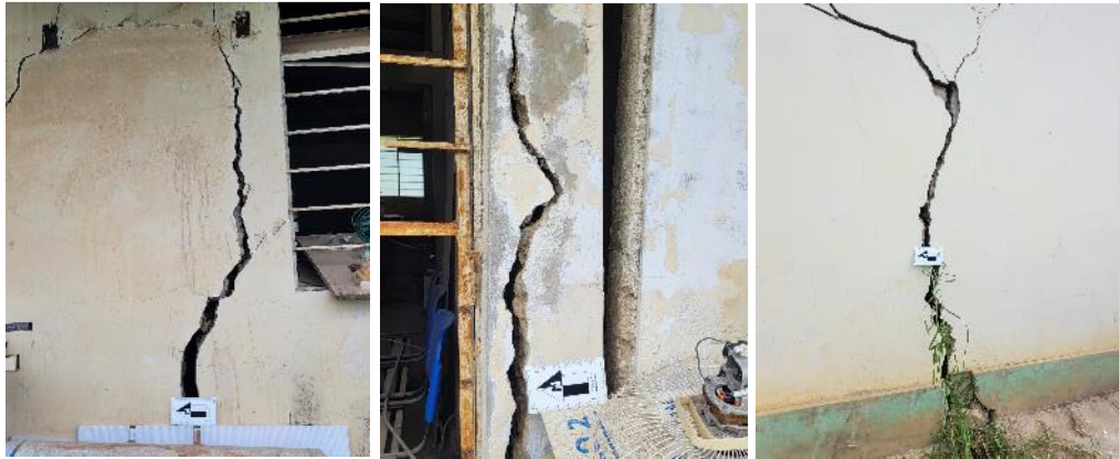
Fotografía 10. Muestra de agrietamientos en paredes del establecimiento de salud afectado por reptación de suelos.
