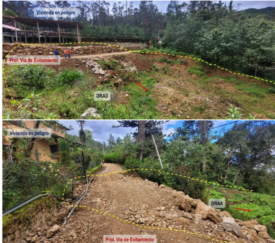
Figura 15. Vista de los deslizamientos DRA3 (arriba, coordenadas E: 182895; N: 9308919); DRA 4 (abajo, Coordenadas E: 182918; N: 9308857).
