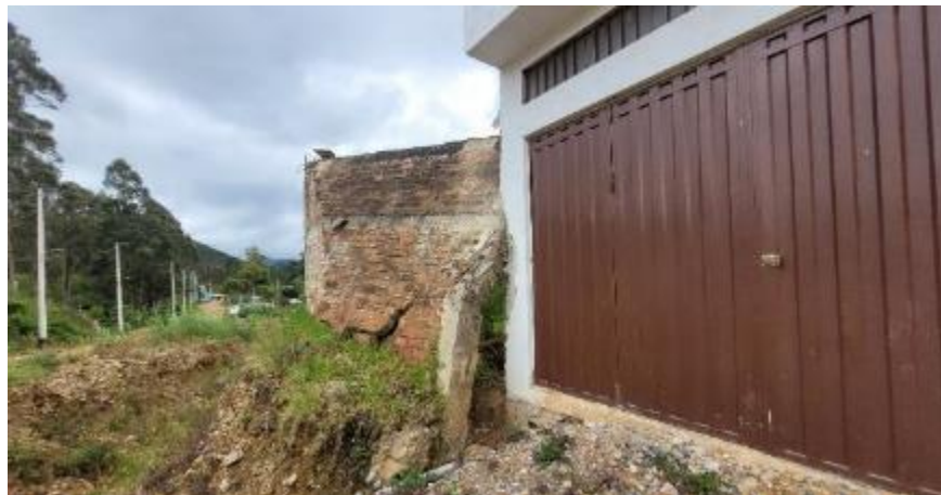
Fotografía 6. Muro colapsado de la vivienda afectada por el deslizamiento rotacional activo 2. Coordenadas: E: 181984; N: 9309266; Z: 2293.
