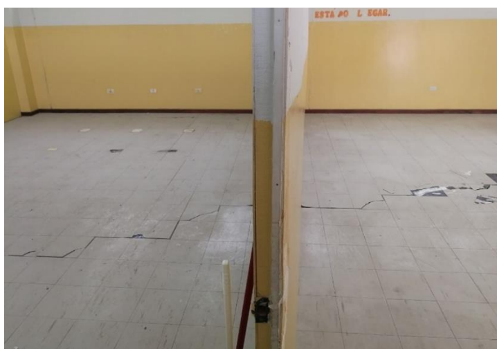
Fotografía N° 12: La rajadura del piso continua en la misma dirección pasando por más ambientes continuos.
