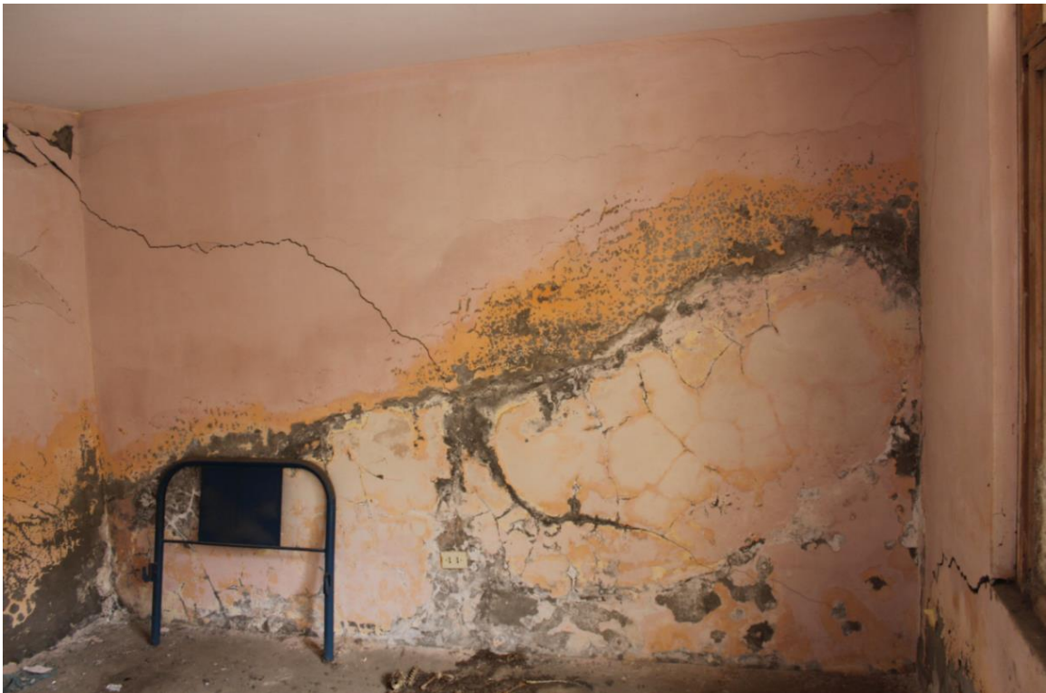
Fotografía N° 07: En otra habitación continua, se observa con más intensidad la presencia de la humedad, las rajaduras y agrietamientos continúan.
