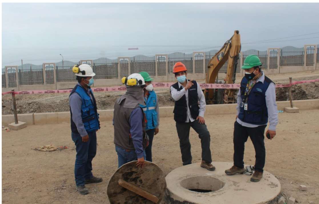
Fotografía N° 31: Visita a una obra en el sector Parque de la Familia, donde los brotes de agua se llegaron a canalizar a los sumideros principales de la ciudad.
