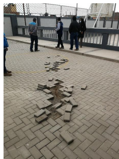
Fotografía N° 09: En un patio se observa un lineamiento de Norte a Sur, agrietado de poca abertura que removió el adoquinado de la losa.
