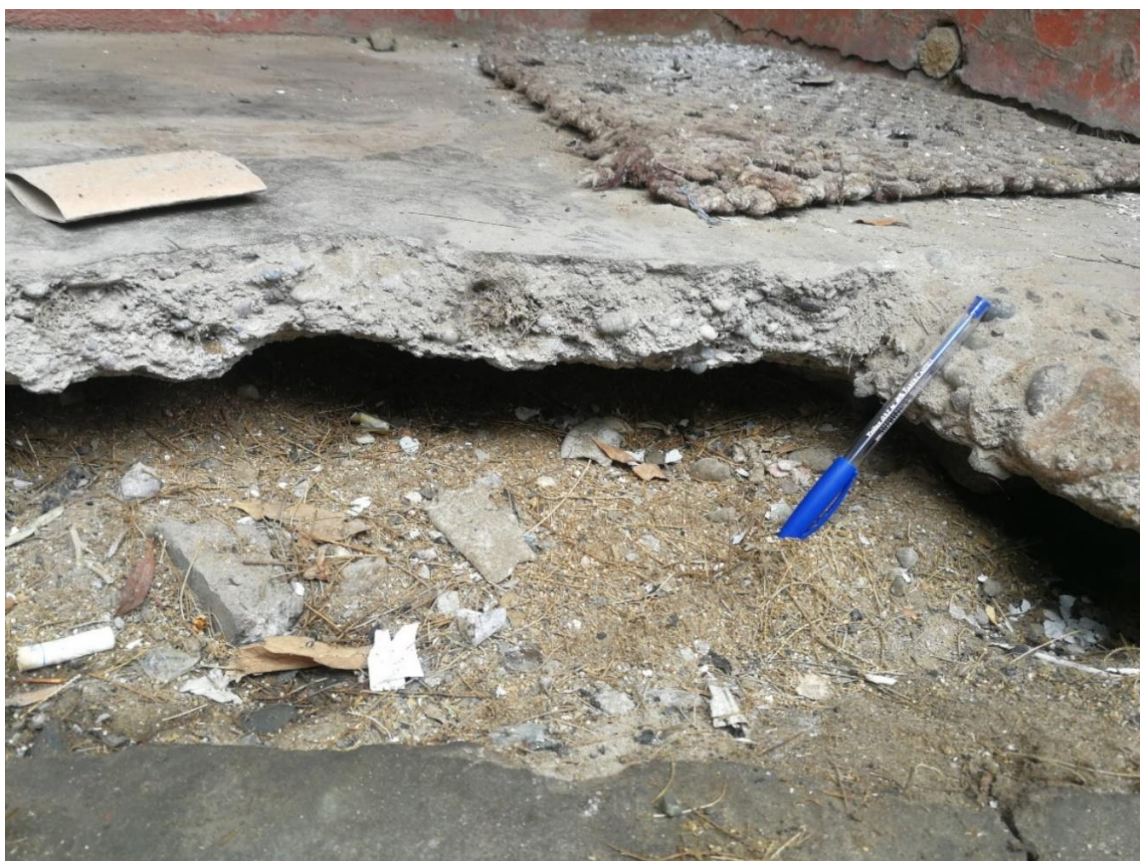
Fotografía N° 05: En el ingreso por la puerta principal, se evidencia este ligero hundimiento del suelo que se desprende del vaciado de concreto del piso.
