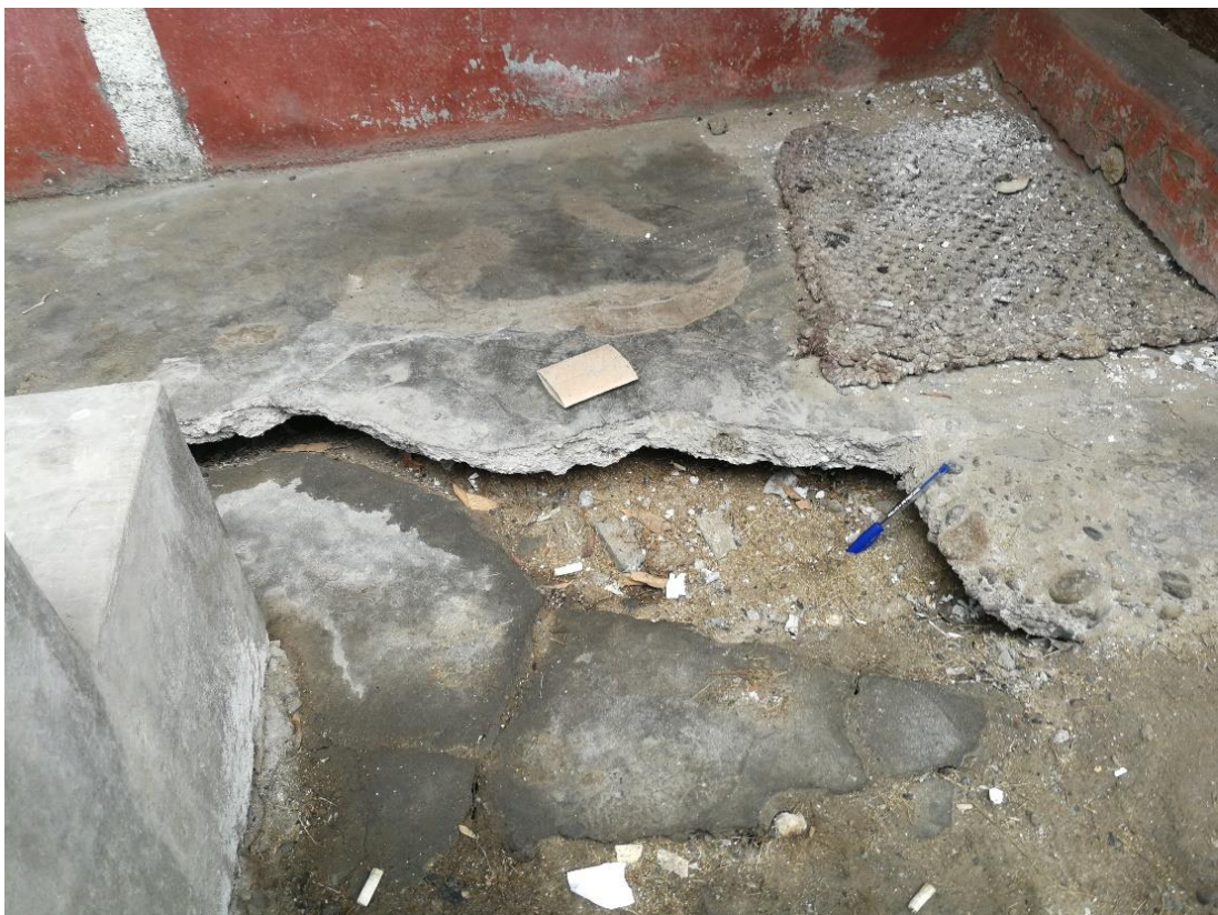
Fotografía N° 33: En el ingreso por la puerta principal, se evidencia este hundimiento del suelo que se desprende del vaciado de concreto del piso.
