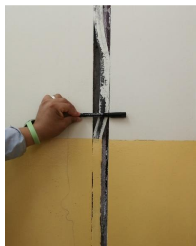
Fotografía N° 13: Se observo que, en algunas uniones de las paredes, se llegaron abrir.
