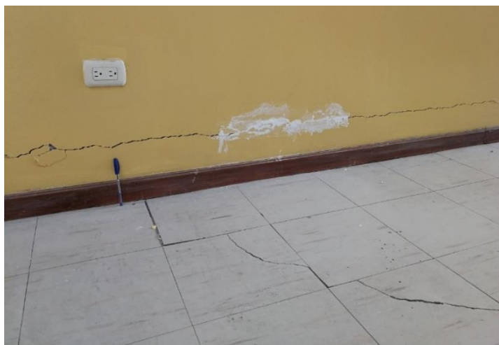
Fotografía N° 10: Este alineamiento sigue en la misma dirección pasando por los salones de clases, se observa rajaduras en el piso y en las paredes.
