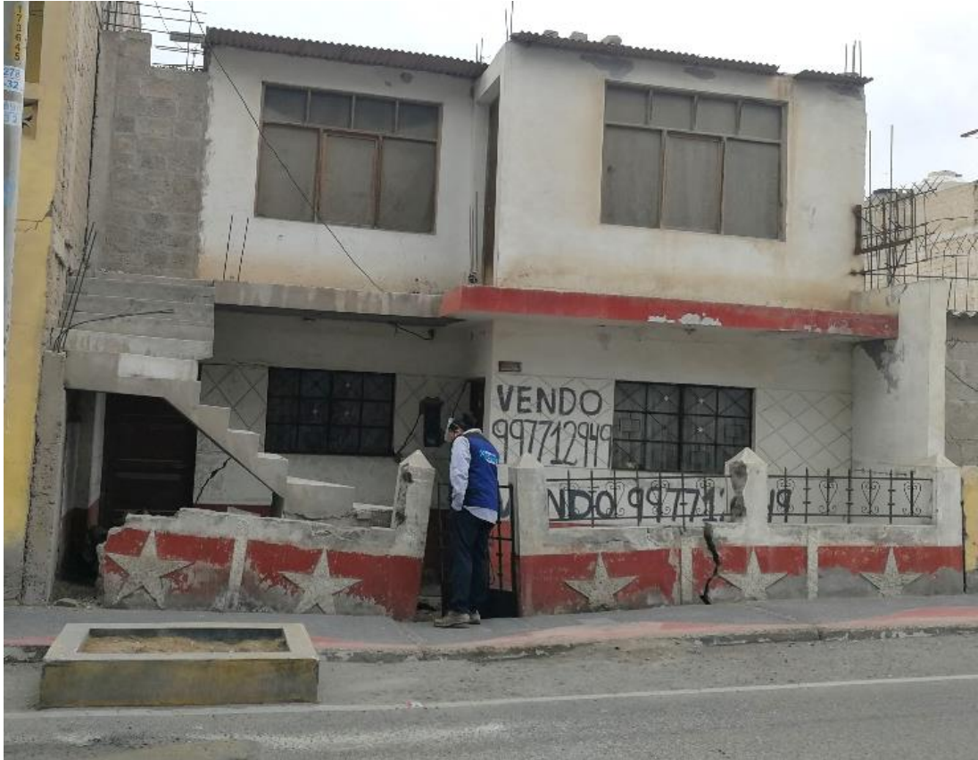
Fotografía N° 32: Casa afectada por un hundimiento en la entrada principal.
