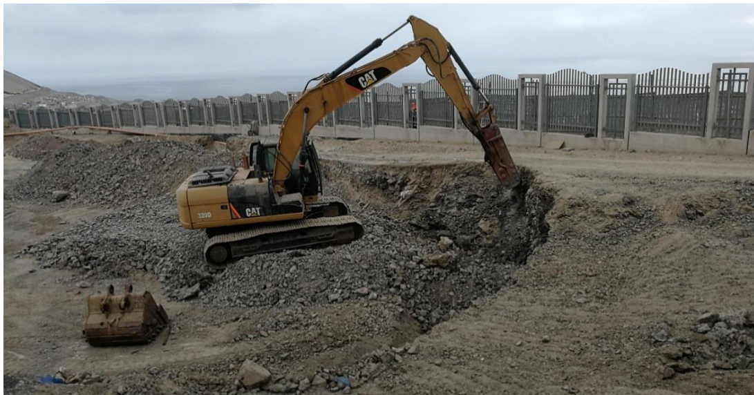
Fotografía N° 39: Durante las excavaciones de la obra, en la zona Parque de la Familia, se evidenciaron manifestaciones de agua.
