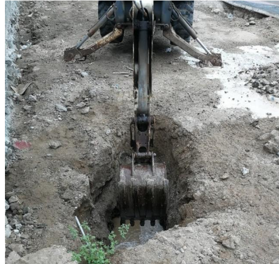
Fotografía N° 43: Evidencia del nivel freático a poca profundidad
