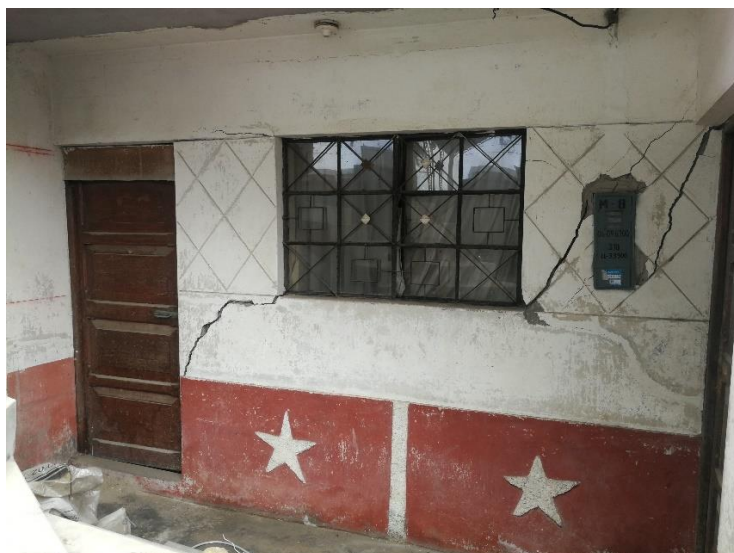
Fotografía N° 03: Detalle de las grietas en la fachada principal de la vivienda afectada.
