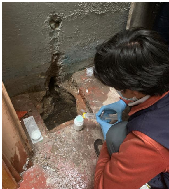
Fotografías N° 34: En el primer nivel de la casa del Sr. Ortiz, el agua emerge del suelo como generando un ducto natural, con poco caudal ( < 1 L/s), pero generando bastante humedad.
