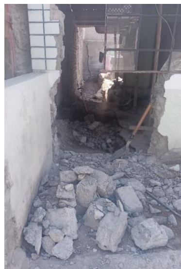
Fotografía N° 04: En el interior, están remodelando por la intensa humedad y deterioro de la vivienda.
