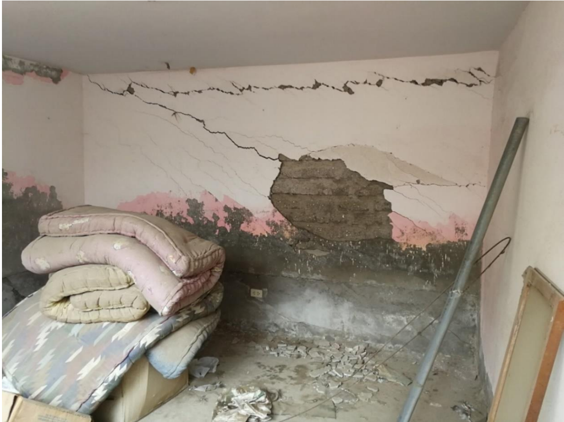
Fotografía N° 06: En la habitación interior se observa rajaduras y la intensa humedad en las paredes que asciende desde el piso; se observa también el daño del desprendimiento del terraje de la pared.
