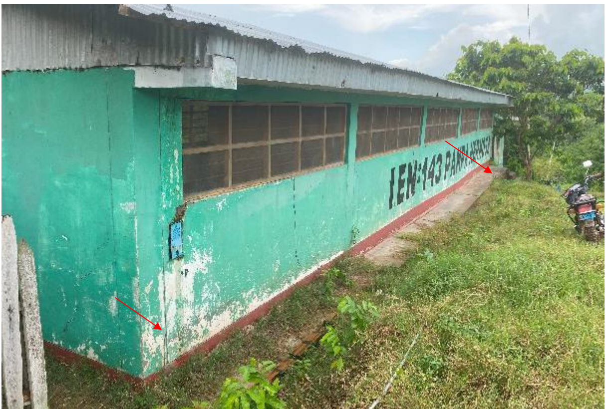
Figura 22. IE N°43 Pampa Hermosa, con fisuras en paredes, declarada inhabitable.
