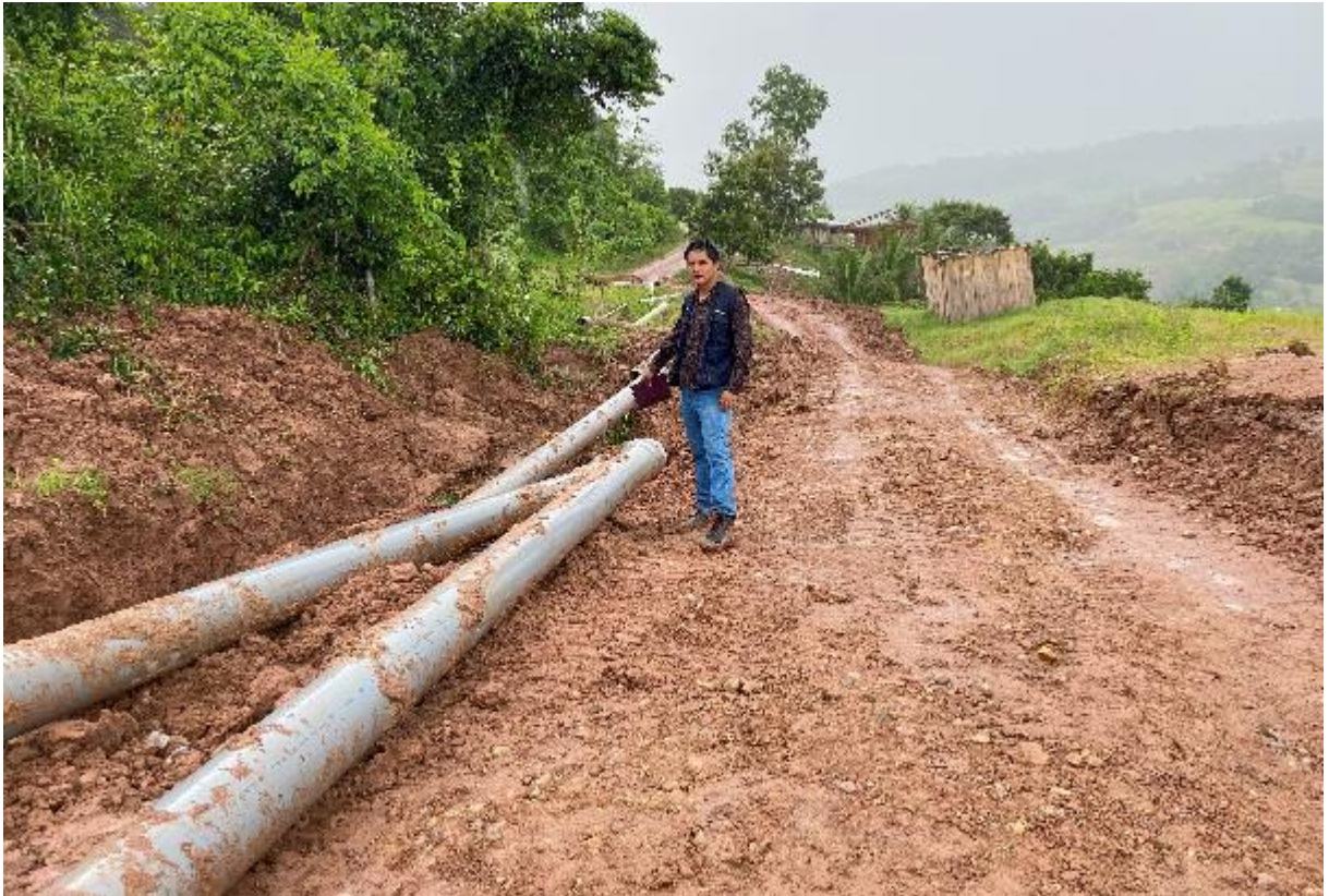
Figura 21. Tubería matriz de agua potable del valle del Ponacillo.
