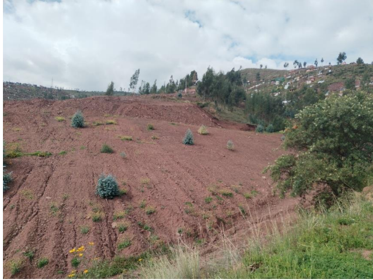
Foto 12: Rellenos y material removido en la parte baja del sector San Isidro Labrador.
