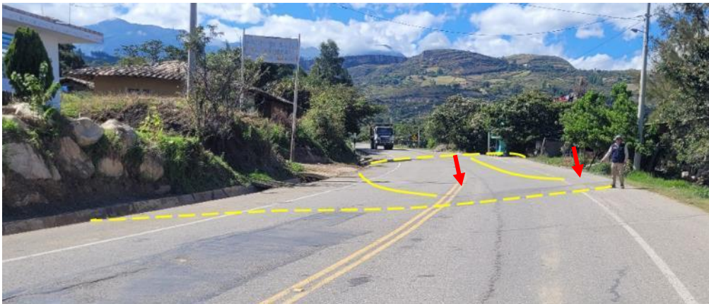
Figura 16. Asentamiento (línea discontinua amarilla), en la carretera Cajamarca – Cajabamba. Coordenadas: E: 820088, N: 9158553.
