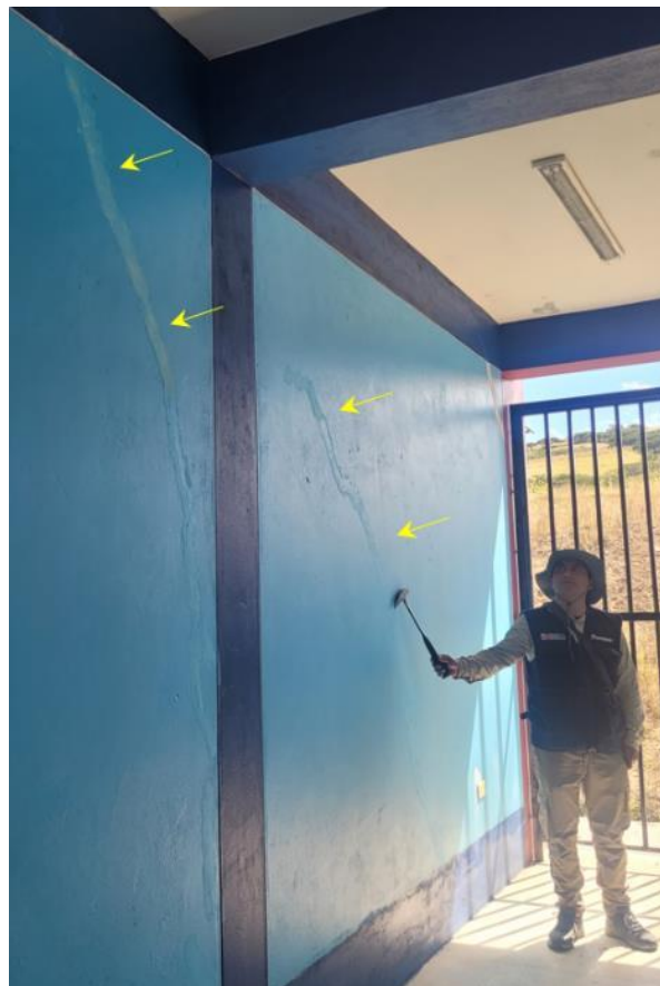
Figura 32. Paredes de pasadizo agrietadas por cimentación irregular del terreno.
