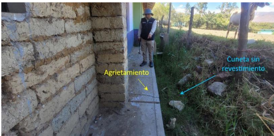
Figura 24. Cuneta sin revestimiento y agrietamiento en institución educativa. Coordenadas: E: 819910, N: 9158624.
