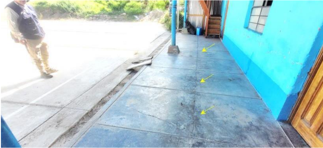
Figura 27. Agrietamiento en vereda, de local antiguo. Coordenadas: E: 819787, N: 9158684.
