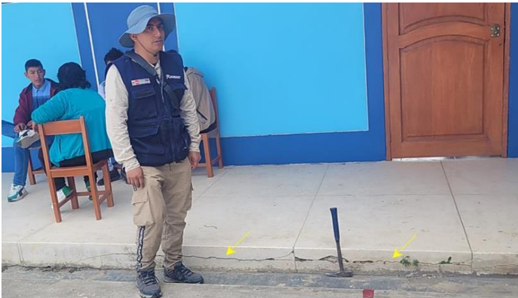
Figura 29. Vereda de patio principal presenta agrietamientos por efectos constructivos. Coordenadas: E: 818989, N: 9158451.
