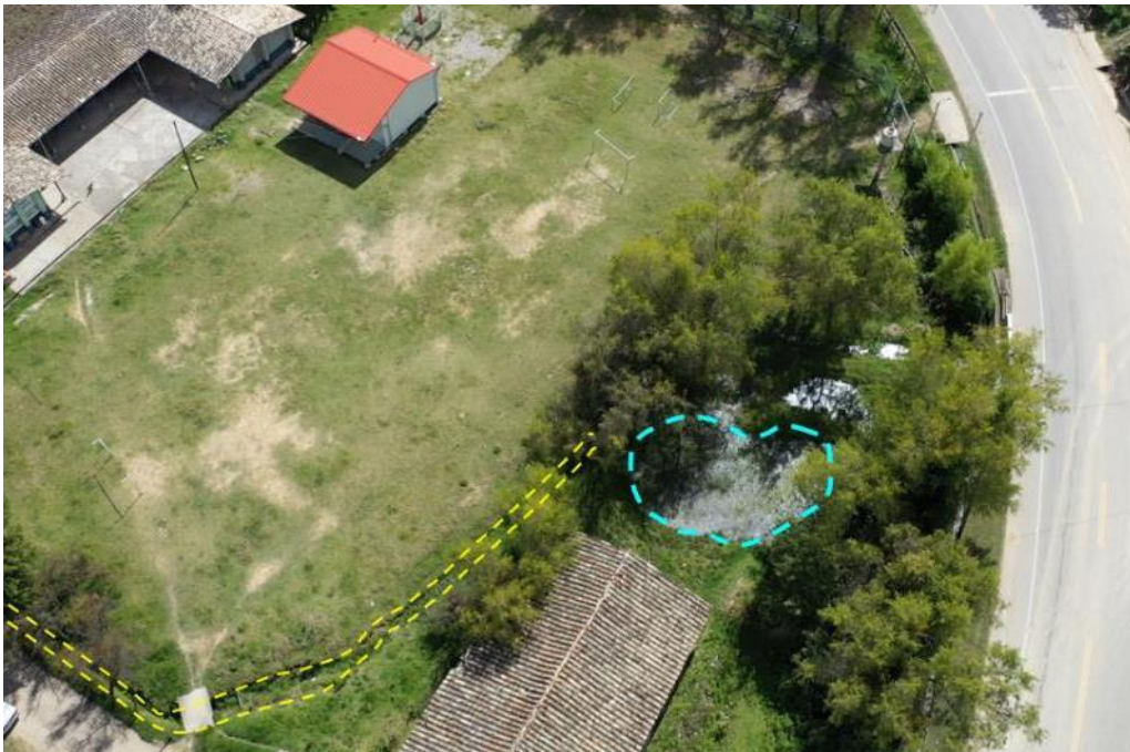
Figura 20. Se observa con líneas discontinuas amarillas, canaletas sin revestimiento y con líneas discontinuas celestes, acumulación de agua en el terreno, debido a la falta de un sistema de drenaje adecuado. Coordenadas: E: 819975, N: 9158647.
