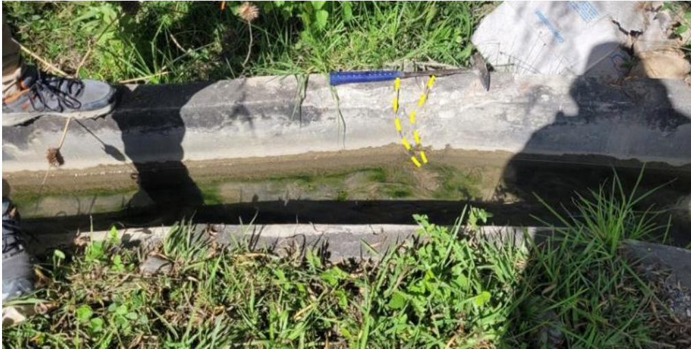
Figura 15. Fractura en canal revestido, originada por asentamiento de la carretera. Coordenadas: E: 819466, N: 9158579.
