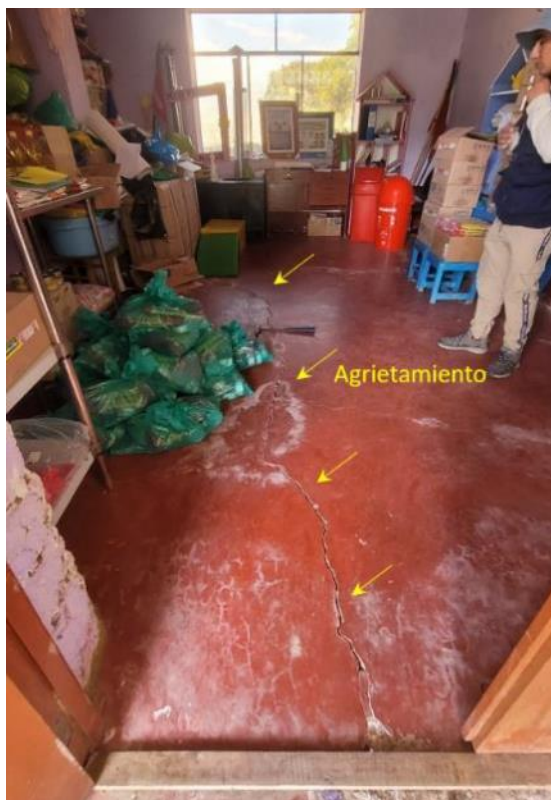
Figura 26. Agrietamiento en piso del almacén de institución educativa. Coordenadas: E: 808638, N: 9157504.
