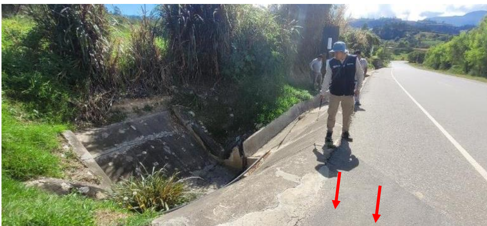
Fotografía 6. Agrietamientos en alcantarilla originados por asentamiento de la carretera. Coordenadas: E: 820360, N: 9158581.
