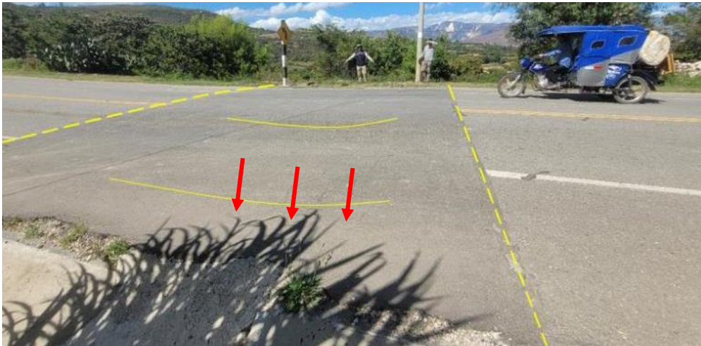
Figura 18. Asentamiento (delimitado en línea discontinua amarilla), en la carretera Cajamarca – Cajabamba. Coordenadas: E: 820195, N: 9158520.
