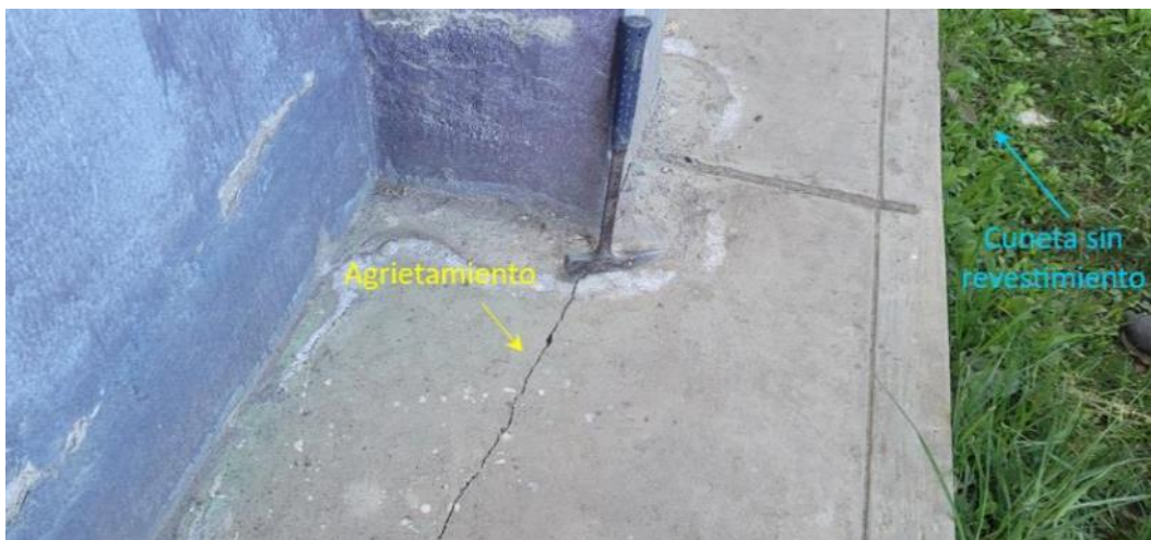
Figura 25. Agrietamiento en vereda, ubicada en parte posterior de institución educativa. Coordenadas: E: 808638, N: 9157504.
