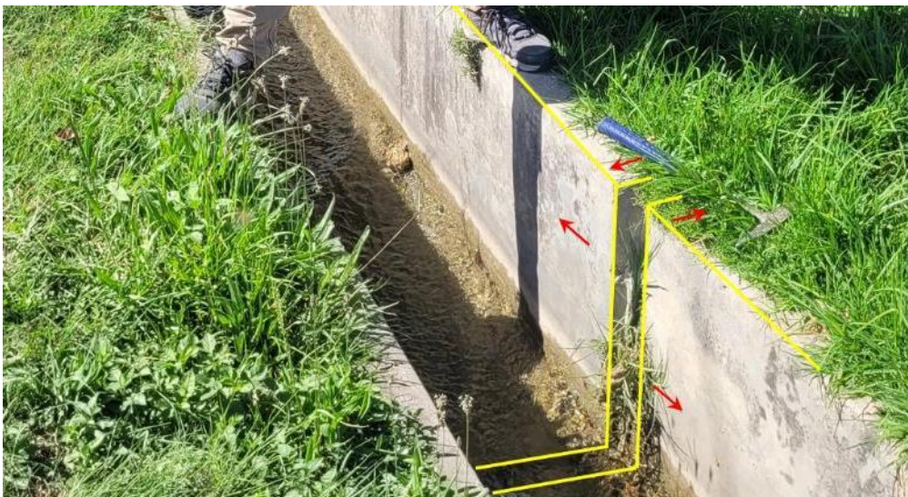
Figura 17. Desplazamiento horizontal en canal revestido (líneas discontinuas amarillas), originado por el asentamiento en la carretera. : E: 820110, N: 9158536.
