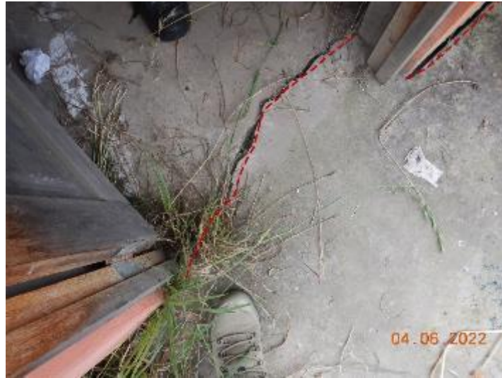
Figura 9: Piso de vivienda agrietado, generadas por efecto del desplazamiento del deslizamiento.
