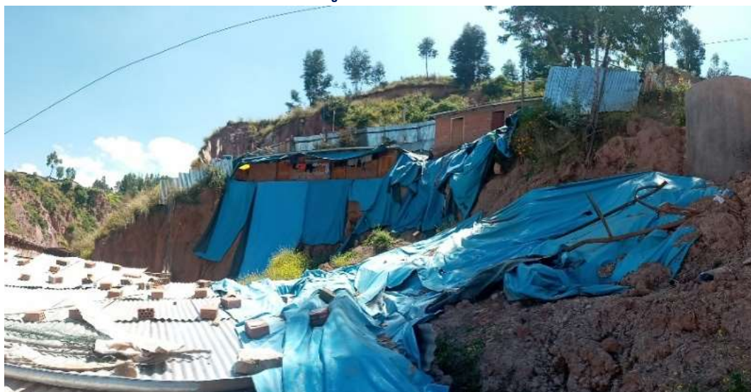
Imagen N° 11: Viviendas muy cerca a escarpas de fallas, actualmente se encuentran en un nivel riesgo muy alto, APV. Valle Ecológico Las Panacas Reales
