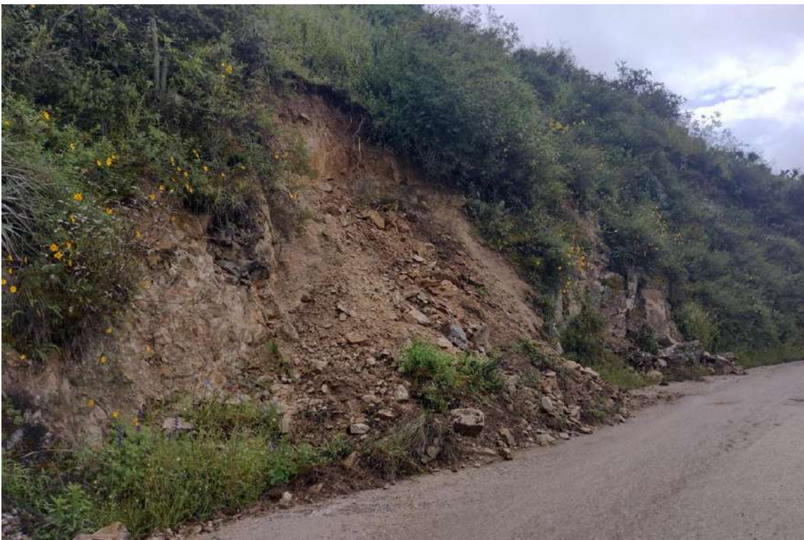
Gráfico 15: Derrumbes en el caserío de Ranhuas
