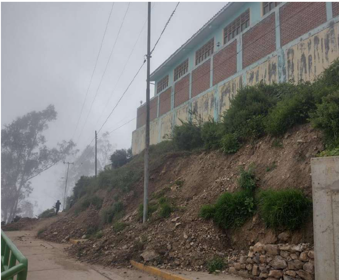
Gráfico 19: Tramo sin muro de contención en la institución educativa
