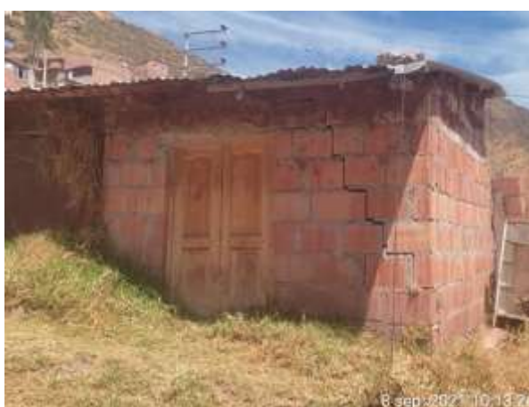
FOTOGRAFÍA 23: LOTES DE CONSTRUCCIÓN PRECARIA EN RIESGO MUY ALTO, LOTE UBICADA EN LA A.P.V. MOSOQ AYLLU
