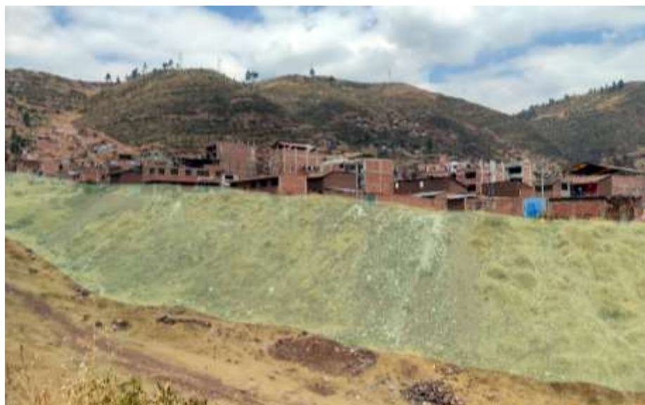
FOTOGRAFÍA 12: LIMITE ESTE DEL ANTIGUO BOTADERO DE SAN ANTONIO, MATERIAL DE RELLENO EN LA LADERA.
