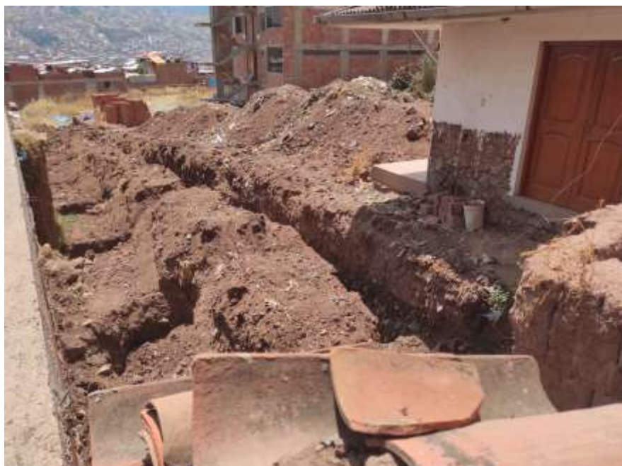
FOTOGRAFÍA 13: ABERTURA DE TERRENO PARA ZAPATAS, SE OBSERVA RELLENOS CON ESPESORES DE 1.0M A 1.5M.
