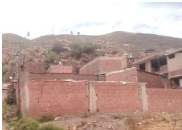
Fotografía N° 1 Vulnerabilidad económica, infraestructura de vivienda sobre rellenos con grietas
