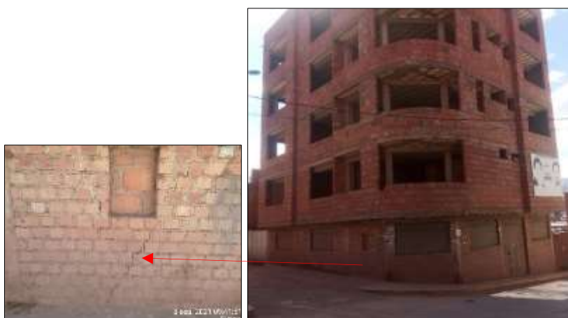
FOTOGRAFÍA 22: CONSTRUCCIONES CON MÁS DE 05 NIVELES DE EDIFICACIÓN, DONDE SE APRECIARON GRIETAS EN EL PRIMER NIVEL. CONSTRUCCIÓN UBICADA EN LA PROPIEDAD PRIVADA 4.
