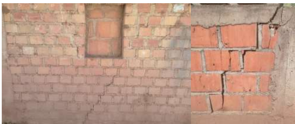
FOTOGRAFÍA 17: AGRIETAMIENTOS DE LAS VIVIENDAS, CONSTRUIDAS SOBRE MATERIAL DE RELLENO. UBICADO EN LA APV. LOS FRUTALES
