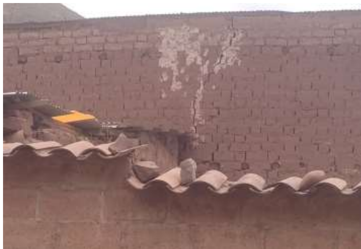
FOTOGRAFÍA 18: AGRIETAMIENTOS DE LAS VIVIENDAS, CONSTRUIDAS SOBRE MATERIAL DE RELLENO. UBICADO EN LA APV. LA FIORI
