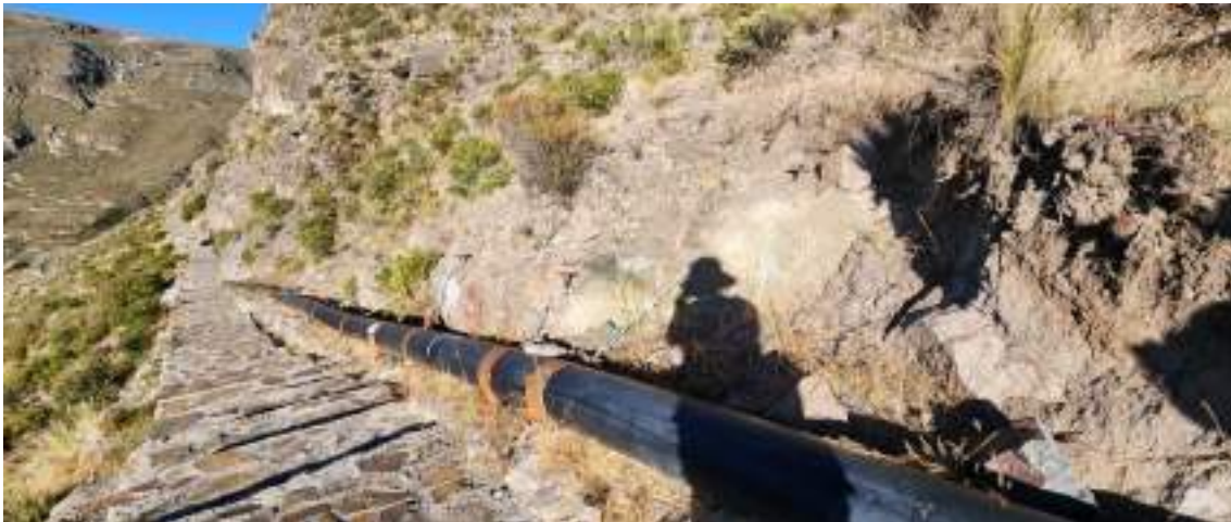
Figura 46. Ejemplo de un sistema de riego entubado.
