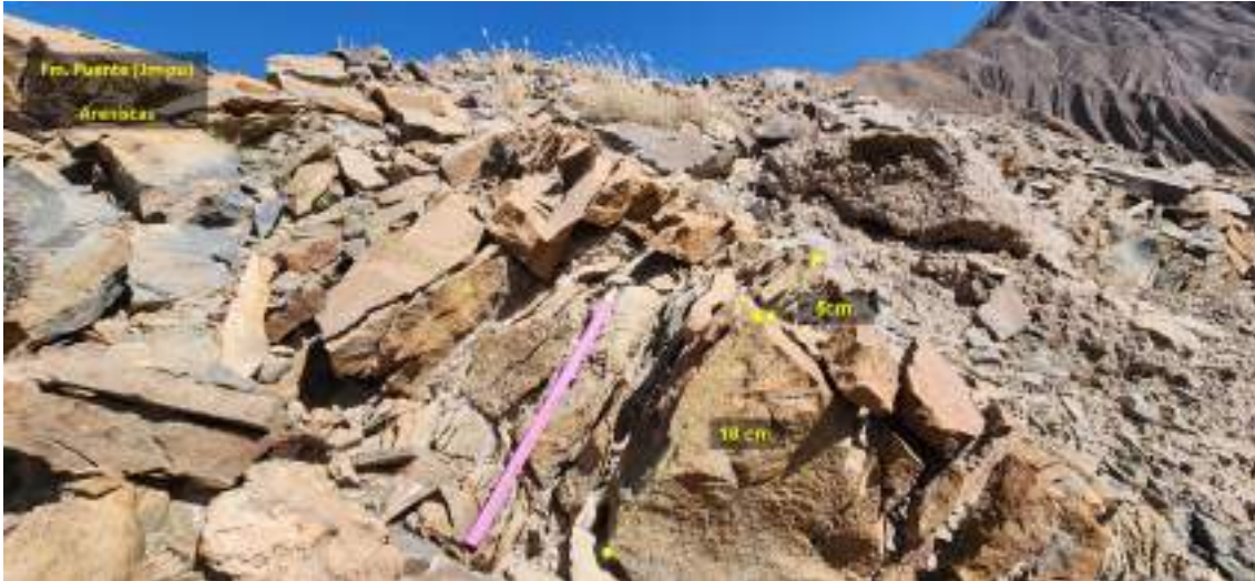
Figura 7. Sustrato rocoso de la Formación Puente – Sector Joto Jahuana. Muestra afloramientos de areniscas pardas de tonos amarillentos que están moderadamente meteorizadas y muy fracturadas (con espaciamientos entre 5 a 30 cm).
