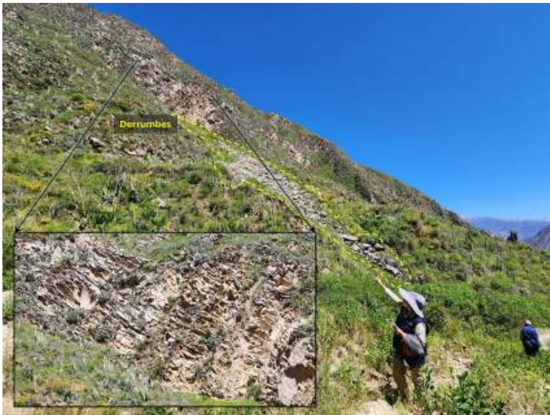
Figura 43. Se muestra la margen izquierda de la quebrada Agua Grande, se evidencia cicatrices de un derrumbe. Las condiciones del sustrato rocoso son areniscas moderadamente meteorizadas y medianamente fracturadas y laderas con pendientes muy escarpadas ( >45^\circ ).
