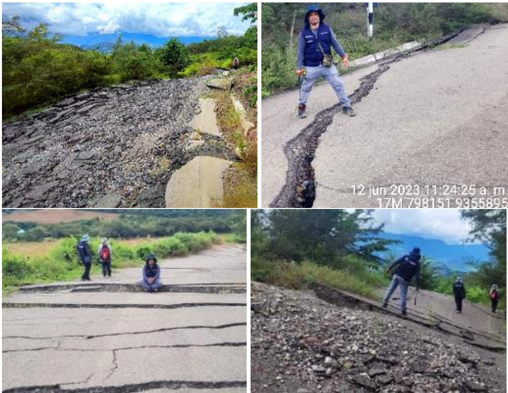
Fotografía 4. Vista de algunos tramos destruidos en la vía departamental AM-105 en la parte baja del deslizamiento Ñunya Temple.
