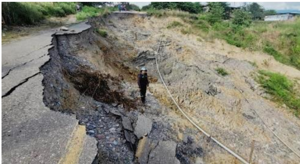
Fotografía 7. Vista del tramo de la vía AM-105 afectado por el deslizamiento flujo 1.
