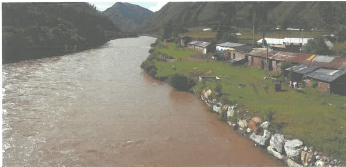
Fotografía 19. Sector susceptible a inundaciones en La margen izquierda del río Vilcanota en el sector de Huayraypata (UTM: 221796E; 8475148N)
