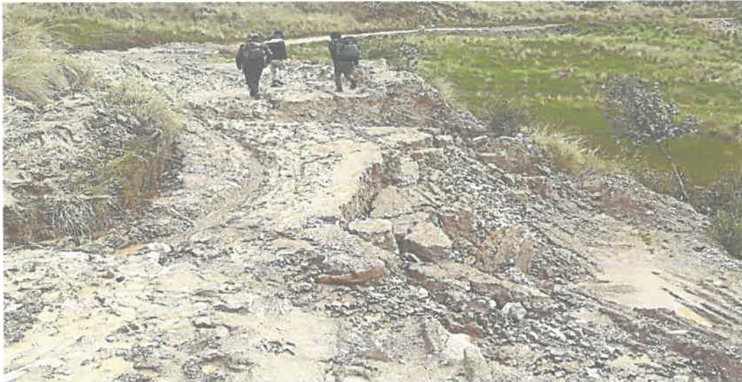
Fotografía 3. Pérdida de plataforma en la vía hacia Hayuni (UTM: 234351E; 234351N)
