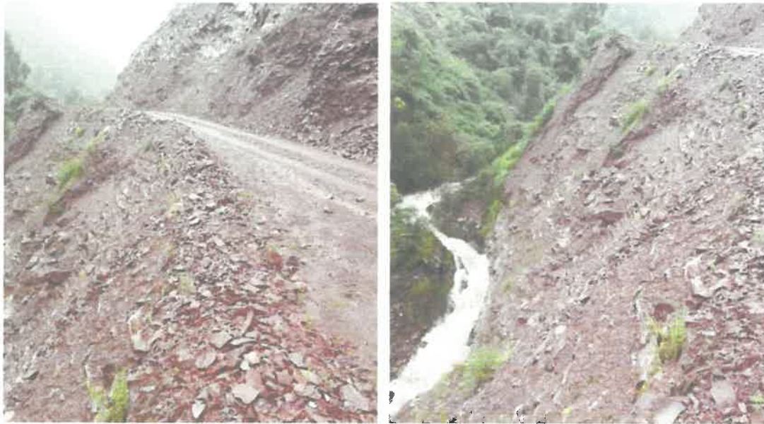
Fotografía 9. Zona inestable constantes deslizamientos en el tramo de la carretera Huacaytaqui – Usi (UTM: 224219E; 8465911N)
