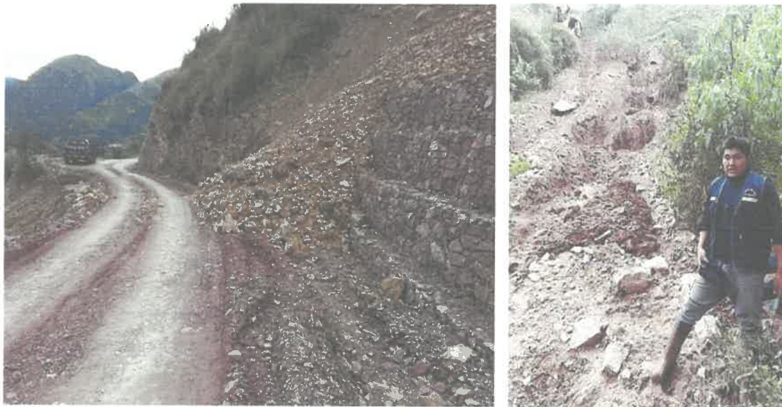
Fotografía 14. Deslizamientos en el sector de Callatiac (UTM: 226044E; 8478192N)
