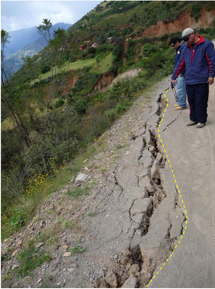
Foto N° 5: Agrietamientos longitudinales paralelos al deslizamiento y carretera de acceso a los pueblos de la Provincia de Pataz.
