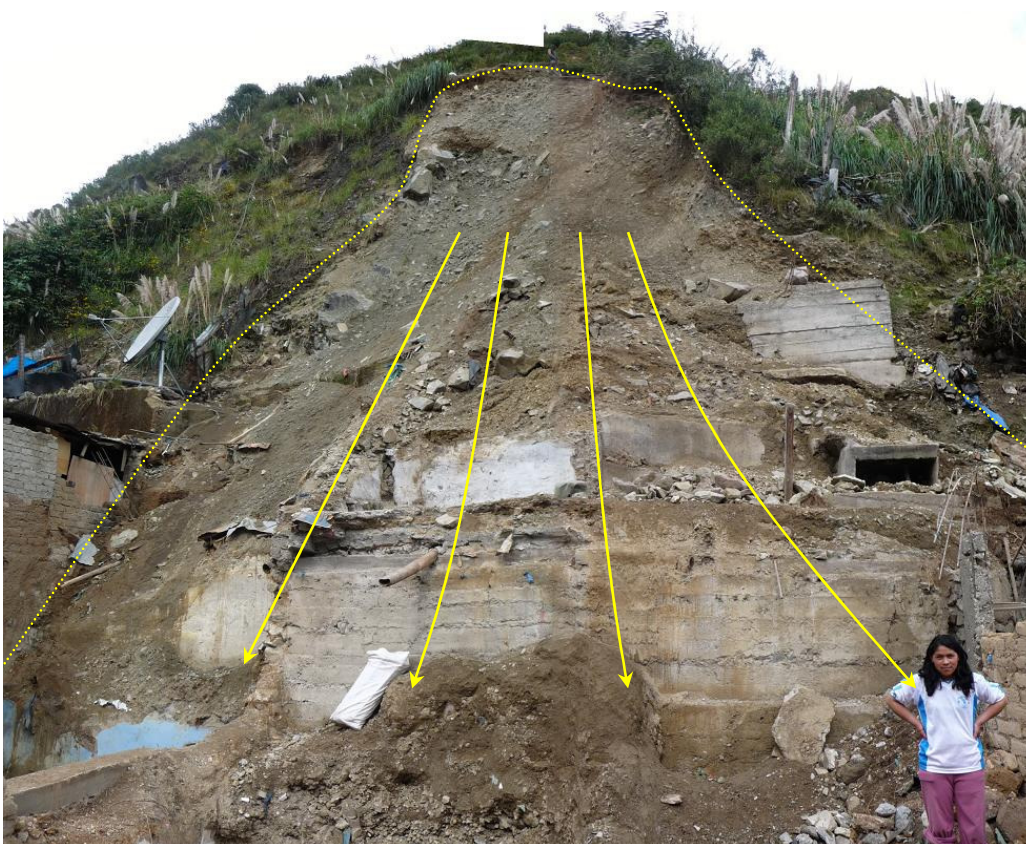
Foto 7: Escarpa del Derrumbe Retamas que afectó a 5 viviendas donde fallecieron 9 personas.
