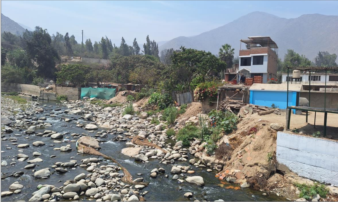
Fotografía 8. Vista de la margen izquierda del río Rímac, afectado por erosión fluvial. Requiere urgente una defensa ribereña en un tramo aproximado de 170 m.
