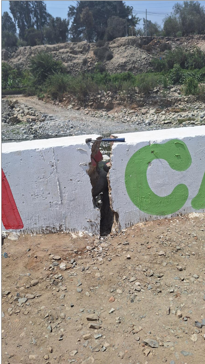
Fotografía 10. Vista del muro de concreto, que protege la margen derecha del río Rímac, en malas condiciones.
