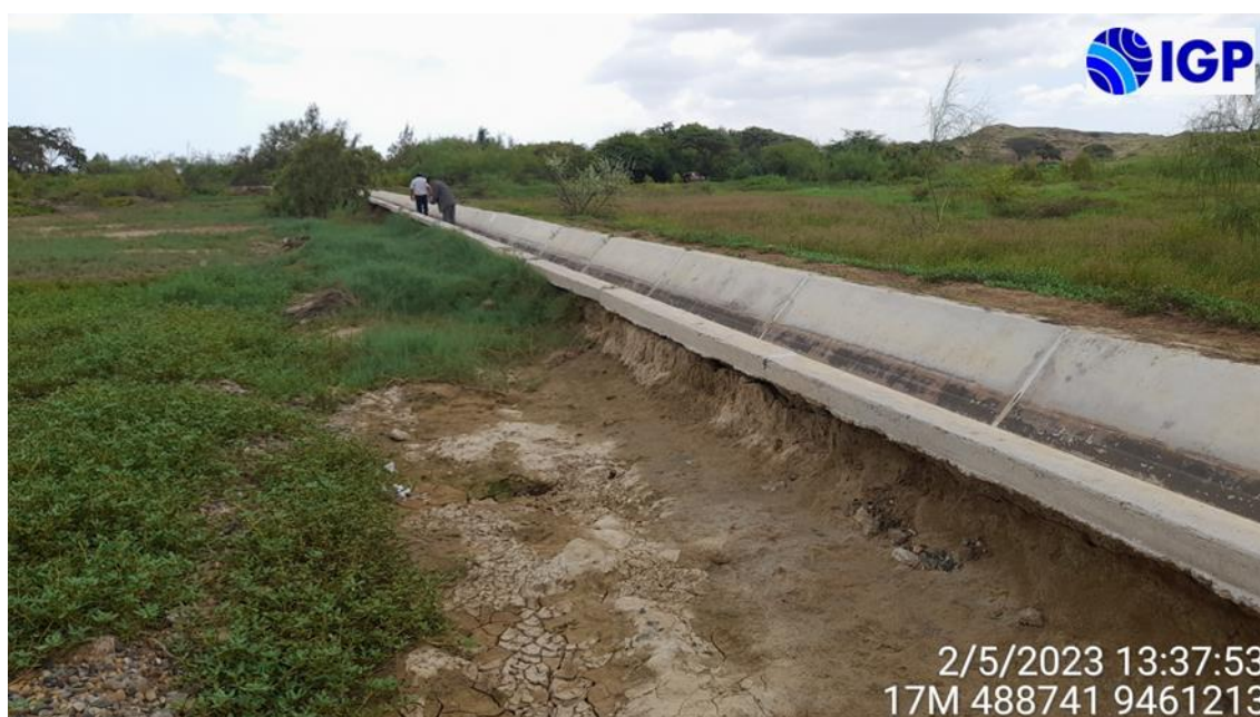
Figura 69.- Inundaciones pluviales contiguas al canal de regadío denominado Los Valencia, además, se ha originado la erosión lateral del canal y asentamiento de las losas de concreto debido a la saturación del suelo
