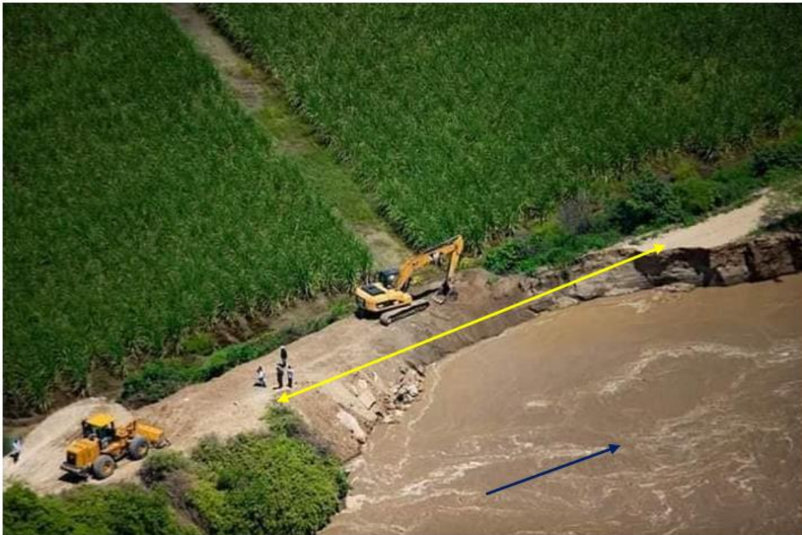
Figura 71.- Erosión fluvial en el margen izquierdo del río Chira (flecha azul) que originó el colapso de un tramo (flecha amarilla) de aproximadamente 90 m en el dique denominado 1020 en el sector Leticia. (Fuente: Municipalidad distrital de Vichayal)
