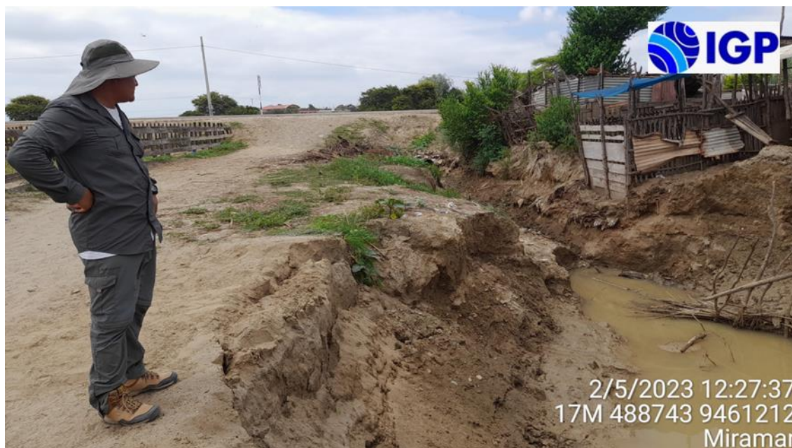
Figura 68.- Zona susceptible a inundaciones pluviales ante la ocurrencia de las precipitaciones pluviales e incremento del volumen de agua del canal denominado Nuto, además, se evidencia erosión lateral en ambos márgenes
