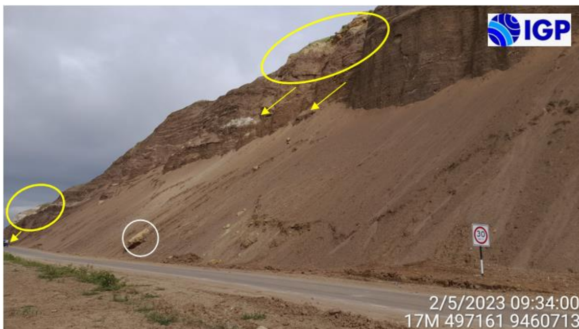
Figura 58.- Zonas susceptibles a caída de rocas (elipses amarillas) que podrían desprenderse y afectar vehículos o transeúntes de la vía Costanera. Como evidencia, se identificaron bloques de roca sobre la ladera del cerro Cinchado (círculo blanco).
