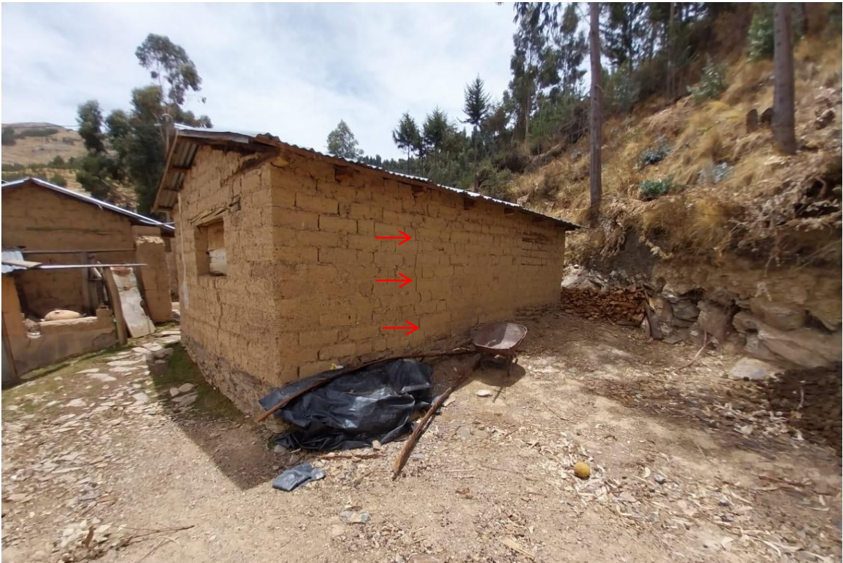
Estructura con agrietamientos ubicada en contacto entre material cuaternario y afloramiento de pizarras, propiedad de Benancio Pacco Calcina.
