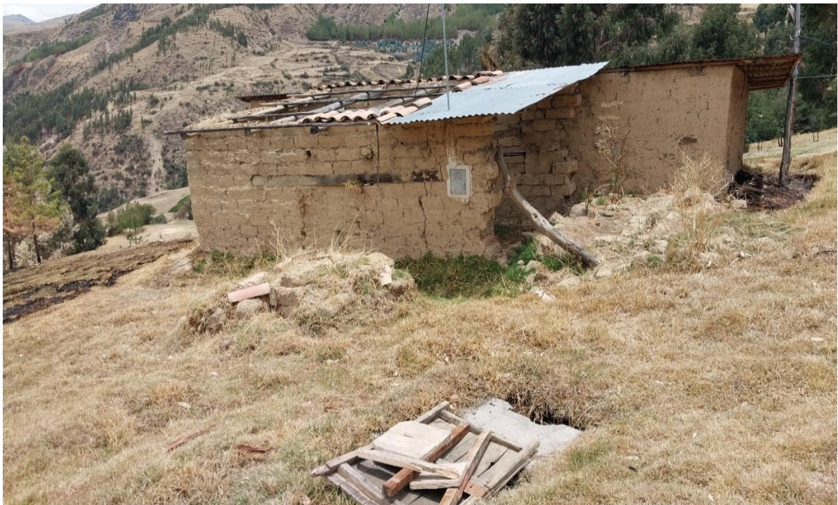
Estructura colapsada ubicada en zona de deslizamiento activo propiedad de José Cáceres.
