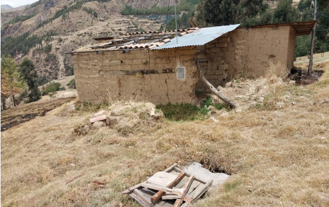
Foto 7 Estructura colapsada ubicada en zona "superior Callacunca" propiedad de José Cáceres.
