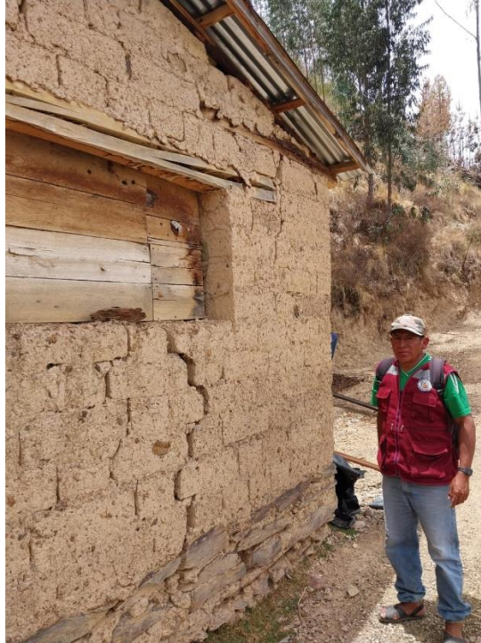
Foto 9 Estructura con agrietamientos ubicada en contacto entre material cuaternario y afloramiento de pizarras, propiedad de Benancio Pacco Calcina.
