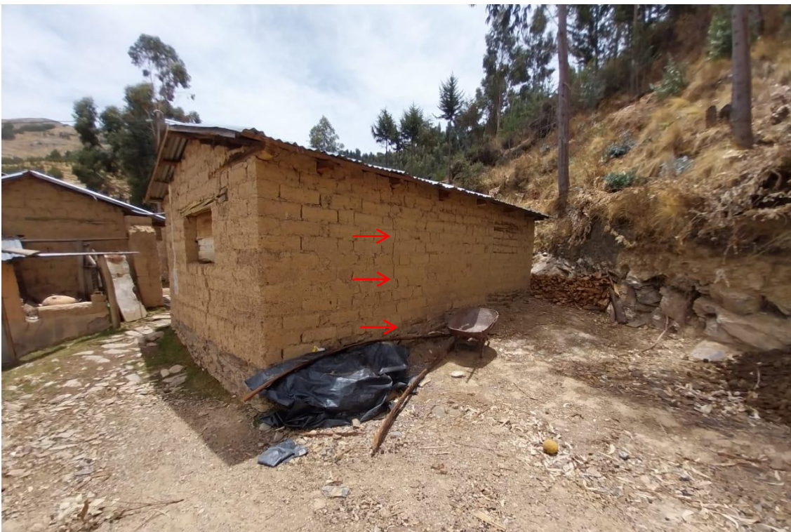
Foto 8 Estructura con agrietamientos ubicada en contacto entre material cuaternario y afloramiento de pizarras, propiedad de Benancio Pacco Calcina.
