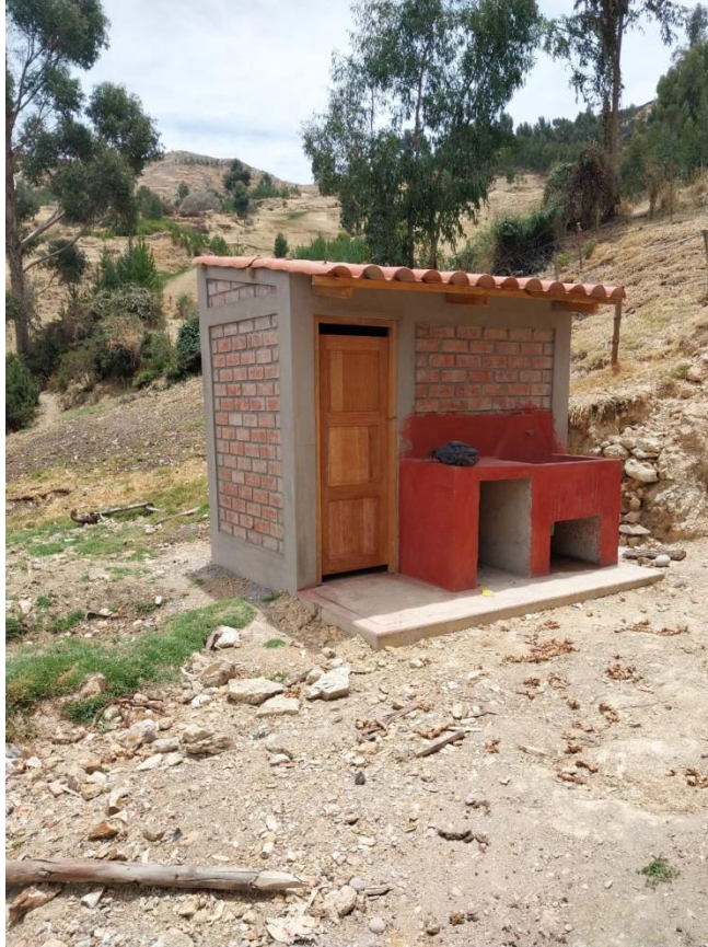
Programa de saneamiento básico, construcción de baños con sistema de arrastre para los pobladores de Callacunca
