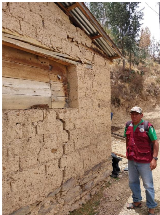
Estructura con agrietamientos ubicada en contacto entre material cuaternario y afloramiento de pizarras, propiedad de Benancio Pacco Calcina.
