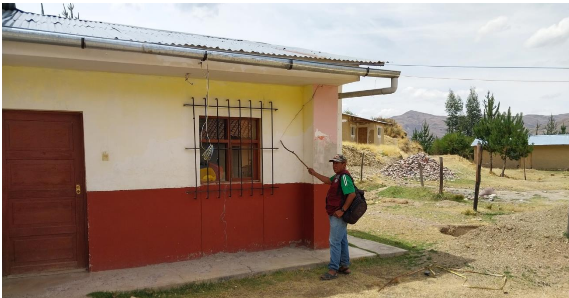
Foto 11 Fracturas en infraestructura de Pronoi Callacunca producido por asentamiento de suelo, ubicado en parte plana del centro poblado Callacunca (UTM: 229505E/8468804N; cota: 3813 msnm)
