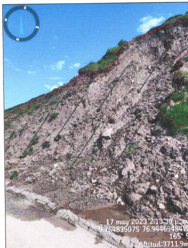
Ilustración 14. Talud de la carretera AN-1260 con procesos de derrumbes y flujos nos canalizados.
