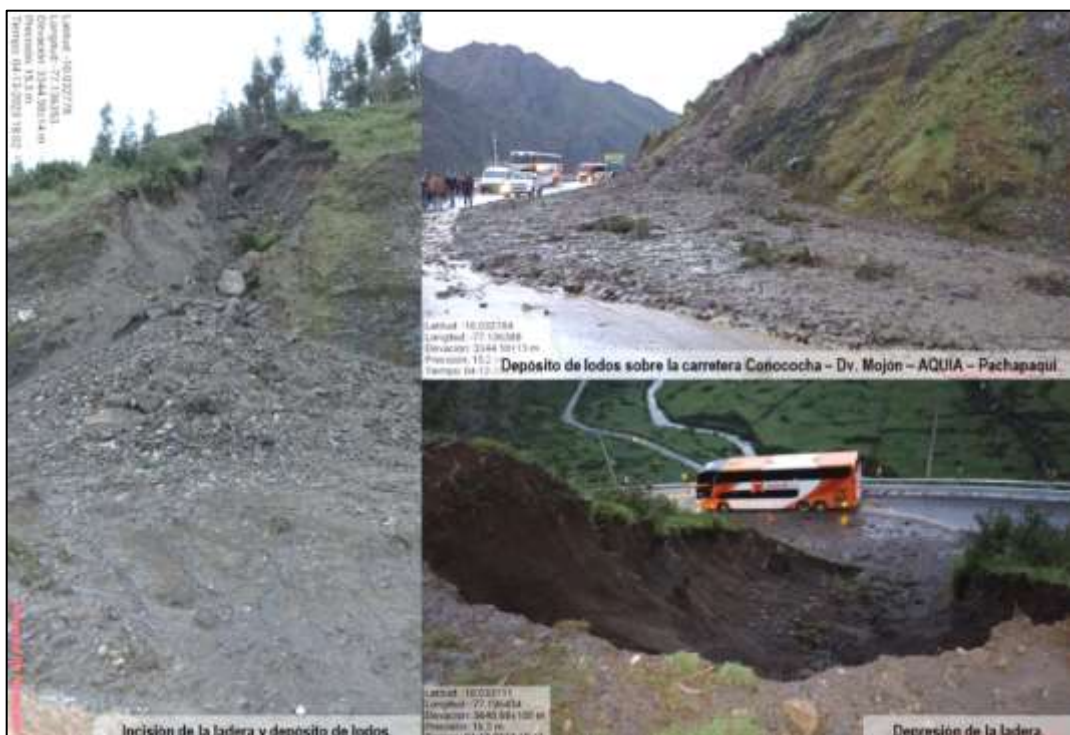
Ilustración 44. Flujo de lodos no canalizado en el Km. 28+000 de la carretera Conococha – Dv. Mojon - Aquia.
