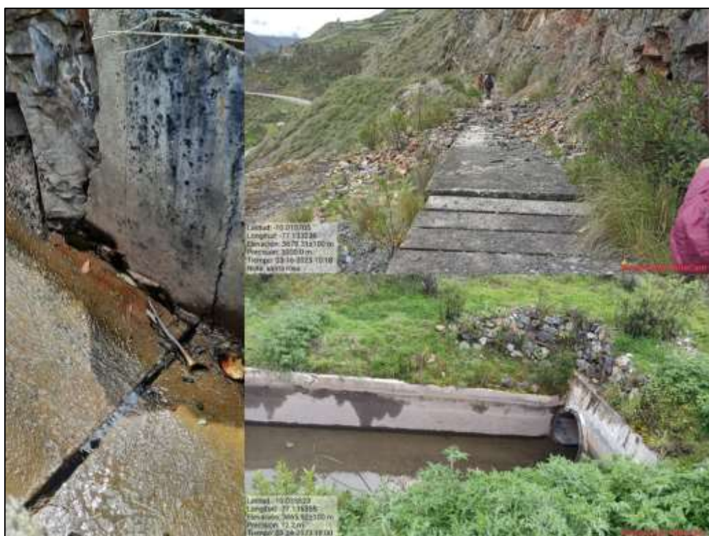
Ilustración 42. Agrietamiento y deterioro del canal de aducción de la hidroeléctrica Pacarencia.
