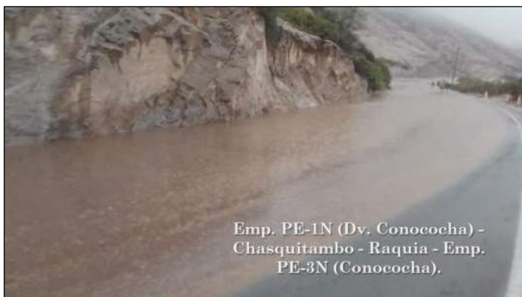
Ilustración 77. Zona inundación por agua de escorrentía pluvial.
