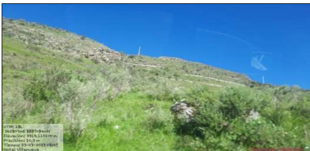
Ilustración 50. Zona de deslizamiento bajo el talud de la carretera Conococha – Dv. Mojón – Aquia.
