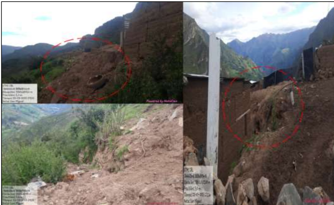
Ilustración 46. Deslizamiento del talud colindante a la carretera Conococha – Antamina en el Km. 23+700.
