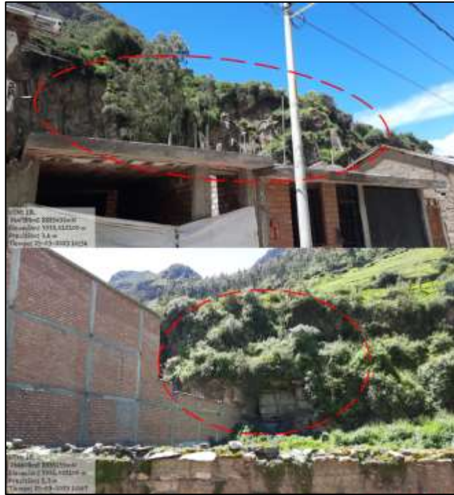
Ilustración 31. Zona de caída de rocas en el sector Callao, centro poblado de Aquia.
