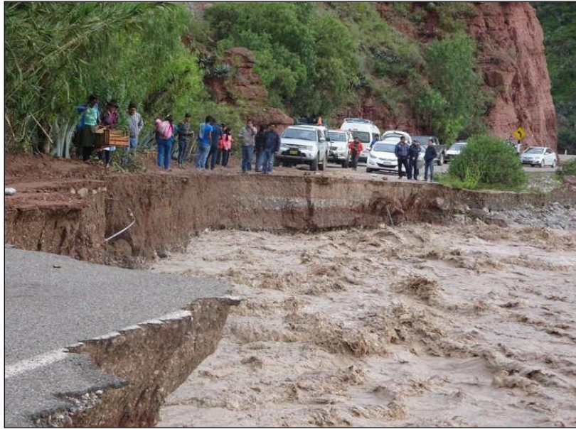
Figura 04. Imagen de socavación de la plataforma vial.
