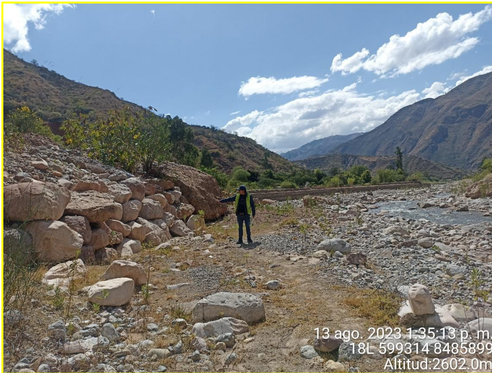
Fotografía N° 03: Vista hacia el norte tramo superior del área EVAR, sectores susceptibles a ser socavado, en la imagen se aprecia el enrocado como protección a la crecida del cauce del río Huancapi.
