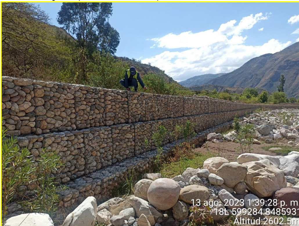
Fotografía N° 04: Vista hacia el norte tramo superior del área EVAR, sectores susceptibles a ser socavado, en la imagen se aprecia el inicio del sistema de protección ribereña en el margen izquierdo del río Huancapi.
