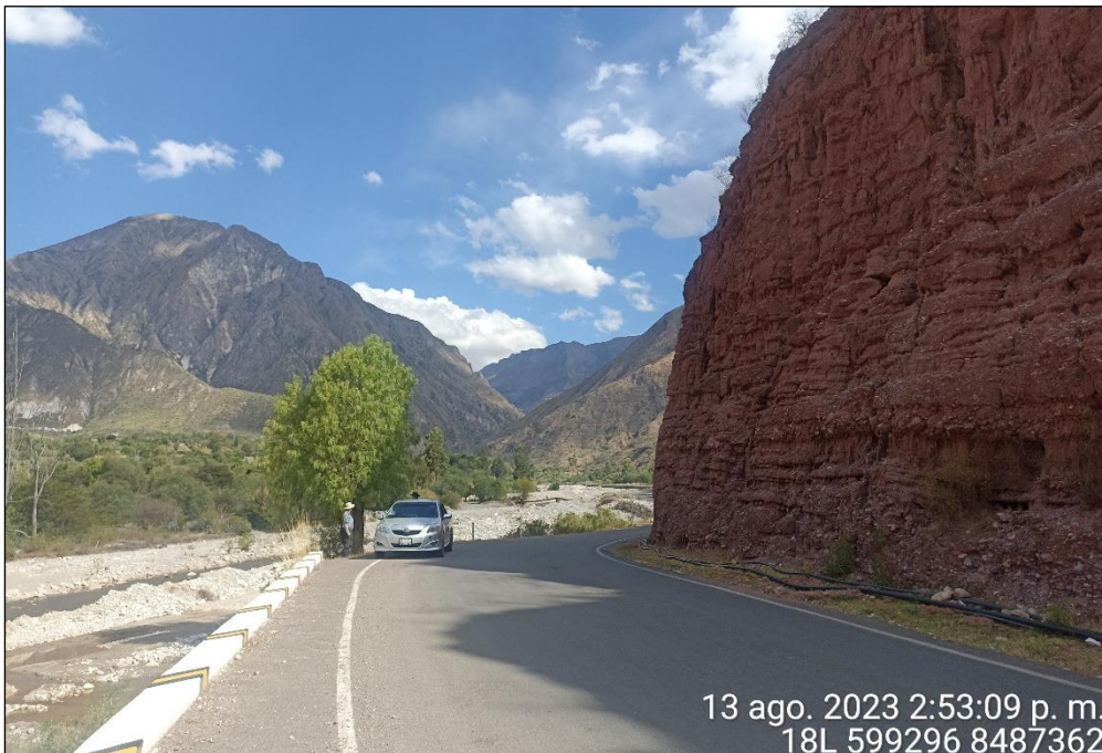
Figura N° 039. Vía nacional expuesta, sector Tío Cucho
