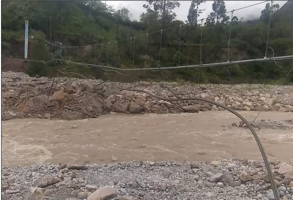
Figura N° 038. Pase aéreo de agua expuesto, Sector San José - Ccechua
