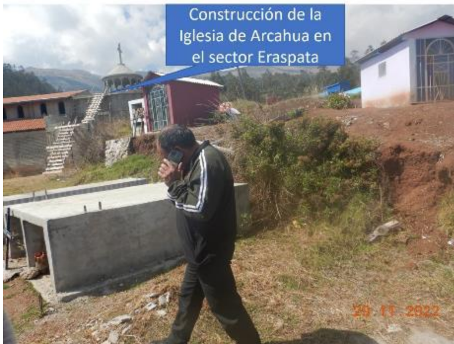
Figura 9. Se aprecia la iglesia en construcción junto al cementerio, la que puede ser afectada si las grietas retrogresivas llegan hasta la iglesia.
