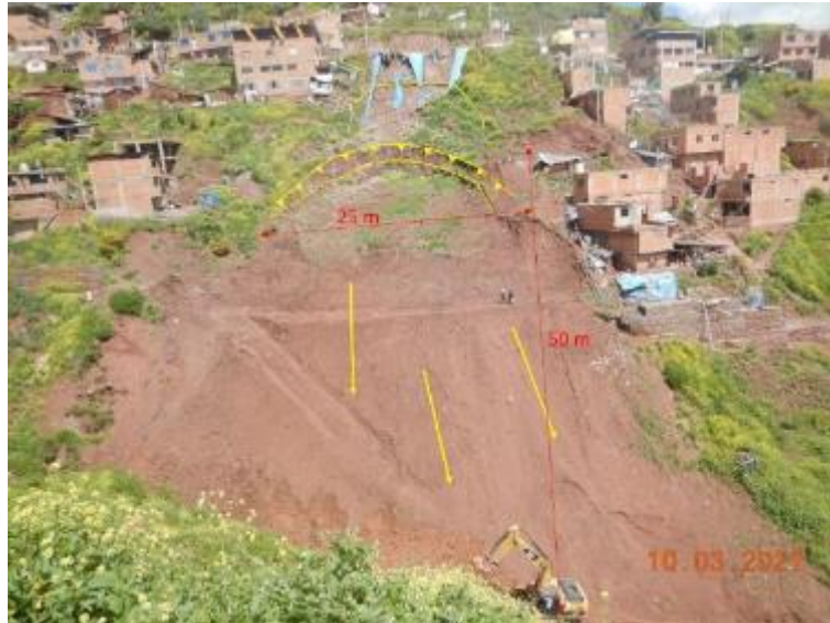
Figura 10. Deslizamiento activo con construcción de gaviones en su margen izquierda, se aprecia grietas retrogresivas y el escarpe principal con 1.5 m de caída.
