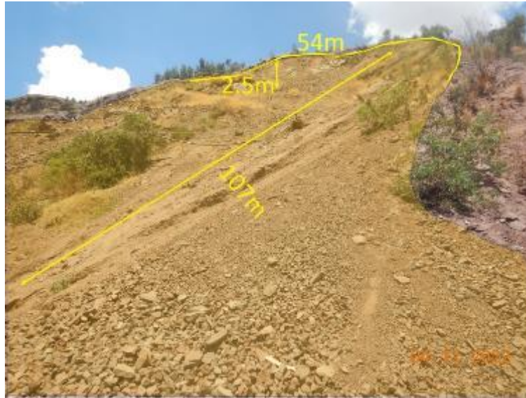
Figura 13. Vista tomada en coordenadas UTM: 175595 E, 8502177 S. Se aprecia la reactivación del deslizamiento con presencia de grietas y constante actividad.
