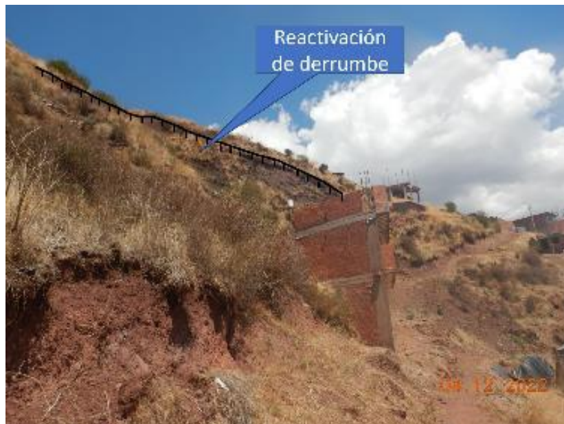
Figura 16. Se aprecia una reactivación de derrumbe ubicado en la margen derecha de la escarpa del derrumbe antiguo.
