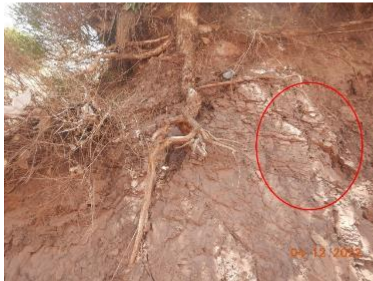
Figura 3. Se aprecia la litología de la Formación Quilque compuestas por lutitas muy fracturadas y moderadamente meteorizadas.
