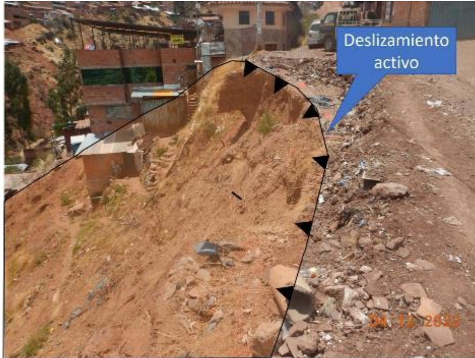
Figura 9. Vista tomada en coordenadas UTM: 175716 E, 8502396 S. Se aprecia el deslizamiento con constante actividad, más aún en épocas de lluvias.
