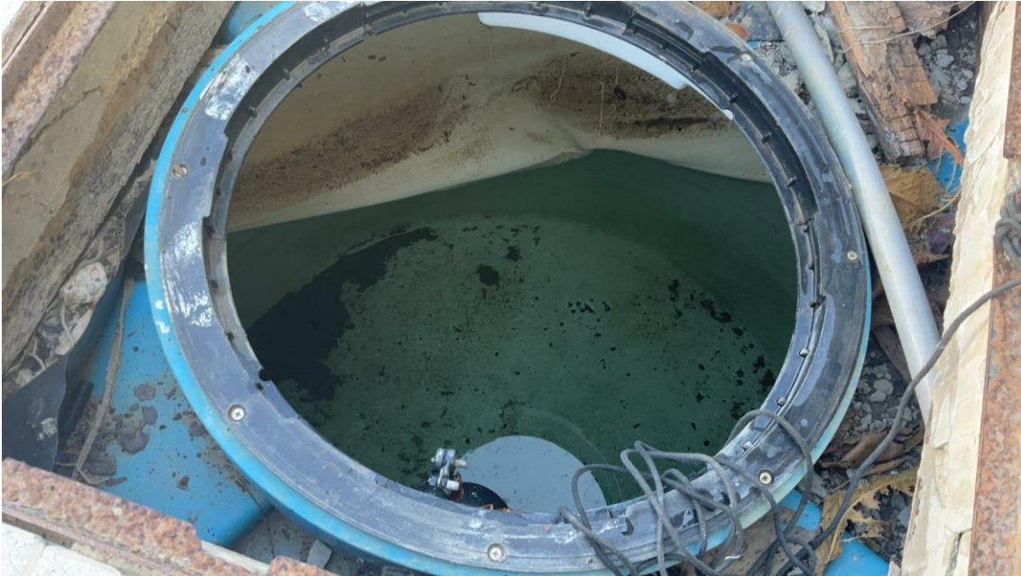
Foto g. Tanque de agua enterrado. Se puede observar los plieques del tanque, los cuales presentan grietas. Coordenadas UTM: 466090.76/9485377.57.
