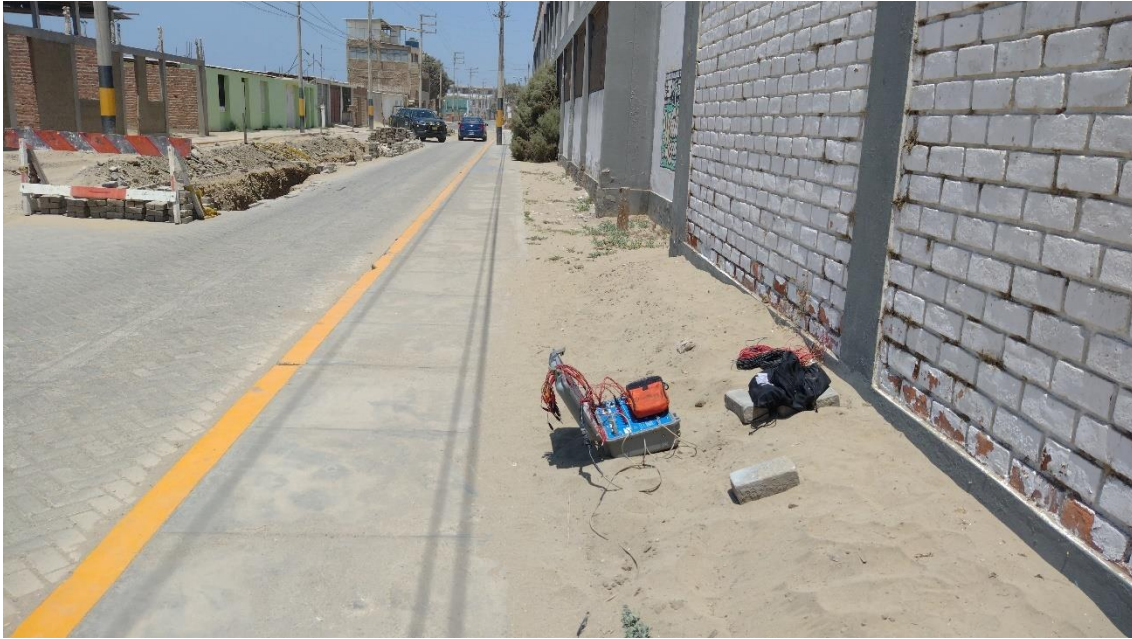
Foto 6. Ubicación de la estación de medición en la sección L-02, ubicado en la Avenida Loreto.
