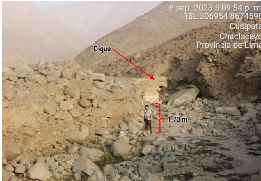
Figura 4. Dique colapsado (Altura CIAR Cusipata CGR), en la quebrada Cusipata.
