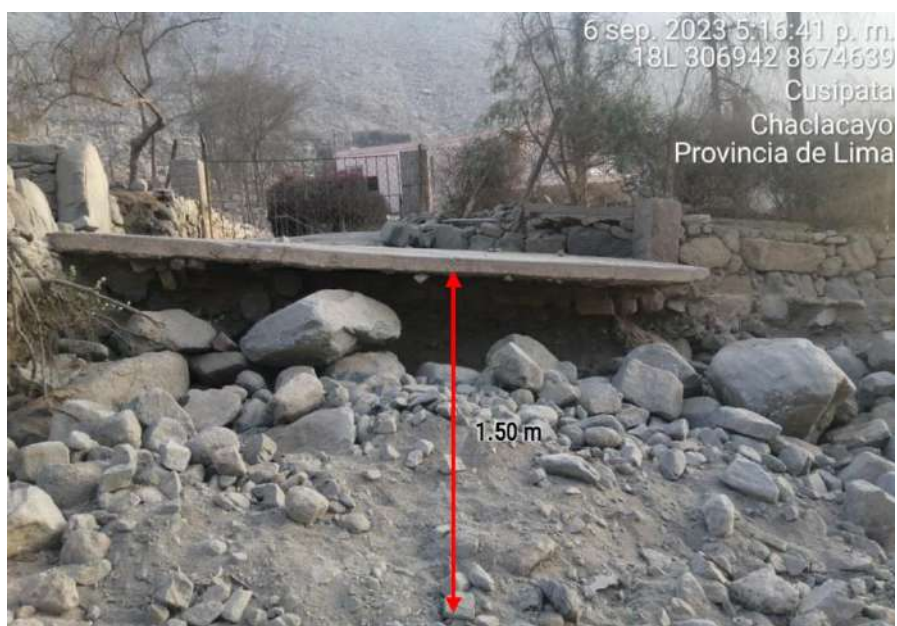
Figura 5. Socavación del flujo de detritos en calle las Terrazas, Cusipata.
