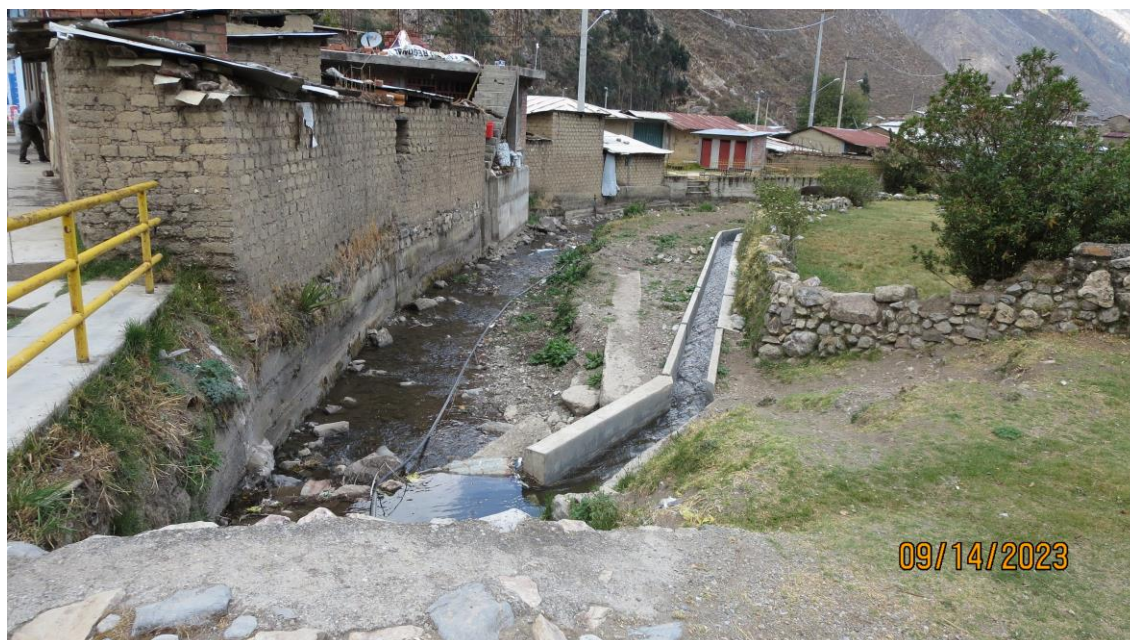
Fotografía 343. Vista tomada en dirección sureste, se observa viviendas del Centro Poblado Tinta ubicados en la margen izquierda de la quebrada Cutacancha, el sector presenta procesos geológicos por movimientos en masa como flujo de detritos, erosión fluvial, de ocurrir estos eventos afectaría viviendas, puente e institución educativa que se encuentra cerca al cauce principal. Las coordenadas UTM correspondientes son 8818668 al norte y 300593 al este.
