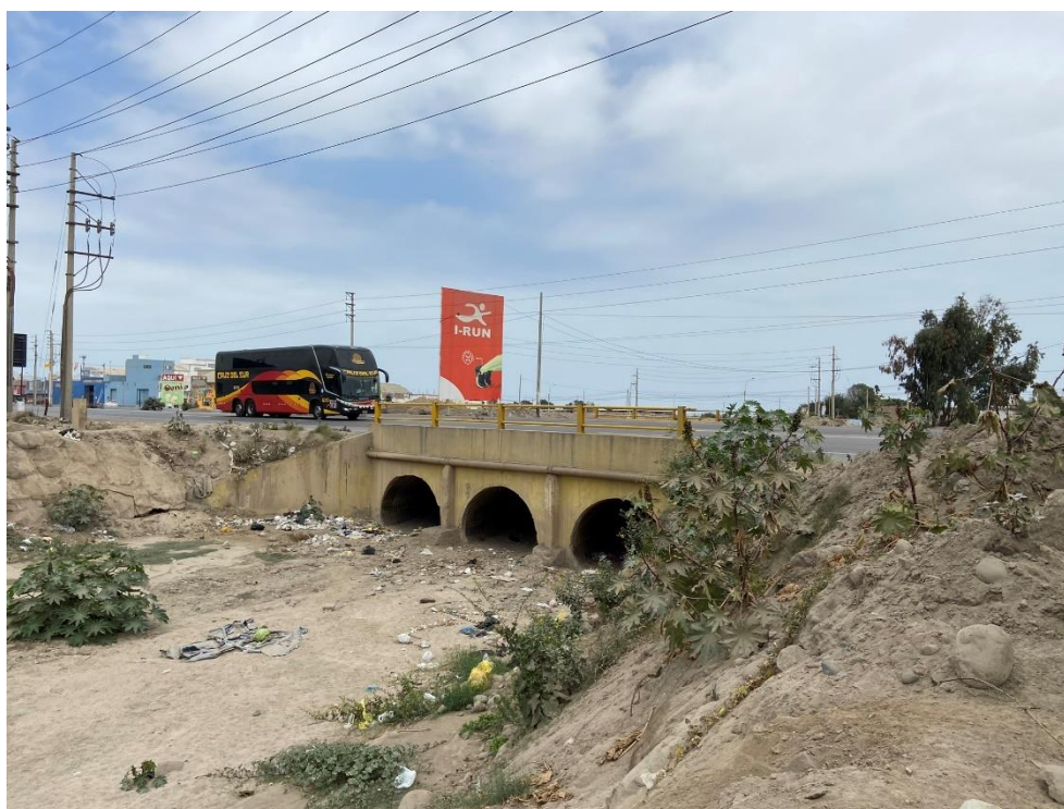
Fotografía 352. Zona crítica 15-233. El puente Quebrada Chilca I y la Carretera Panamericana Sur pueden ser afectado por flujo de detritos debido a que el área de alcantarillado es muy angosta, distrito Chilca. Coordenadas UTM 310967E/8617050N, zona 18S. Tomado el 08/09/2023.
