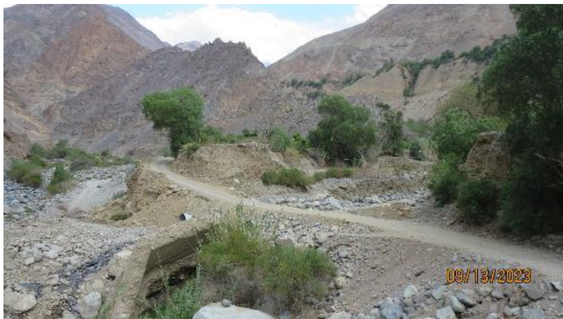
Fotografía 320. En la imagen tomado con Drone se observa la desembocadura de la quebrada Arcumayo - Cajatambo se observa que en el sector se generan flujos en periodo de lluvias intensas y que con el ultimo evento ocasiona daños al puente que comunica a los centros poblados de los distritos. Coordenadas UTM 8833244 al norte y 261671 al este.
