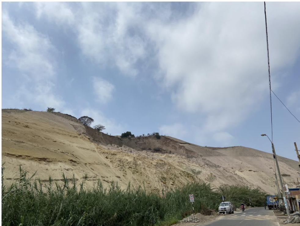
Fotografía 346. Zona crítica 15-219. Deslizamiento rotacional en el sector de Montejato, aledaño a Carretera a Úngara y viviendas, distrito San Vicente de Cañete. Coordenadas UTM 355979E/8550478N, zona 18S. Tomado el 30/08/2023.
