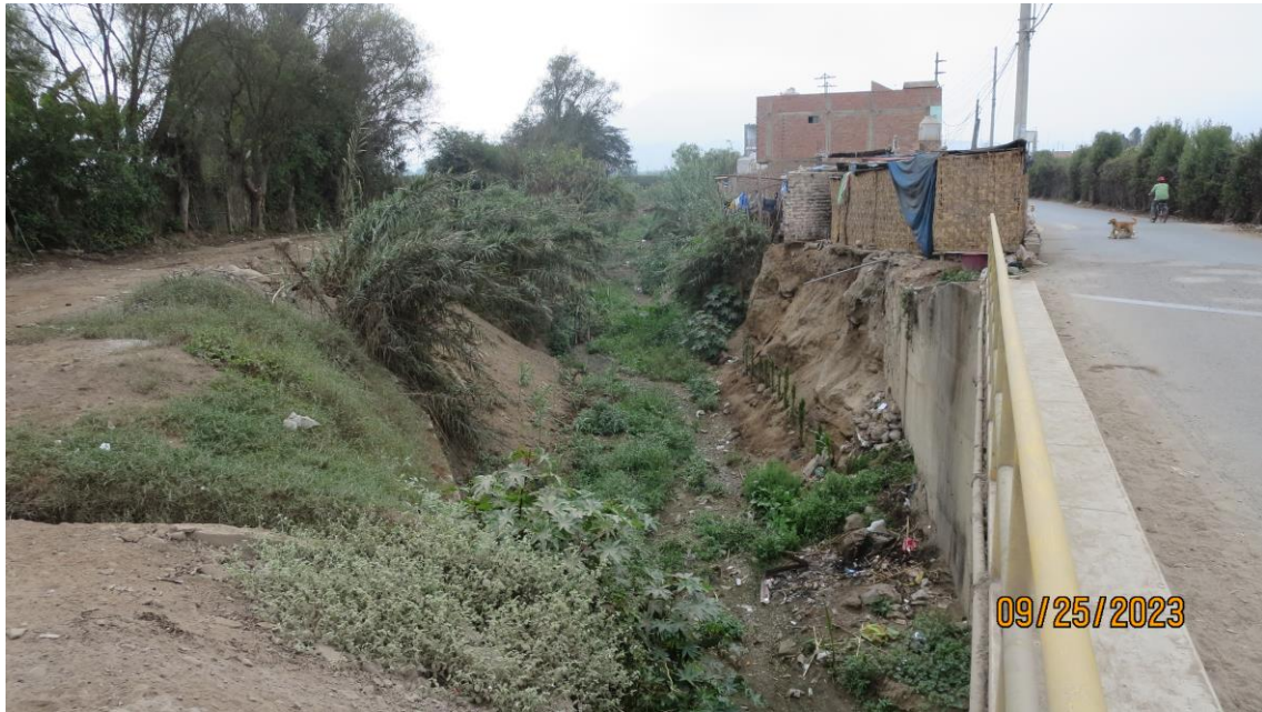
Fotografía 334. La vista tomada en dirección norte nos muestra una imagen del puente San Isidro en el río Pisquillo, es propenso a experimentar procesos geológicos como erosión fluvial, durante periodo de lluvias intensas afectaría viviendas asentadas al borde del cauce. Las coordenadas UTM correspondientes son 8729722 al norte y 267864 al este.
