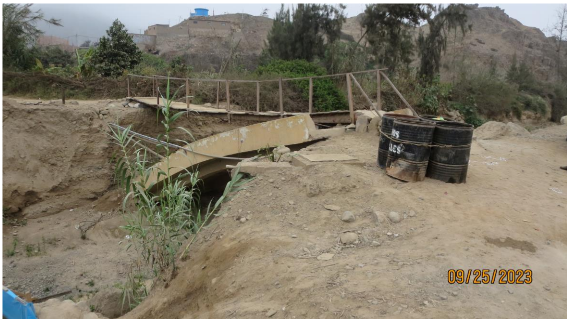
Fotografía 333. La vista tomada en dirección norte nos muestra una imagen del puente rojo Pisquillo, es propenso a experimentar procesos geológicos como erosión fluvial, durante periodo de lluvias intensas afectaría el escribo del puente. Las coordenadas UTM correspondientes son 8730295 al norte y 270379 al este.
