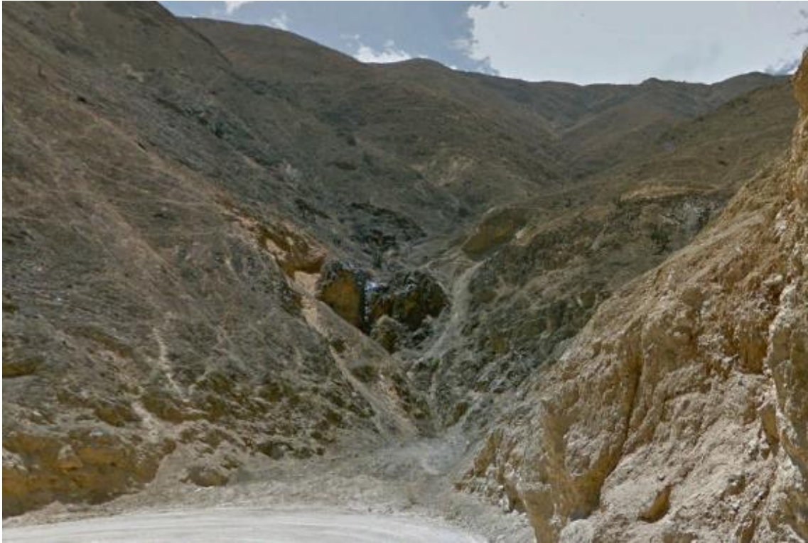
Fotografía 330. La vista capturada con dirección norte, nos muestra una quebrada que se encuentra en el flanco suroeste del cerro Ocurhuay, en el lugar se generan flujos de detritos y derrumbes que afectan tramo km 6+000 de vía asfaltada que comunica los poblados ubicados en el valle Añasmayo. Las coordenadas UTM correspondientes son 8746331 al norte y 298207 al este.
