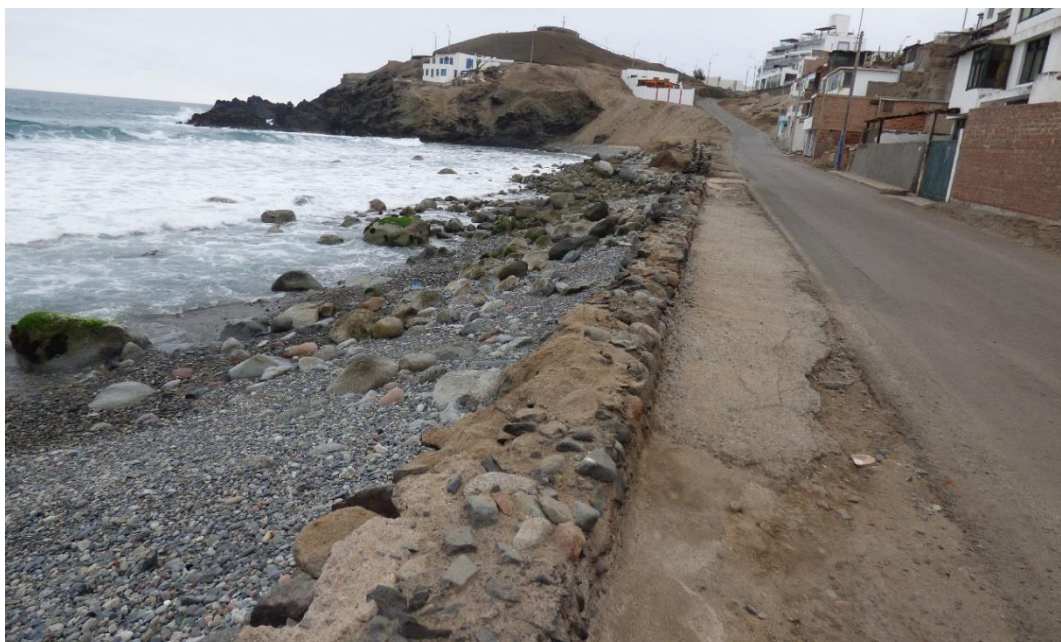
Fotografía 102. Playa Sur en el distrito de San Bartolo. Se observan cómo las aguas están erosionando la playa de cantos y socavando los muros de protección.
