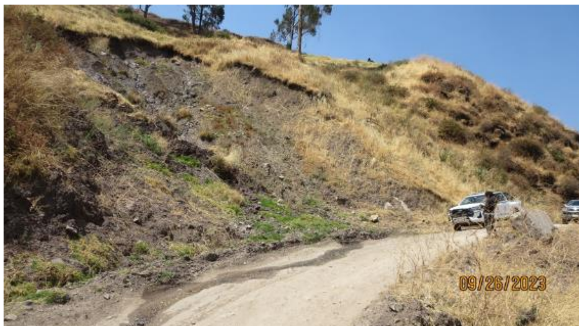
Fotografía 324. La captura, tomada en dirección sureste, nos ofrece una vista del talud superior de la carretera de acceso al centro poblado de Cahua, es afectado por deslizamiento que presenta reactivaciones. Las coordenadas UTM asociadas son 8725883 al norte y 320142 al este.
