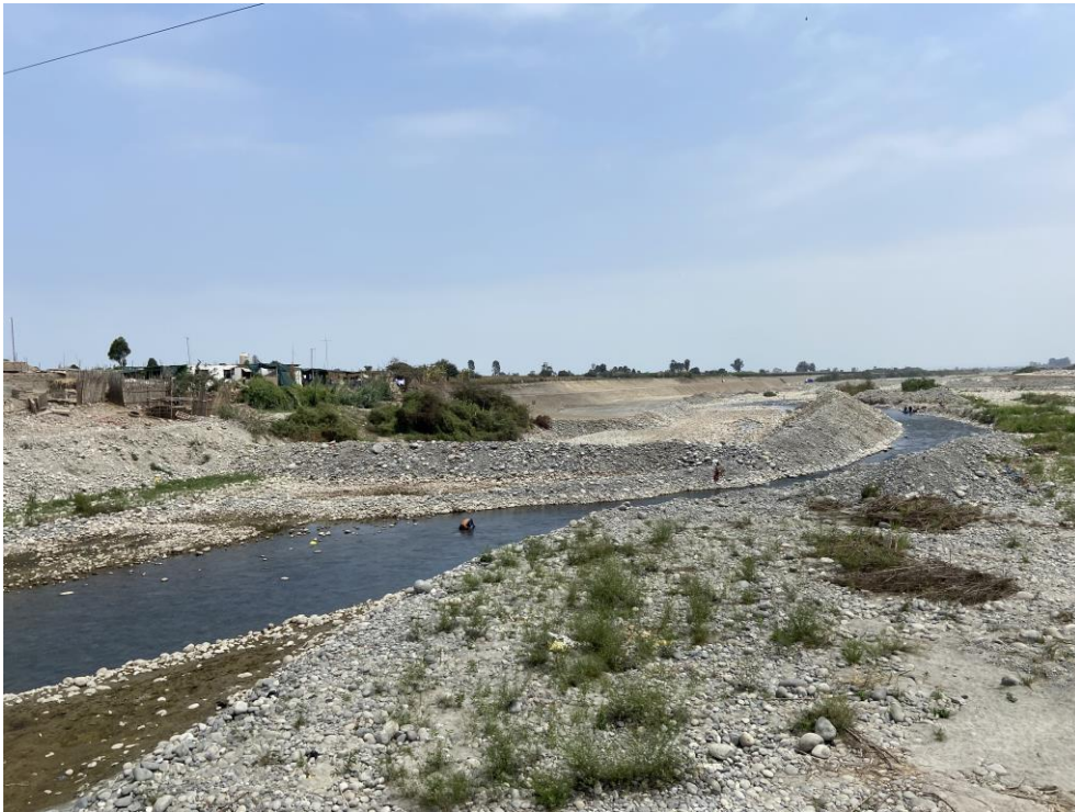
Fotografía 345. Zona crítica 15-218. Peligro de erosión e inundación fluvial en el sector Clarita, San Vicente de Cañete. Coordenadas UTM 352339E/8548633N, zona 18S. Tomado el 30/08/2023.
