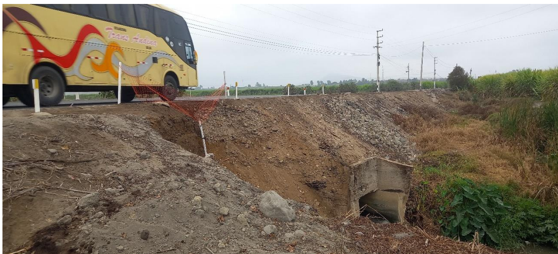
Fotografía 307. Vista tomada con dirección este, el tramo de cartería Paramonga – Upaca, sector Puente Upaca, es afectado por derrumbes, erosión fluvial y con la presencia de lluvias extraordinaria se incrementa el caudal llegando a desbordar e inundar los terrenos de cultivo por obstrucción de puente por que supera su capacidad para el que fue diseñado. Coordenadas UTM 8820058 norte y 200483 este.
