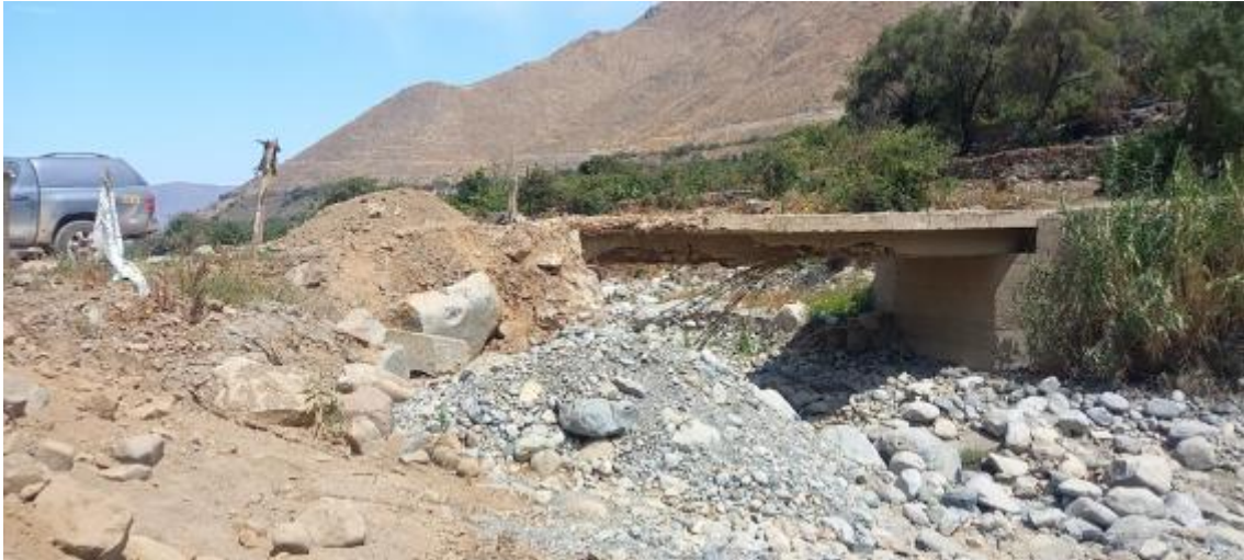
Fotografía 327. Puente Callas (Canta), coordenadas UTM N: 8711091 y E: 311846. Se observa puente que se encuentra en malas condiciones técnicas, afectado por el último evento climatológico (2023).
