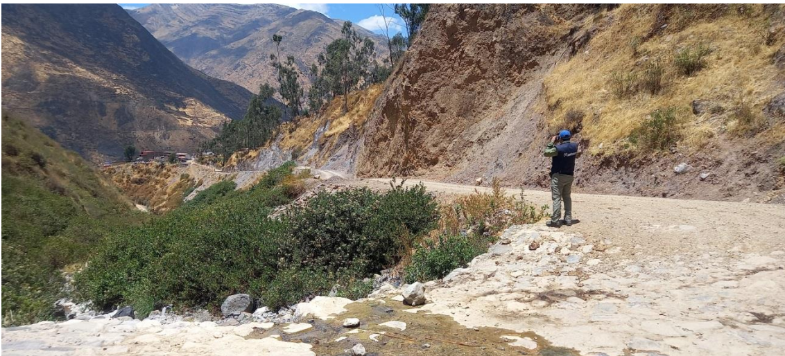
Fotografía 19. Sector Ravira tramo de derrumbes.
