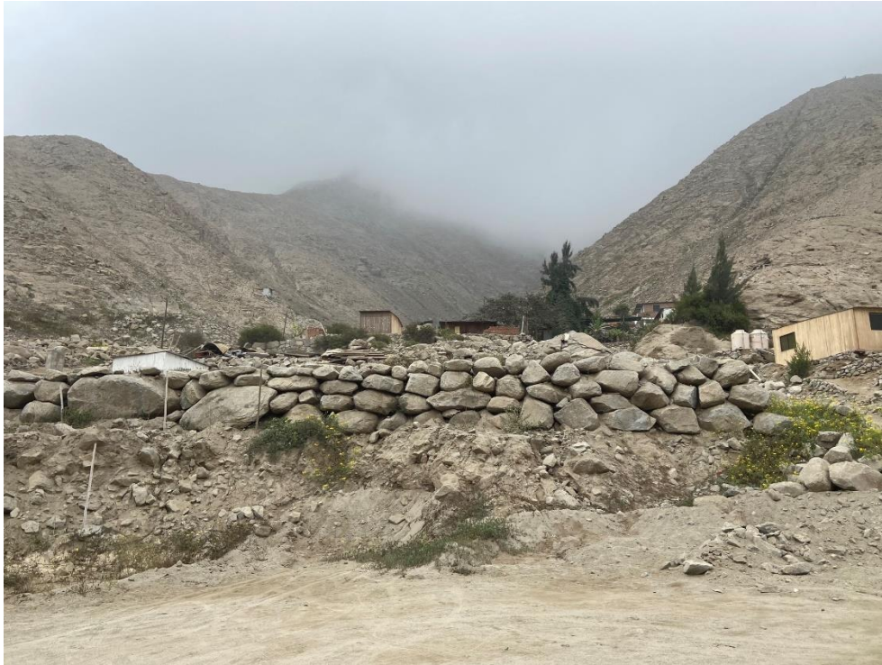
Fotografía 361. Zona crítica 15-261. El sector de Terraza San Martín está asentado sobre el cauce de la torrentera proveniente del cerro California, siendo expuesto a peligros como flujo de detritos y erosión de laderas. Coordenadas UTM 315276E/8669752N, zona 18S. Tomado el 09/09/2023.
