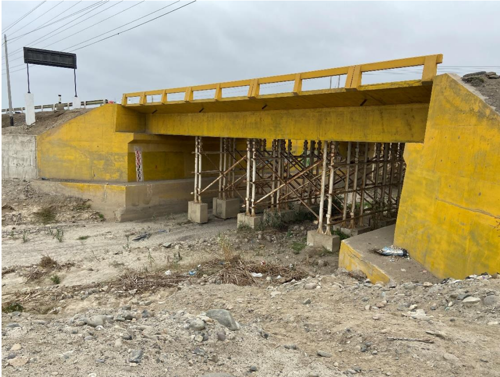
Fotografía 347. Zona crítica 15-222. Quebrada Rio Grande, propensa a flujos de detritos que podrían afectar al Puente Asia y Carretera Panamericana Sur, distrito Asia. Coordenadas UTM 330256E/8585459N, zona 18S. Tomado el 02/09/2023.
