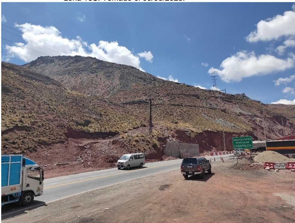
Fotografía 362. Zona crítica 15-262. Peligro por derrumbes en la Carretera Central km122+00 al km129+00, distrito Chicla. Coordenadas UTM 368046E/8715995N, zona 18S. Tomado el 10/09/2023.
