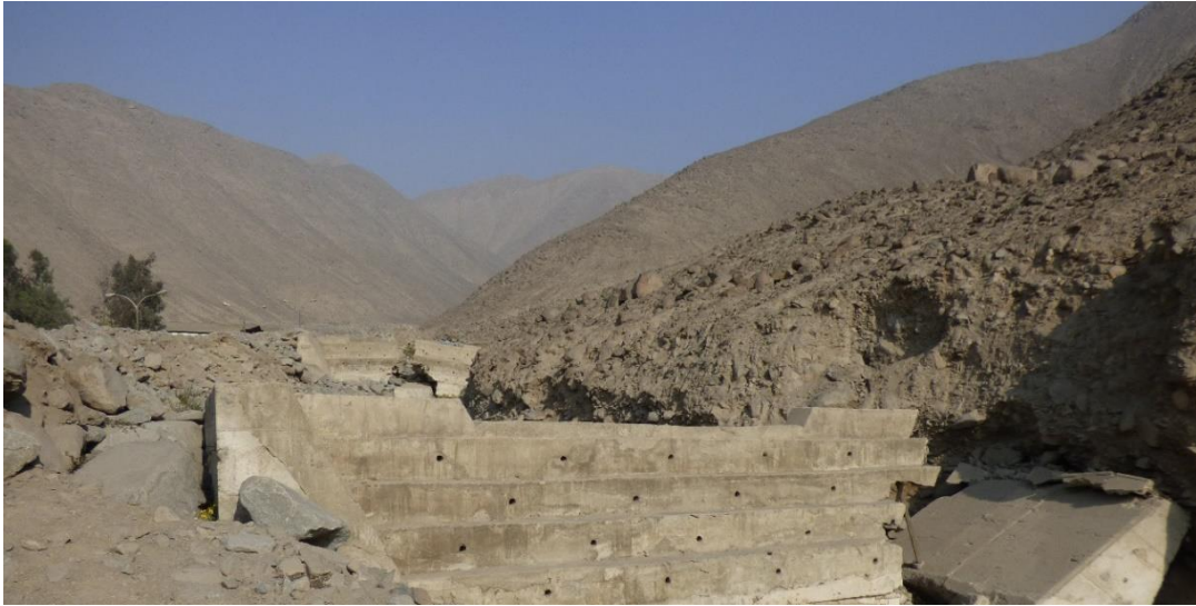
Fotografía 52. Relieve montañoso en roca intrusiva en la quebrada Cusipata en el distrito de Chaclacayo. Se observa un dique destruido por un flujo de detritos producido en 2023 a causa de las lluvias por el fenómeno Yaku.
