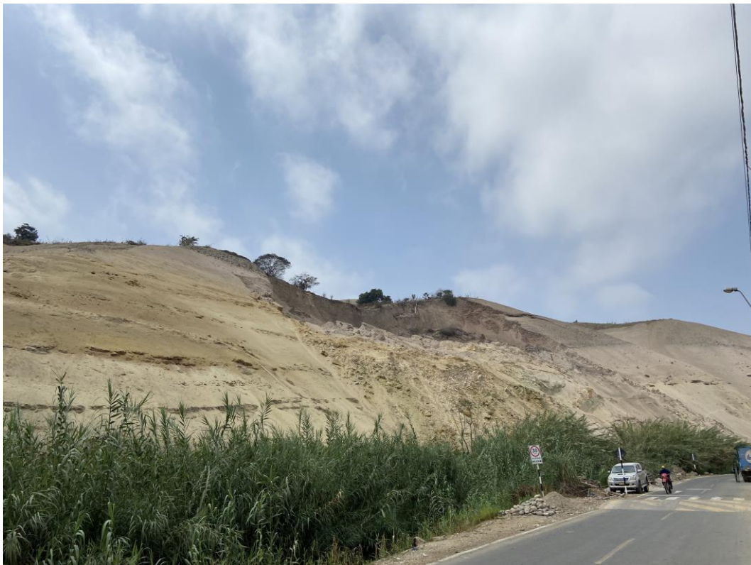
Fotografía 16. Depósitos eólicos en el que se desarrolla el deslizamiento de Montejato, San Vicente de Cañete.
