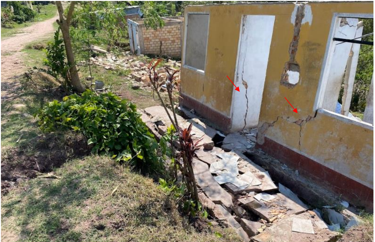
Figura 21: Viviendas del programa Techo Propio, afectada severamente, declarada inhabitable.
