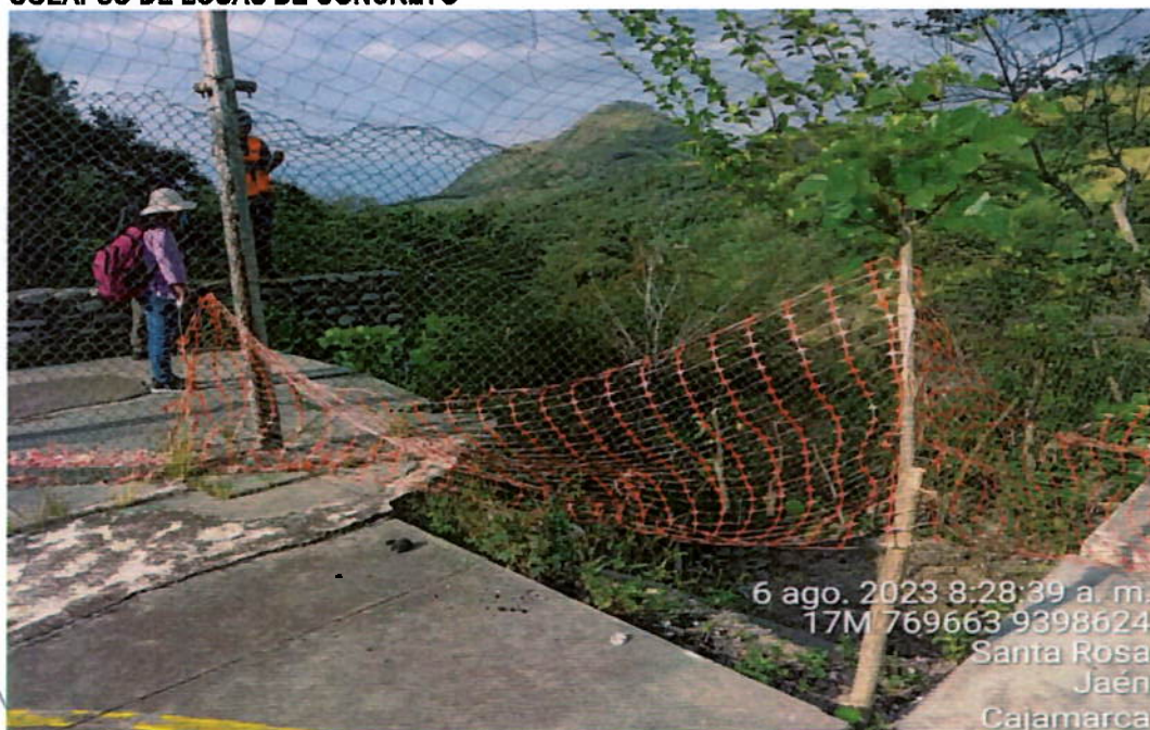
FIGURA 15. DESLIZAMIENTO RECONOCIDO EN LA PARTE POSTERIOR DEL COLEGIO N° 1617 3 SANTA ROSA COMO EVIDENCIA SE HAN IDENTIFICADO GRIETAS EN SUELO, MUROS Y COLAPSO DE LOSAS DE CONCRETO
