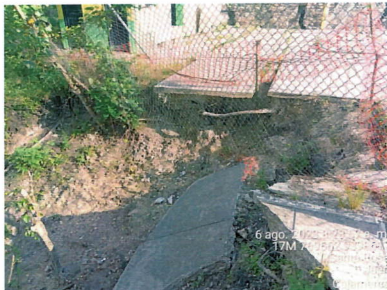
DESGLIZAMIENTO IDENTIFICADO EN LA PARTE POSTERIOR DE I.E. N° 16173 SANTA ROSA QUE GENERÓ EL COLAPSO DE LOSAS DE CONCRETO DE LA INFRAESTRUCTURA EDUCATIVA
