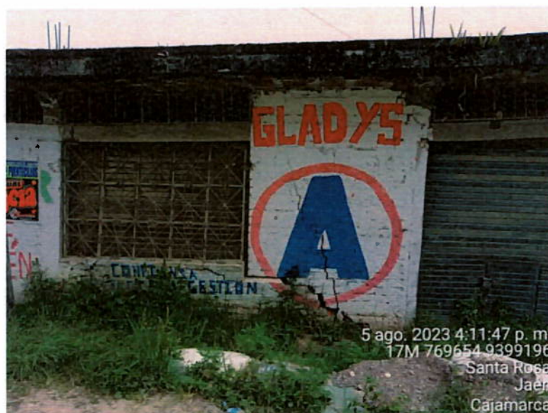
GRIETAS EN PAREDES DE VIVIENDAS COMO EVIDENCIA DEL EVENTO REPTACIÓN DE SUELOS EN EL EXTREMO NORTE DE SANTA ROSA
