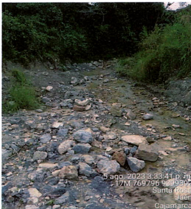
FIGURA 18. CAUCE DE LA QUEBRADA TOMAQUE SUCEPTIBLE A LA OCURRENCIA DE FLUJO DE DETRITOS DURANTE LA OCURRENCIA DE PRECIPITACIONES INTENSAS
