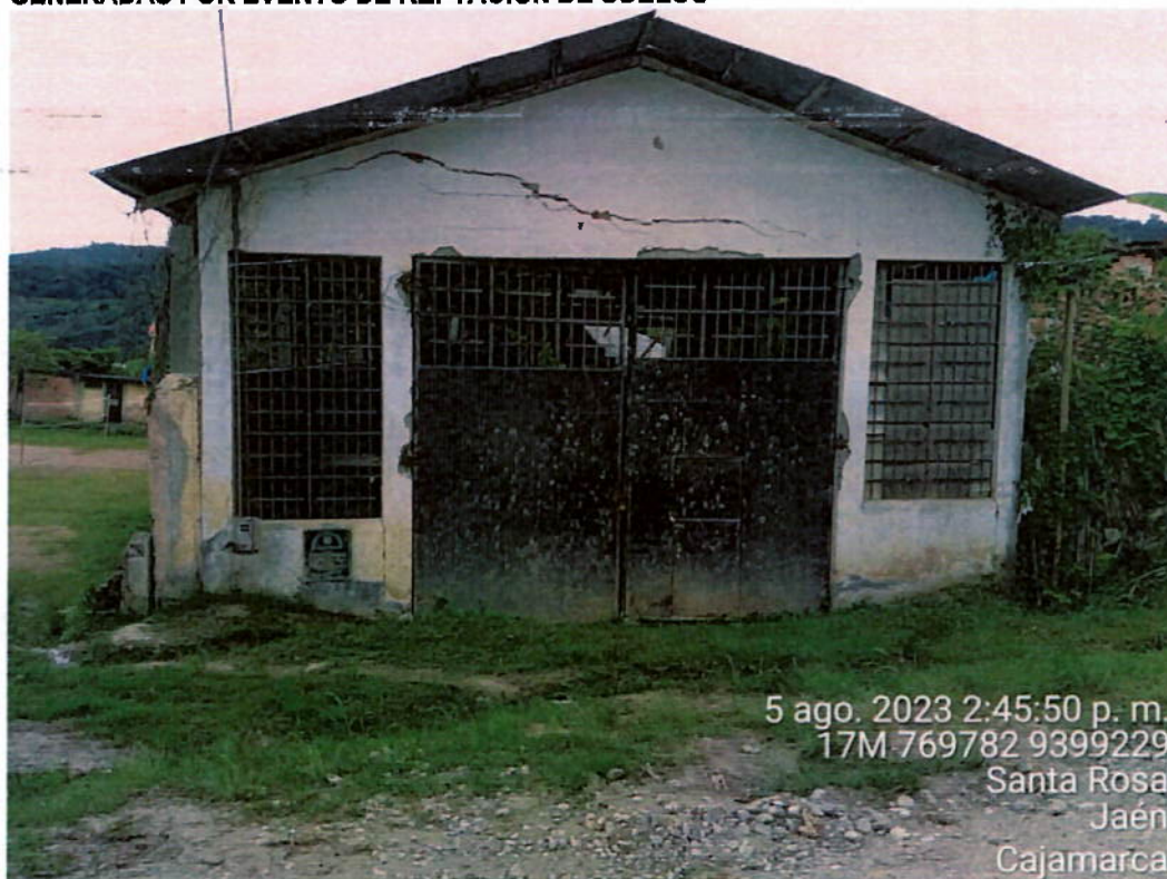
FIGURA 19. GRIETAS EN LAS PAREDES DE ALMÁCEN DE LA MUNICIPALIDAD DE SANTA ROSA GENERADAS POR EVENTO DE REPTACIÓN DE SUELOS
