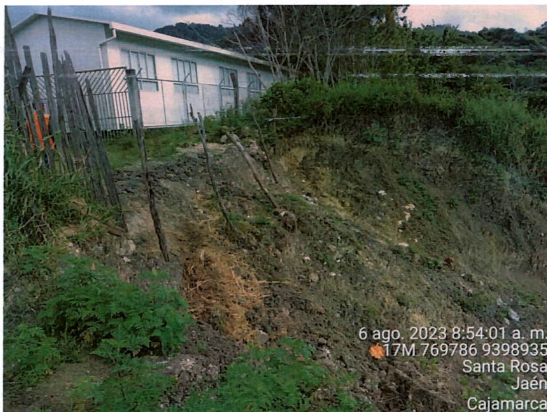
FIGURA 13. DESLIZAMIENTO EN LOS LÍMITES SITUADOS EN LA PARTE POSTERIOR DEL COLEGIO CIRO ALEGRÍA
