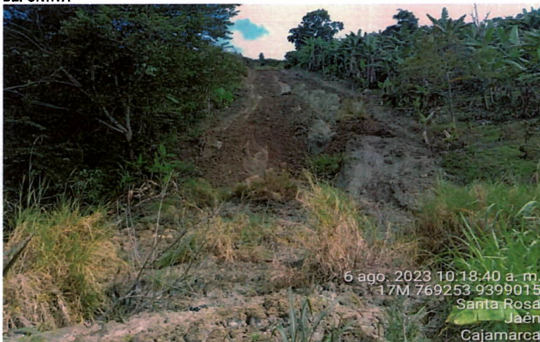
FIGURA 14. DESLIZAMIENTO IDENTIFICADO EN EL EXTREMO NOROCCIDENTAL DEL CAMPO DEPORTIVO DE SANTA ROSA CUYOS MATERIALES HAN CUBIERTO PARTE DE LA CANCHA DEPORTIVA
