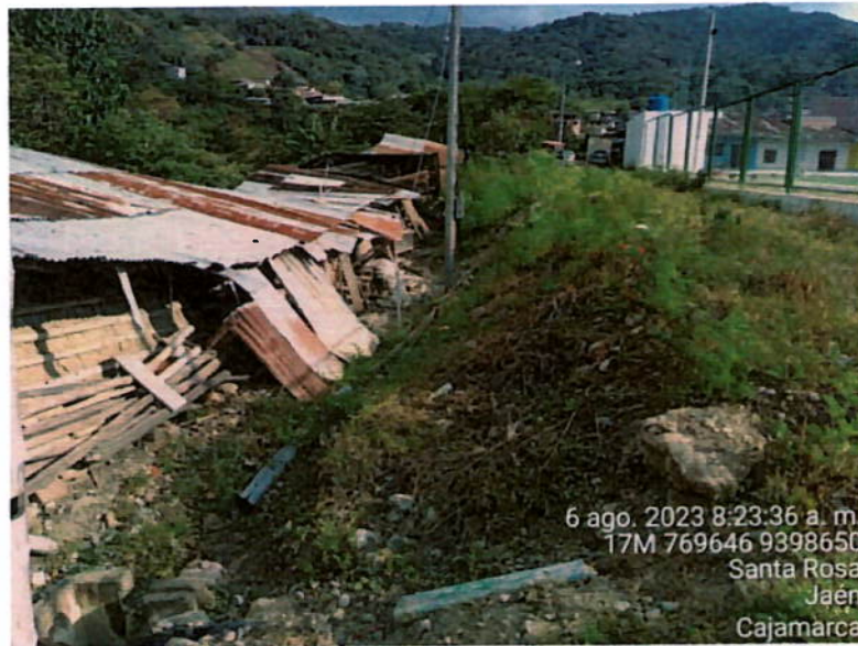
VIVIENDAS INHABITABLES EN LA PARTE BAJA DE PLATA FORMA DEPORTIVA SITUADA AL COSTADO DE INSTITUCIÓN EDUCAVITA 16173 SANTA ROSA DEBIDO A INFILTRACIÓN DE AGUA EN EL SUBSUELO Y CERCANÍA A ACANTILADOS
