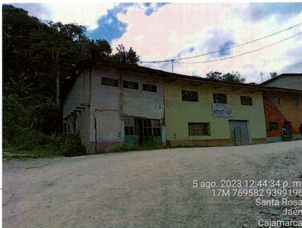
FIGURA 20. GRIETAS EN PAREDES DE VIVIENDAS DEBIDO AL EVENTO REPTACIÓN DE SUELOS
