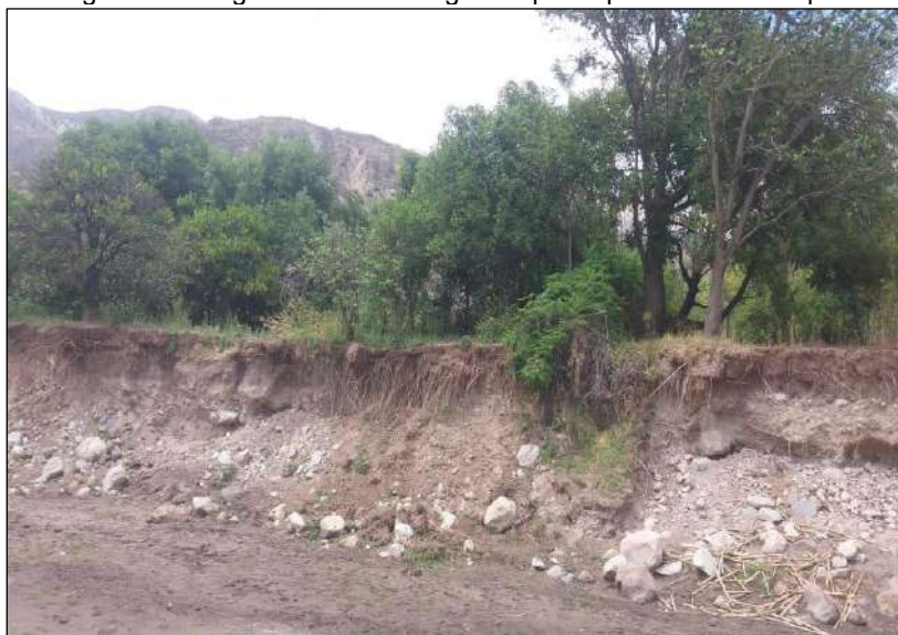
Figura 04. Imagen de erosión originado por el paso del río Pampas.
