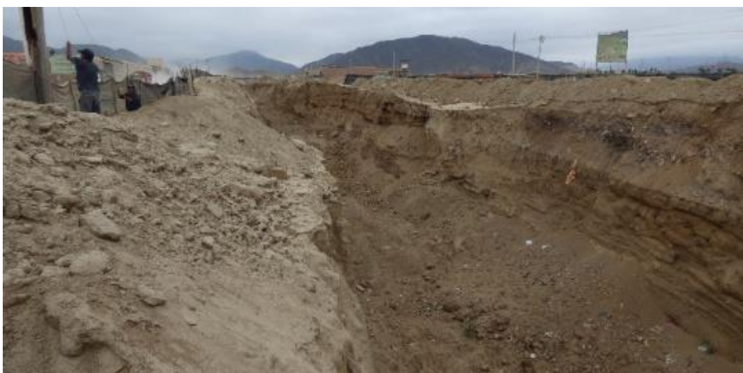
Fotografía 5. Aguas arriba del puente colgante, se observa el cauce en proceso de limpieza, por este sector se produjo un desborde, el flujo discurrió por la Av. Pampapacta, afectando algunas viviendas.
