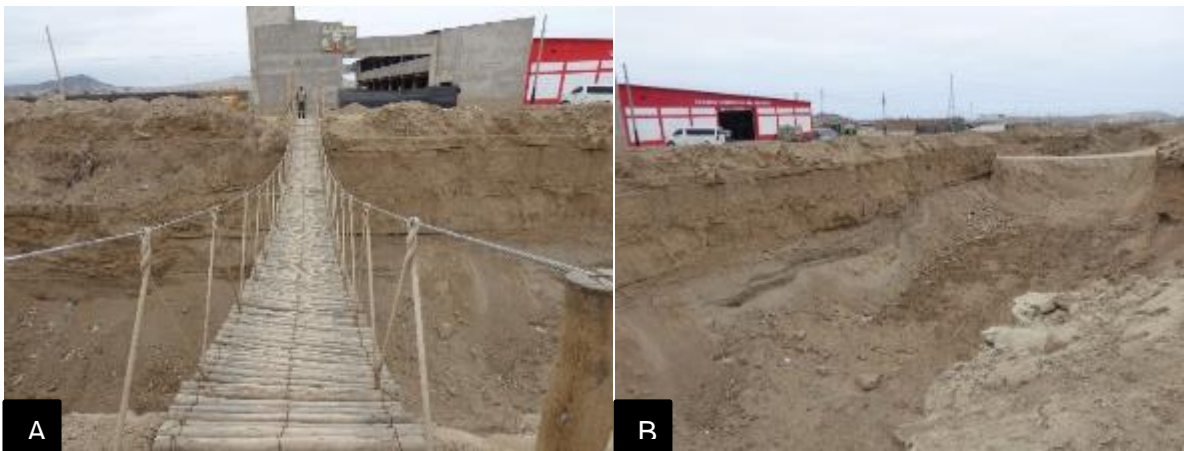
Fotografía 4. A. Puente colgante de 18 m de longitud y una altura 6 m de afectado durante el paso del flujo de lodo en marzo del 2023, a 10 m agua arriba se produjo un desborde que discurrió por la vía de acceso. B. Aguas abajo del puente, se observa el cauce en proceso de limpieza y una vía alterna que cruza el cauce, obstruyendo la quebrada.
