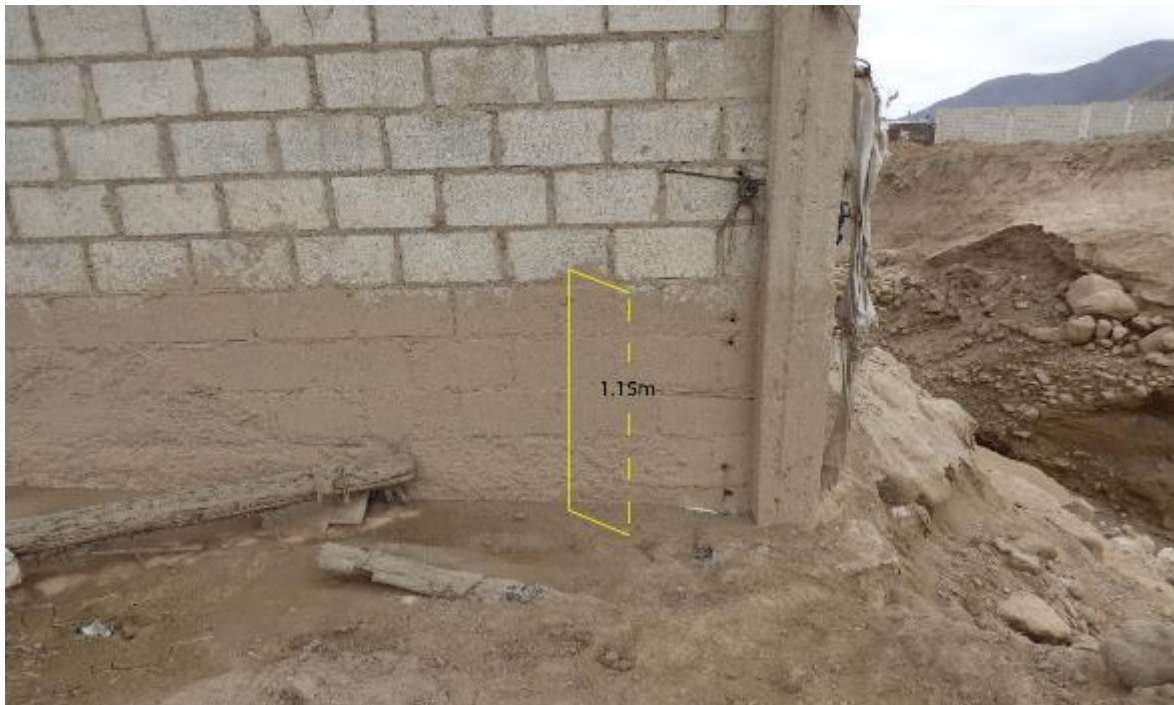
Figura 15. Muro de la granja avícola Malanche, construido en plano cauce, el flujo de marzo del 2023 se obstruyó temporalmente a causa de este muro, provocando desborde en el área y recuperación de su curso con mayor fuerza. Sector Santa Rosa.
