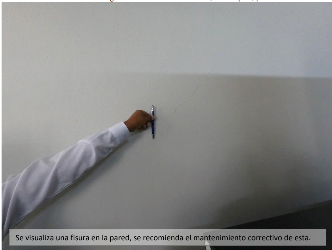
IMAGEN 12—23 : Oficina Regional del INDECOPI de Tacna, cuarto piso, presencia de fisuras
