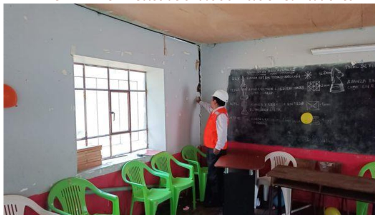
IMAGEN 2—25 : Efectos de ondas sísmicas en edificaciones
