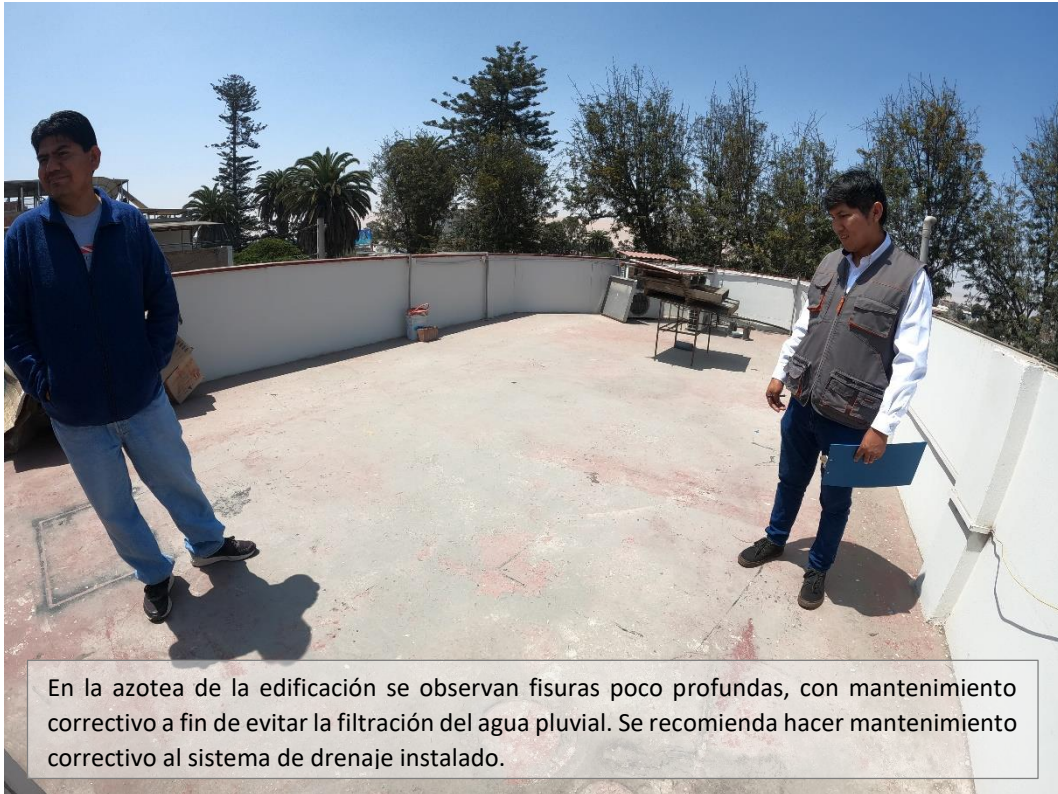
IMAGEN 12—24 : Oficina Regional del INDECOPI de Tacna, azotea, fisuras resanadas
