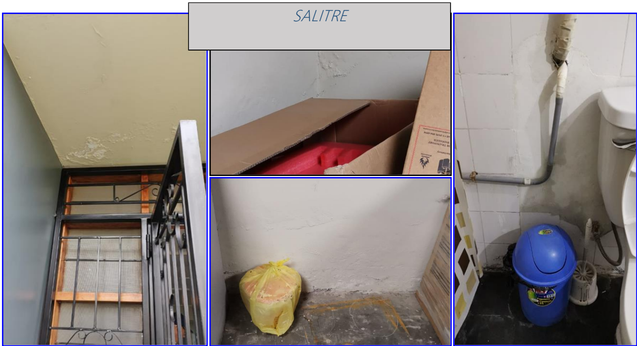
Foto arriba 8-11: Se encontró salitre en paredes en diferentes ambientes, por lo que va a necesitarse de tratamiento para poder lograr una solución duradera de la edificación. Se ha detallado este aspecto en el "Informe de la inspección visual del estado de la edificación" para esta sede Ica.
