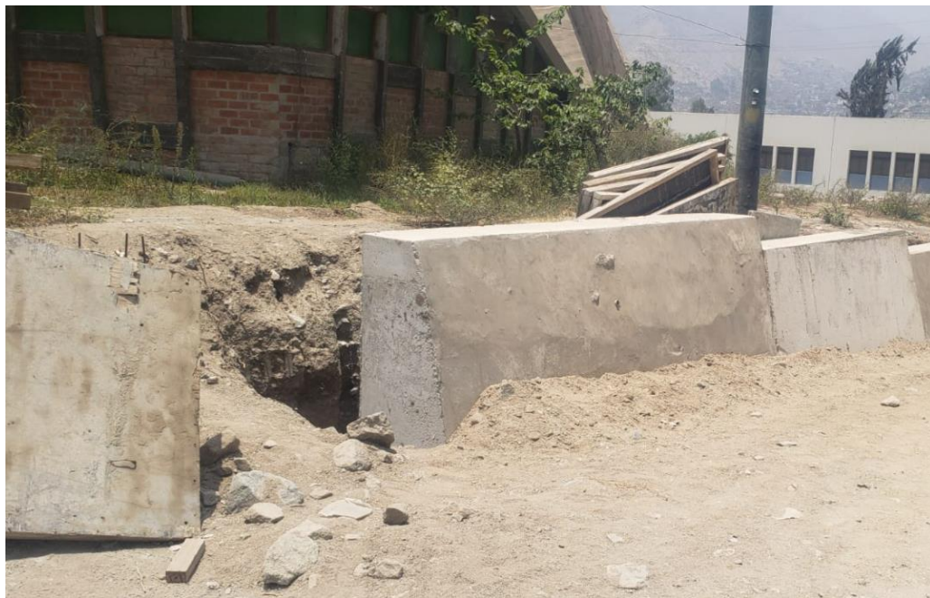
Foto N° 07: Toma fotográfica de las estructuras (muros de contención) para encauzamiento del flujo en caso de activación de la quebrada Cantuta II hacia la puerta principal de la UNE sin mantenimiento en algunos tramos.
