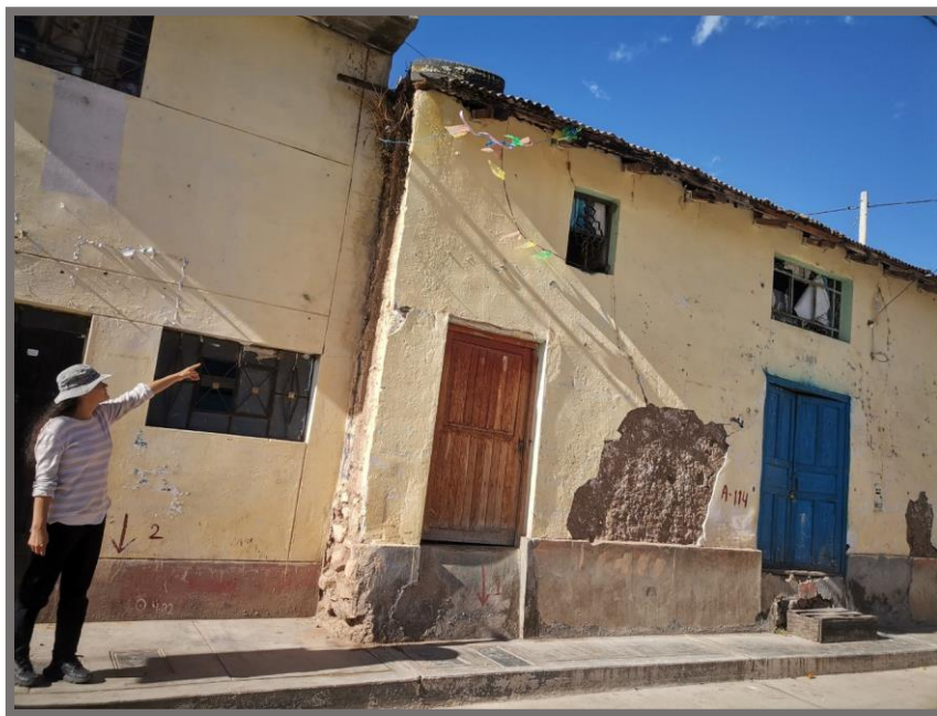
Figura 7: Viviendas abandonadas por daños estructurales
