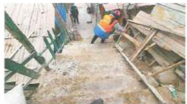
Fotografía N° 5.- Estado Muy Malo de las escaleras de acceso a las partes altas de las manzanas 9 y 10
