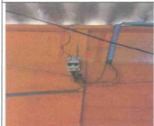
Fotografía N° 5.- Conexiones eléctrica en mal estado
