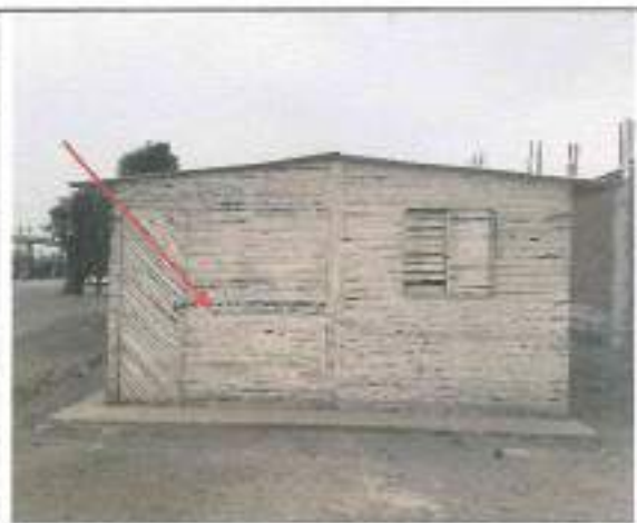
Fotografía N°2.- Lote de madera en mal estado de conservación.
