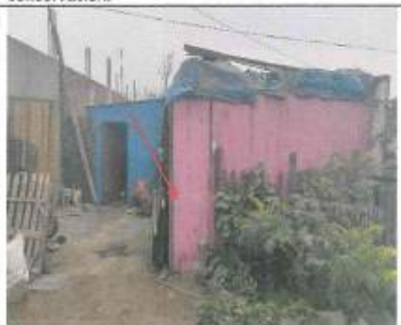
Fotografía N°4.- Lote de madera en mal estado de conservación
