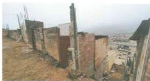
Fotografía N° 4.- Verificación de las condiciones de seguridad física de las viviendas de material precario
