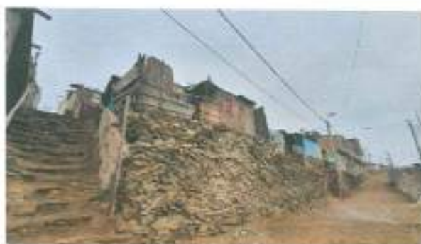
Fotografía N° 5.- Estado Muy Malo de las escaleras de acceso a la Asociación Nueva Esperanza
