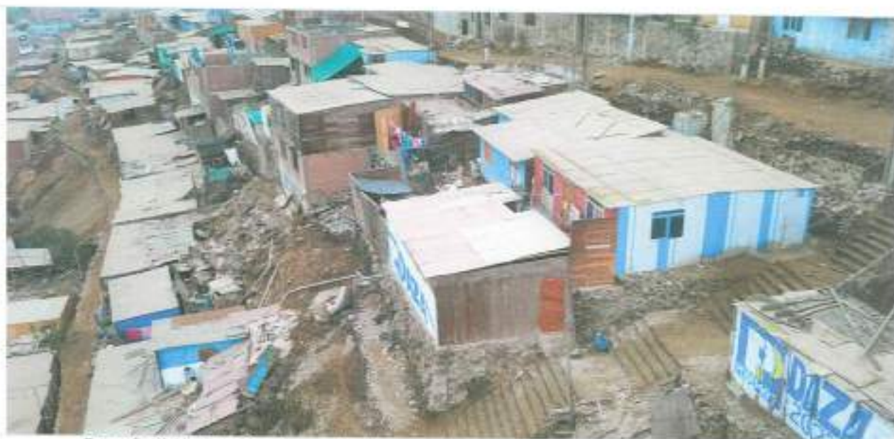
Fotografía N° 11.- Vista aérea de la escalera de acceso colindante a la manzana J , estado de escalera en mal estado
