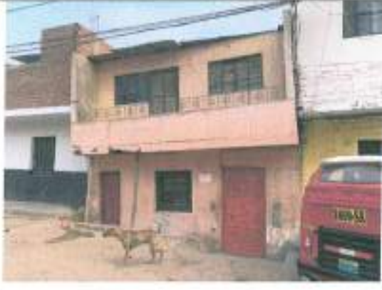
Vivienda con apuntalamiento de madera que sostiene el balcón del segundo nivel.
