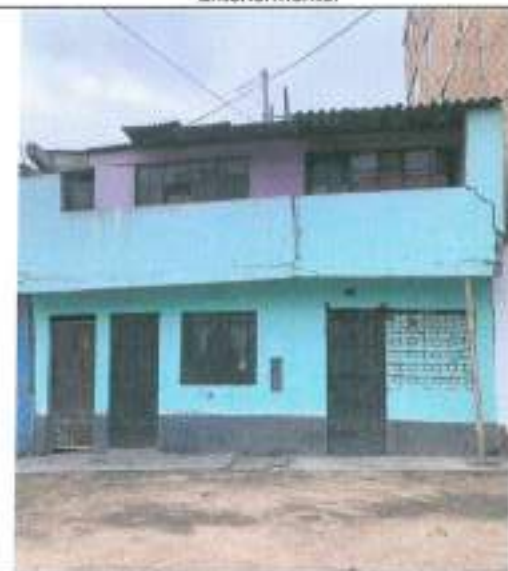
Vivienda con rajaduras en el segundo nivel.
