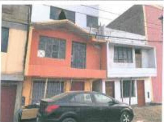
Viviendas con apuntalamiento de madera que se sostienen entre sí.
