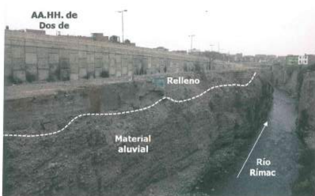
Figura N° 5: presencia de material aluvial en la Margen izquierda del río Rímac cubierto por material de relleno: altura de los AA.HH. 1° de Mayo y Dos de Mayo
