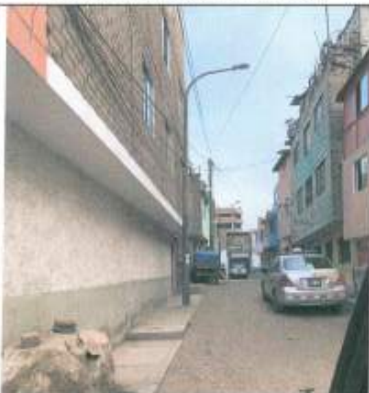
Viviendas con inclinación que se acercan a las redes de alumbrado.
