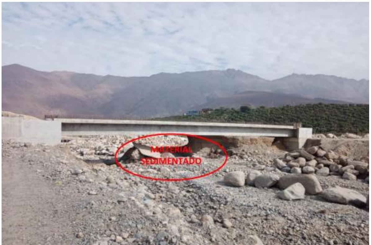
Ilustración 29. Identificación de punto crítico en el sector de Poyor dentro del distrito de Buena Vista Alta
