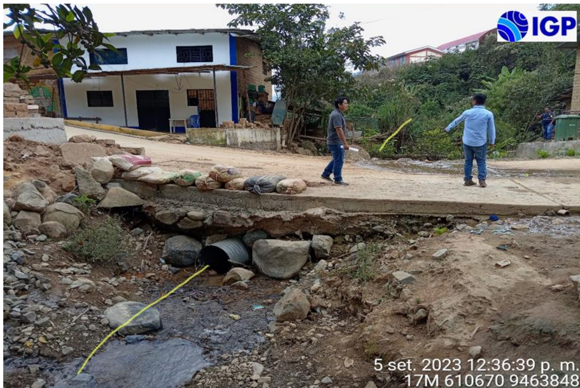
Figura 23.- Quebrada Coletas susceptible a la ocurrencia de flujo de detritos e inundaciones (imagen superior) debido a la activación de la quebrada y la implementación de una alcantarilla en la vía de acceso (imagen inferior) que comúnmente es colmatada que podría afectar viviendas aledañas
