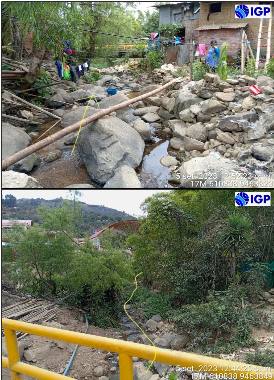
Figura 24.- Quebrada afluyente a Coletas susceptible a flujo de detritos que podría afectar puente y viviendas aledañas, durante el 2021 afectó viviendas (imagen superior) donde alcanzó alturas de 0.50 m y aguas abajo continúa el cauce hacia el lado derecho de institución educativa (14398), imagen inferior.
