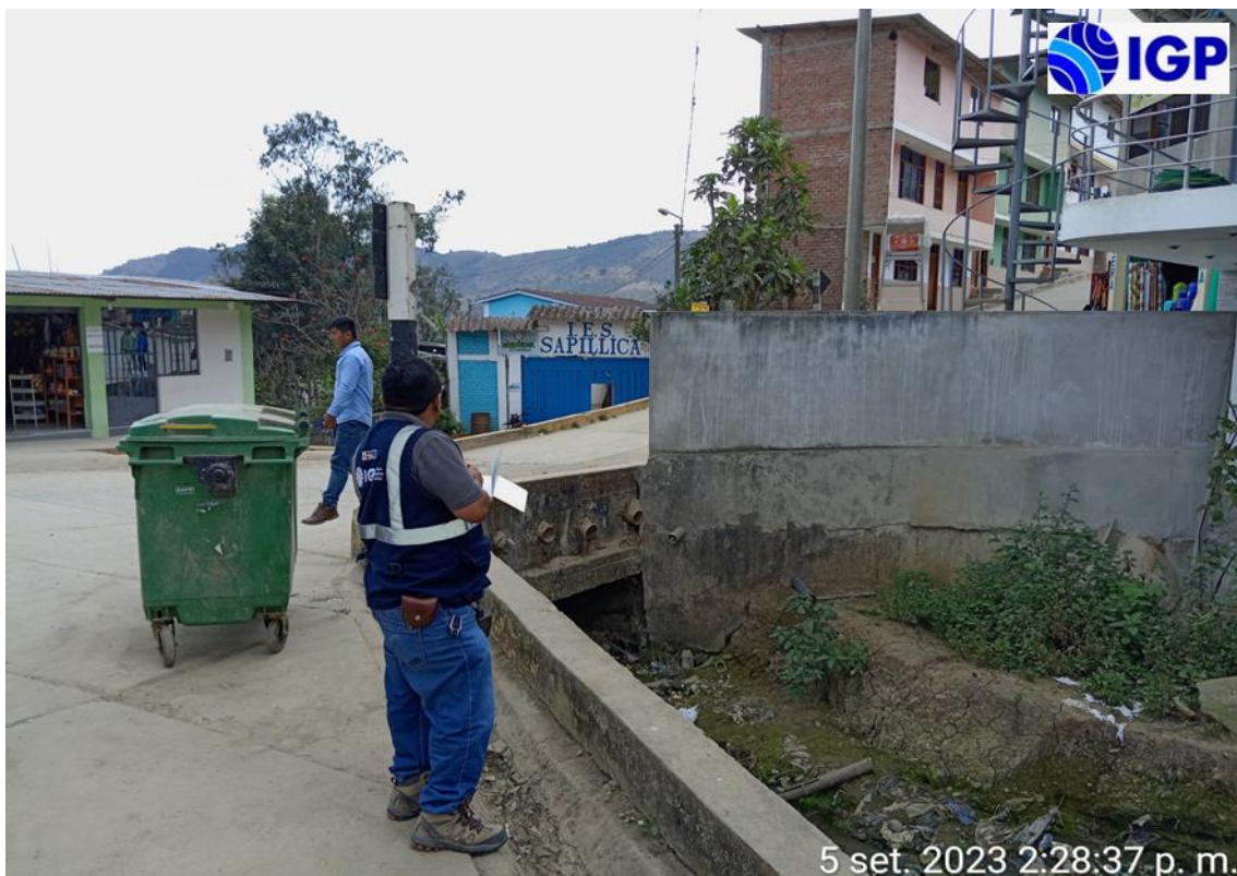
Figura 28.- Cauce de la quebrada Huantur que cruza el área urbana de Sapillica que podría colmatarse y generar flujos que afectarían a la institución educativa Sapillica y al coliseo deportivo
