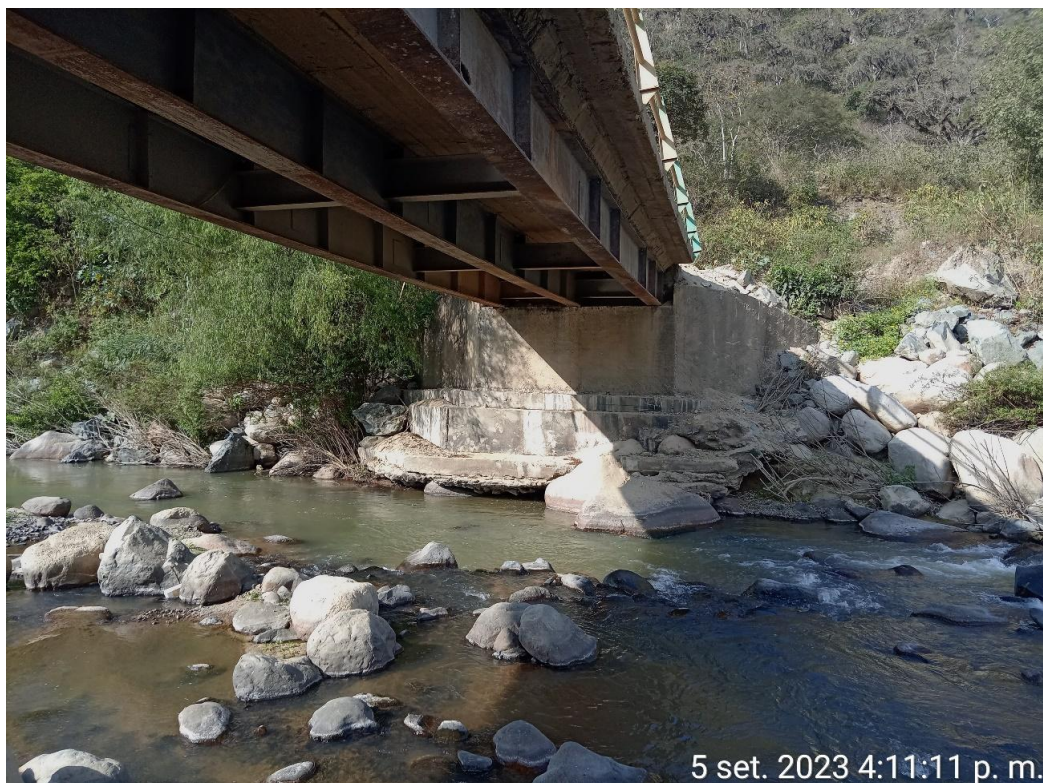
Figura 31.- Erosión fluvial en el cauce del río Timbes Huabal que podría afectar los estribos del puente de accesibilidad
